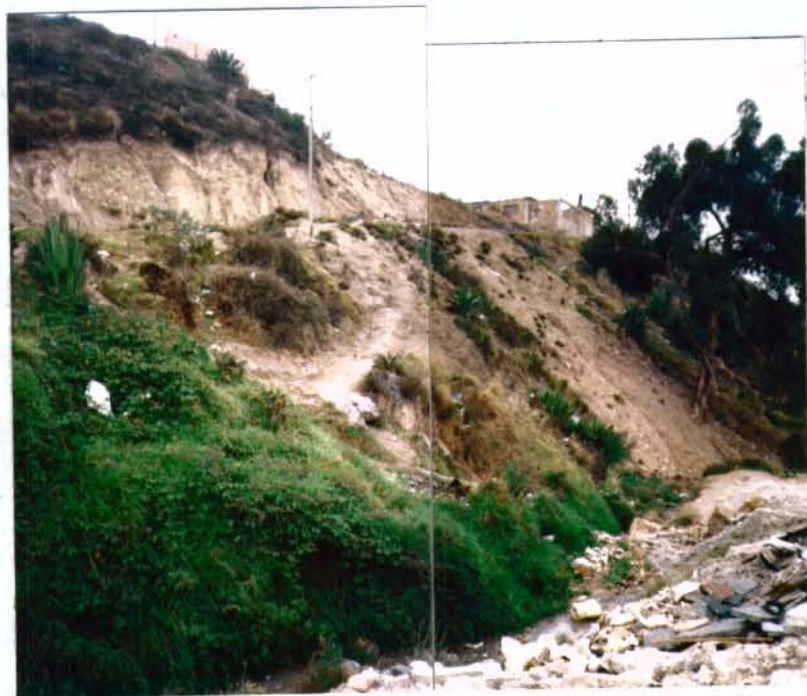
FOTO 32. QUEBRADA SANTA RITA, UBICADA EN EL LÍMITE ORIENTAL DEL BARRIO SAN RAFAEL. EN LA PARTE SUPERIOR, EL ACCESO AL BARRIO, QUE CORTA LA UNIDAD GEOLÓGICA TKGM1 Y QUE LIMITA LA ZONA VIII AL ORIENTE.
