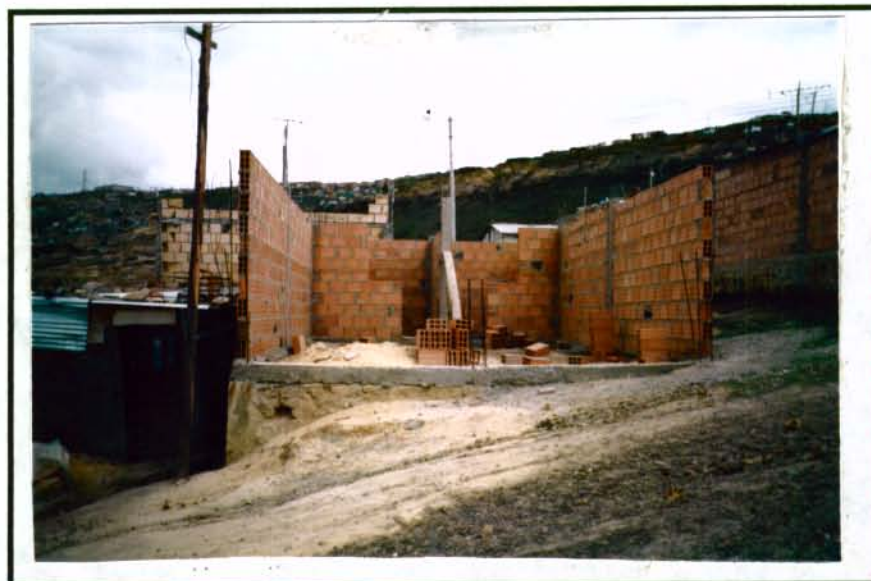
FOTO 15. LAS CASAS A CONSTRUIR SON GENERALMENTE DE DOS PISOS, CON VIGAS Y COLUMNAS EN CONCRETO REFORZADAS CON ACERO Y PAREDES EN TOLETE O LADRILLO PENSADO. OBSÉRVESE A LA DERECHA EL MURO EN ENROCADO.
