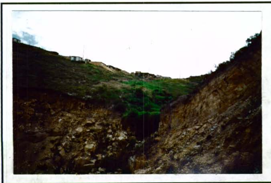
FOTO 29. QUEBRADA SANTA RITA, EN LA PARTE IZQUIERDA DE LA IMAGEN SE NOTA LA ZONA DE SUELO INESTABLE CON FALLA RETROGRESIVA QUE INVOLUCRA SUELOS ARCILLOSOS Y UN NIVEL SUPERIOR DE TURBAS (ZONA V). EN LA PARTE DERECHA, EL FLANCO SUR DEL ANTICLINAL DE SAN RAFAEL, CON ALTO GRADO DE FRACTURAMIENTO DEL MACIZO ROCOSO, SOBRE LA QUE SE DESARROLLA LA LADERA DE LA ZONA VI.
