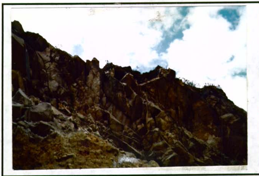
FOTO 12. VOLADIZOS Y CUÑAS PRESENTES EN EL ESCARPE CORRESPONDIENTE A LA ZONA GEOTÉCNICA IA. ESTAS ZONAS DEBEN SER REMOVIDAS PARA EVITAR LA CAÍDA DE BLOQUES.
