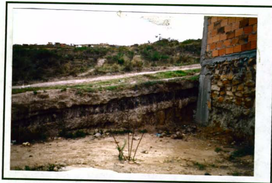
FOTO 6. PERFIL DE SUELOS TÍPICO DEL BARRIO SAN RAFAEL. EL HORIZONTE SUPERIOR ES UN SUELO ARENOSO, POROSO Y PERMEABLE; EL HORIZONTE INTERMEDIO ES UNA CAPA DE TURBA, MUY PLÁSTICA Y SATURABLE, ES DECIR, UN MATERIAL PROBLEMÁTICO DESDE EL PUNTO DE VISTA GEOTÉCNICO. EL HORIZONTE INFERIOR ES EL DE TRANSICIÓN SUELO-ROCA. NÓTESE QUE LAS CIMENTACIONES (TANTO DE LA CASA CONSTRUIDA COMO LA QUE SE VA A CONSTRUIR) SE ENCUENTRAN POR DEBAJO DEL NIVEL PROBLEMÁTICO (ZONA VIIA).
