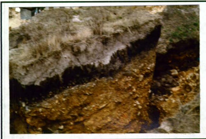
FOTO 27. DETALLE DEL MATERIAL AFECTADO POR EL FENÓMENO DE REMOCIÓN EN MASA DE LA ZONA IVB.
