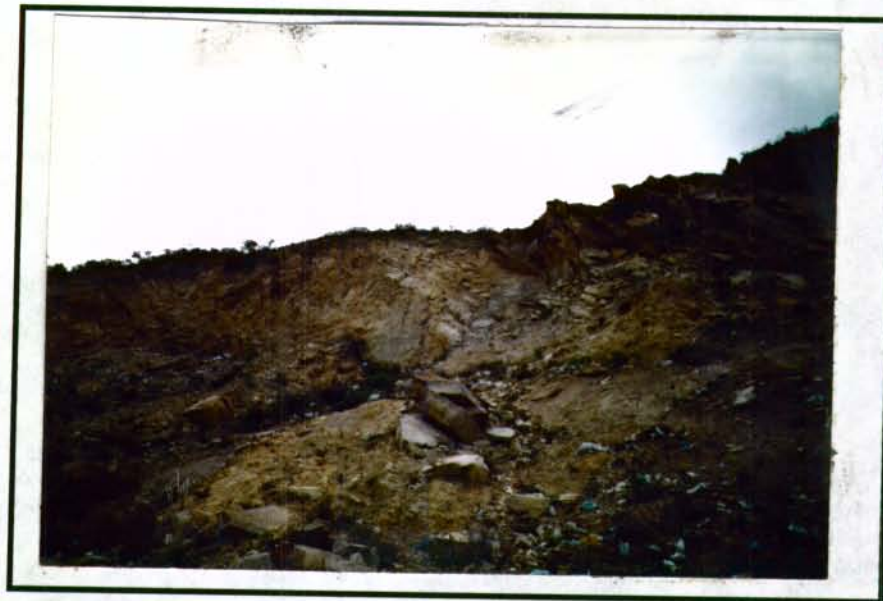
FOTO 5. DEPÓSITOS DE TALUS EN LA PARTE INFERIOR. EN LA PARTE SUPERIOR NÓTESE EL PROCESO QUE OCURRE EN EL ESCARPE PARALELO A LA MANZANA K: SE OBSERVAN PEQUEÑAS MASAS EN VOLADIZO, CUÑAS Y FALLAS PLANARES EN LA PARTE SUPERIOR Y LA CAÍDA DE BLOQUES Y DETRITOS.
