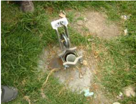
Fotografía 8-5 Inclinómetro en la perforación S-5
