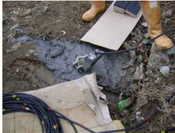
Fotografía 8-6 Inclinómetro en la perforación S-6
