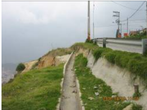
Fotografía 5. Vista del estado actual de la cuneta atrás de la corona del talud cerca de la pantalla.
