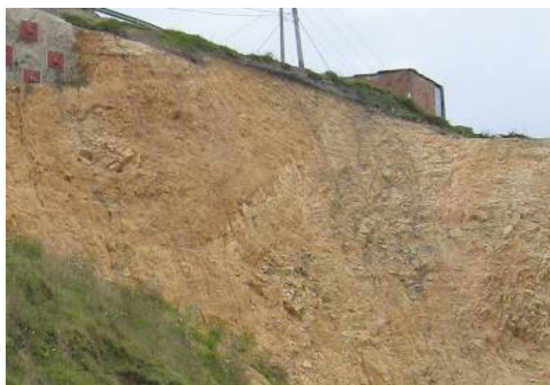
Fotografía 11 . Vista de una zona de brechamiento en el sitio de estudio, nótase la orientación caótica de los fragmentos rocosos.
