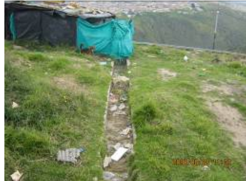
Fotografía 6. Presencia de acumulación de sedimentos y basuras dentro de la cuneta que obstruyen el libre drenaje.
