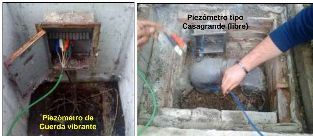
Fotografía 14. Verificación del estado de los piezómetros – Universidad Agraria.
