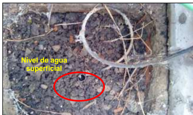
Fotografía 15. Detalle de piezómetro libre posiblemente dañado – Universidad Agraria.
