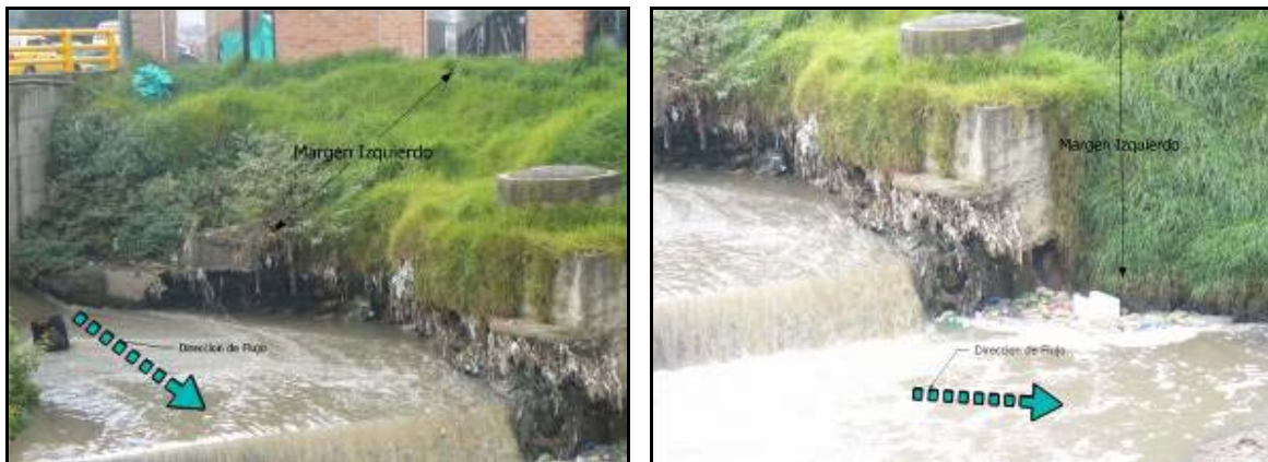
Fotografías No. 1 y 2. Acción de socavación lateral sobre la margen izquierda de la Quebrada Chiguaza
