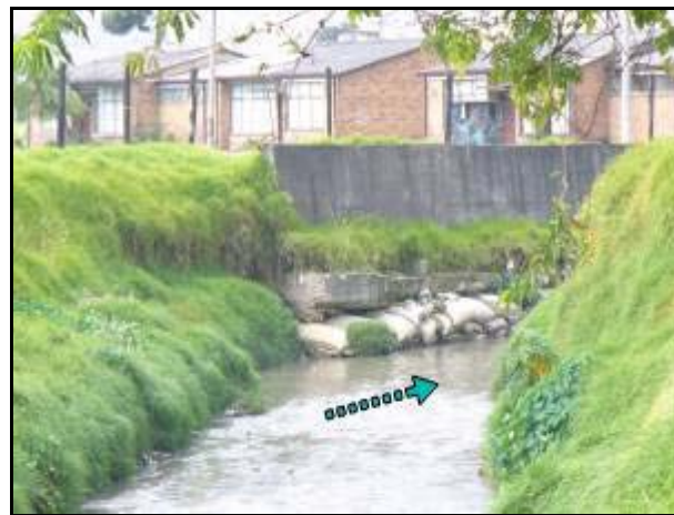
Fotografía No. 12. Proceso de socavación lateral por la concentración de energía hidráulica sobre el soporte del muro en concreto
