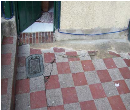
Foto No. 13 Daños en acceso a la vivienda.
