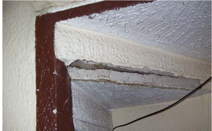
Foto No. 19 Fisuras en zonas de escaleras y desprendimientos.
