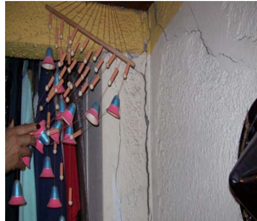
Foto No. 21 Fisuras en muros interiores, cerca de elementos estructurales.
