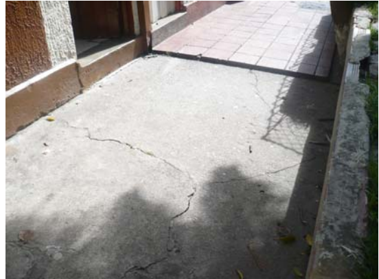
Foto No. 18 Fisuras en andén.
