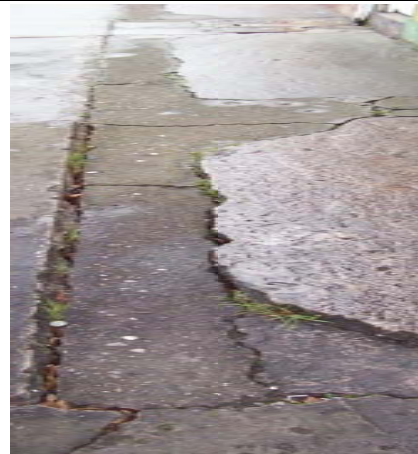
Foto No. 27 Daños en andenes
