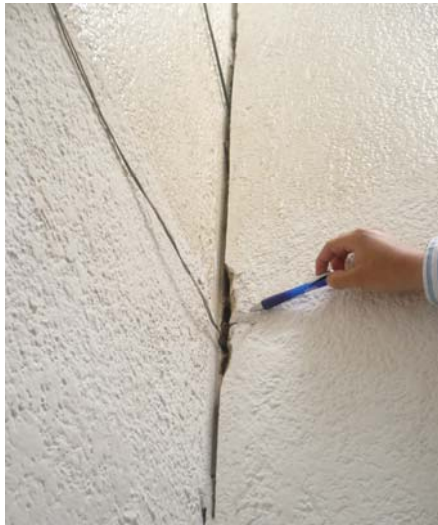
Foto No. 19 Fisura entre muros laterales y divisorios.
