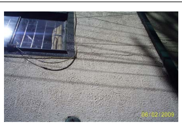
Foto No. 39 Fisuras en fachada.
