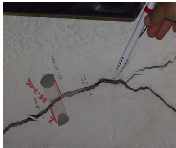
Foto No. 20 Testigo muestra una fisura sobre muros de carga.
