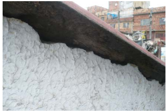
Foto No. 33 Separación de muros y cubierta.
