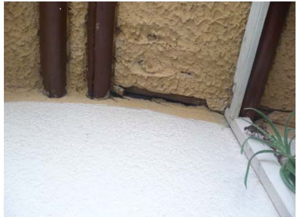
Foto No. 24 Caída de mortero de la cubierta.
