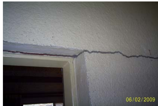
Foto No. 36 Fisuras en muro.
