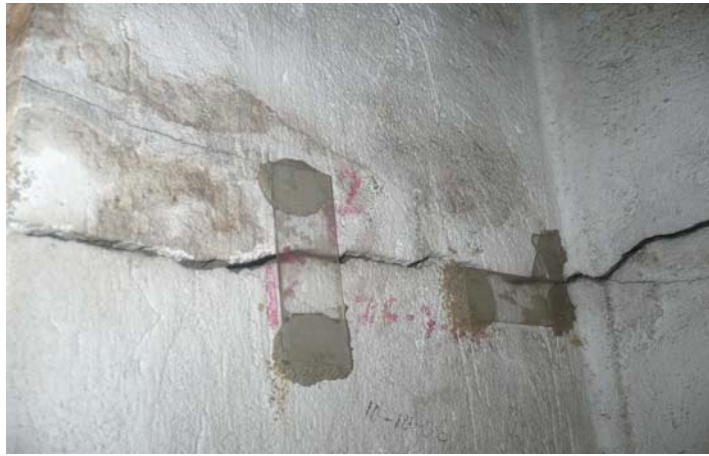
Foto No. 31 Muro con daño severo.
