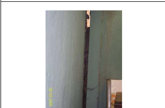
Foto No. 35 Separación en muros ortogonales.
