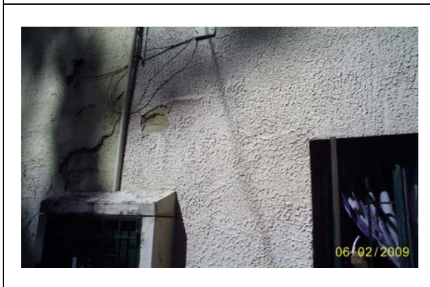
Foto No. 38 Desprendimiento de material en fachada.
