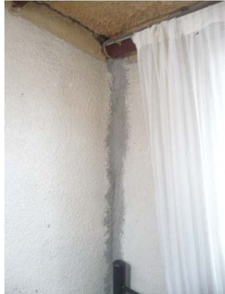
Foto No. 22 Fisura resanada entre culata y muros laterales.
