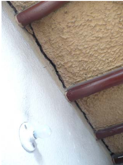
Foto No. 23 Fisura entre muro lateral y cubierta.
