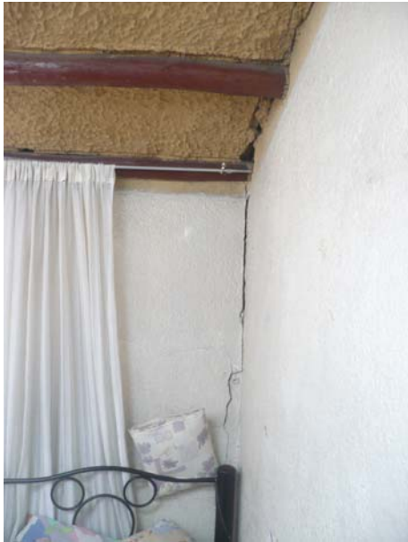
Foto No. 21 Fisuras entre culata, cubierta y muros laterales
