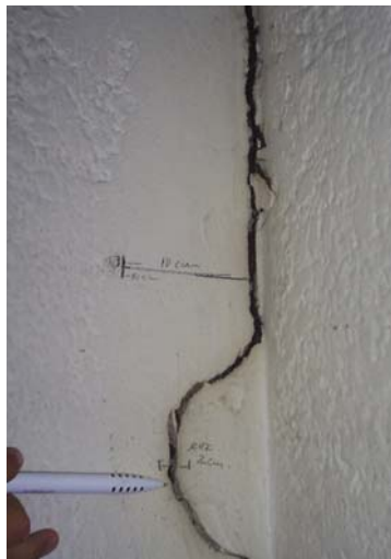
Foto No. 11 Agrietamiento vertical entre muros.
