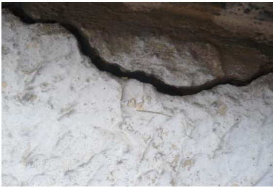
Foto No. 32 Daños a nivel de cubierta.
