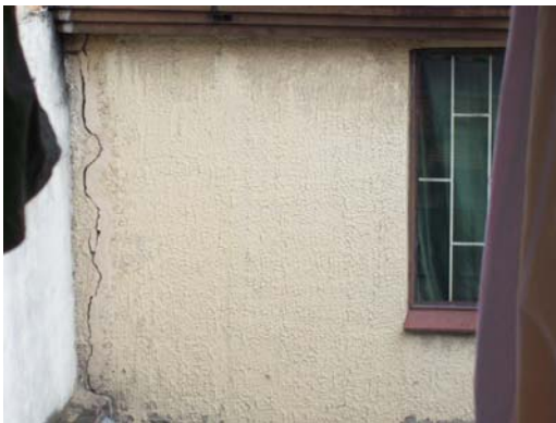
Foto No. 29 Fisuras en muro interior.
