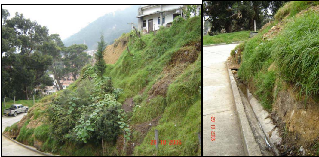
Fotografías 4 y 5: Parte sur del talud cubierta por rellenos. Se notan algunas deformaciones laterales que pueden afectar la cuneta inferior.
