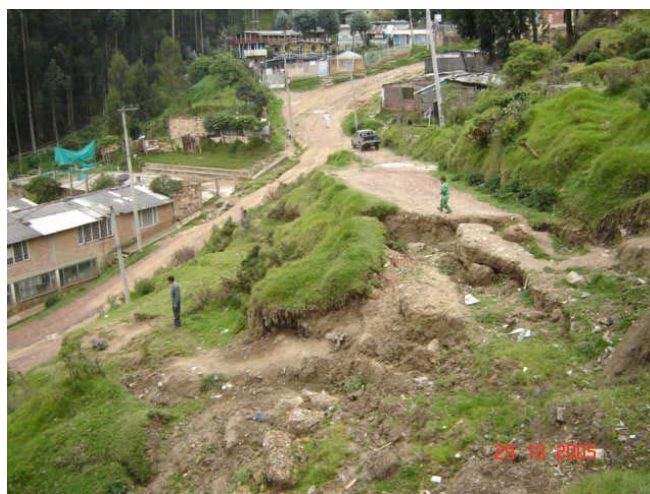
Fotografía 6 Vista general de la zona inestable en el Barrio El Manantial
