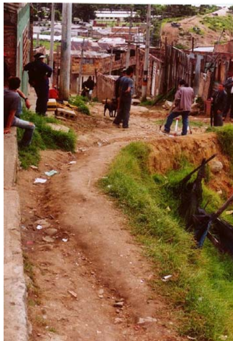
Fotografía 16. La berma peatonal existente entre las casas y la corona del talud, se viene reduciendo a causa de los desprendimientos.
