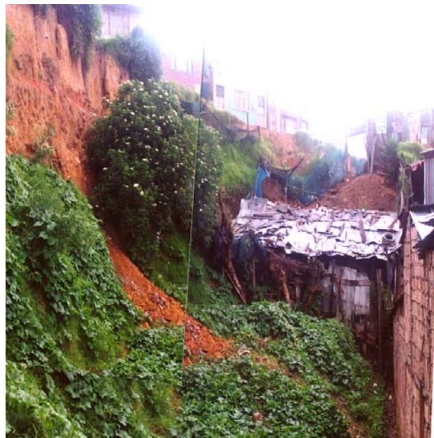
Fotografía 15. Talud verticalizado de 8m de altura, desprovisto de vegetación, se ven recientes desprendimientos en la parte baja del talud.
