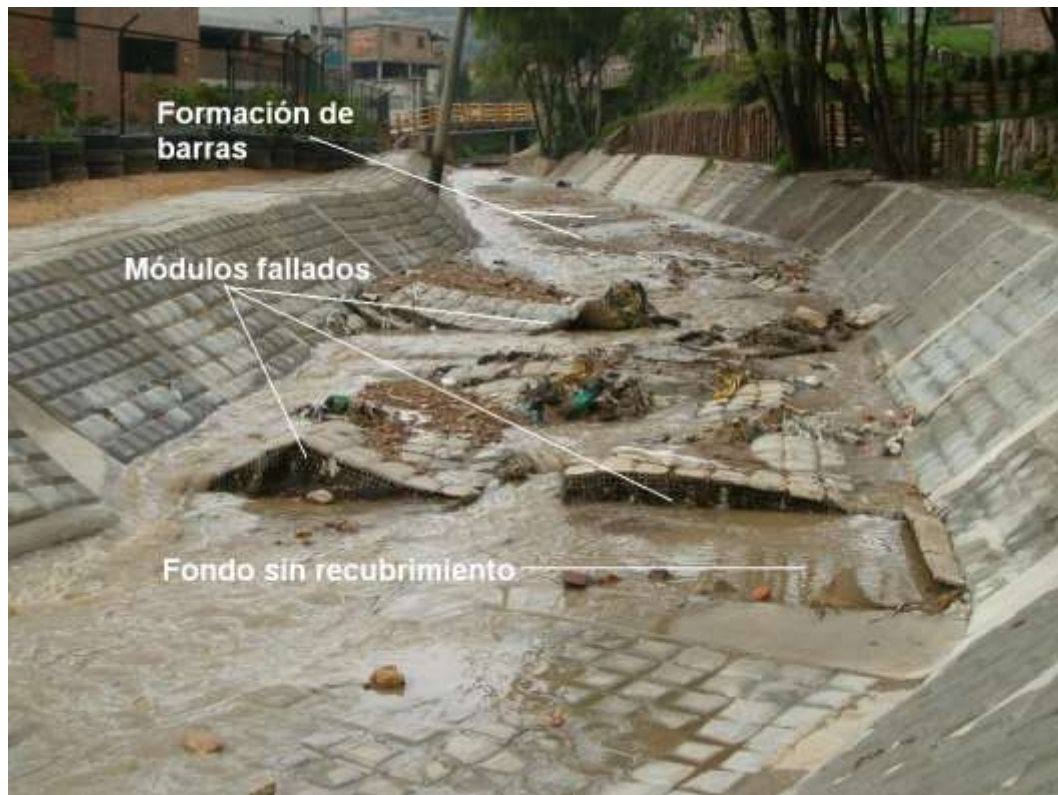
Foto 2: Falla de fondo de la protección del cauce con flexoadoquín (Barrio San Francisco, cauce de la Quebrada Limas - Ciudad Bolívar)
