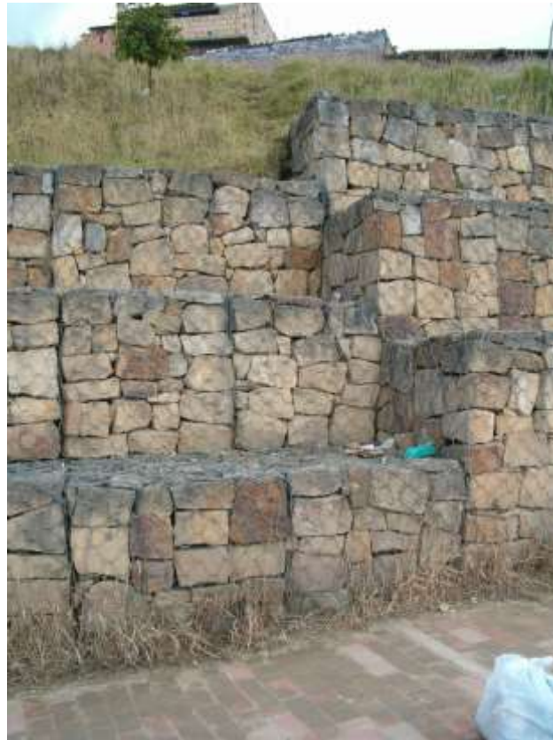
Foto 10: Entrabamiento inadecuado de gavión
