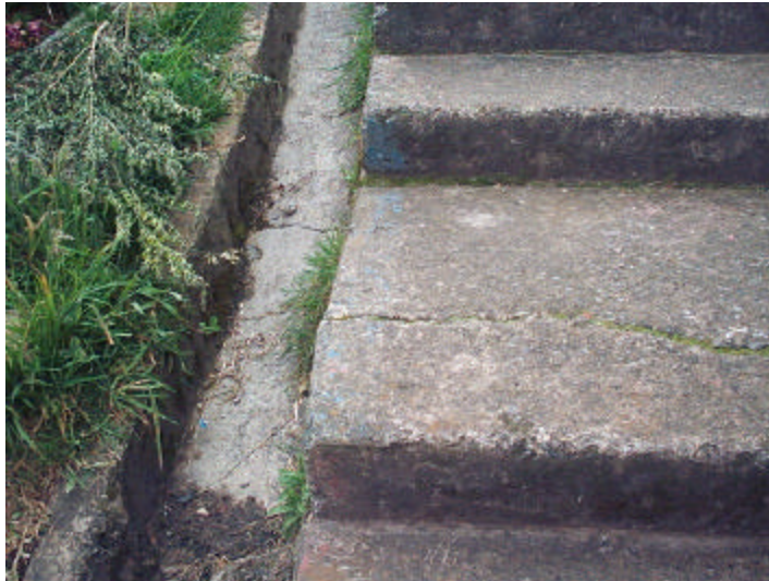
Fotografía No. 9. Fisuras en un andén escalera y cuneta de la calle 42 Sur
