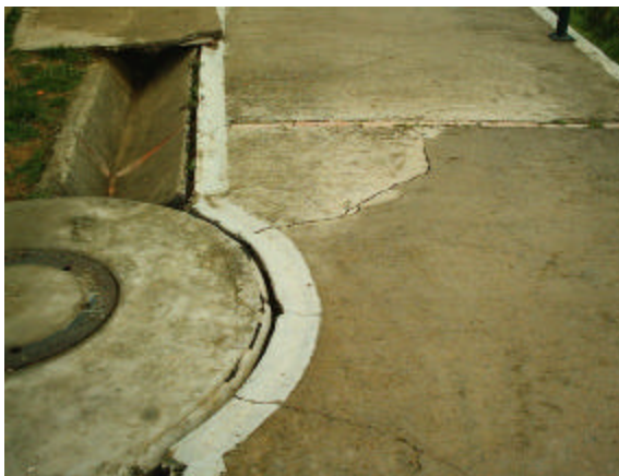
Fotografía 2 Grietas de Tracción y dilatación con la cuneta en el trasdós del Muro
