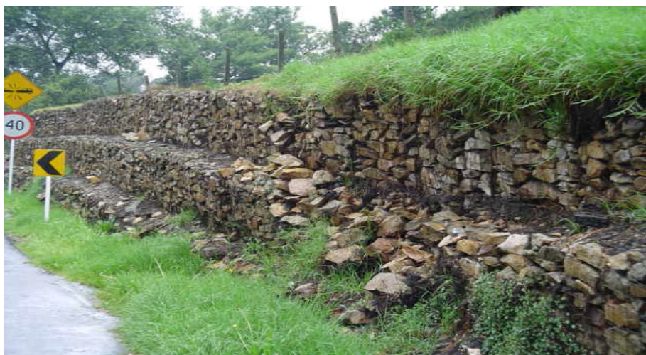
Fotografía No. 2. Muro en gaviones deformado y dislocado. La malla se encuentra en mal estado y permite la fuga de fragmentos líticos. (Fotografía del Ing. Orlando Hoyos, DPAE).
