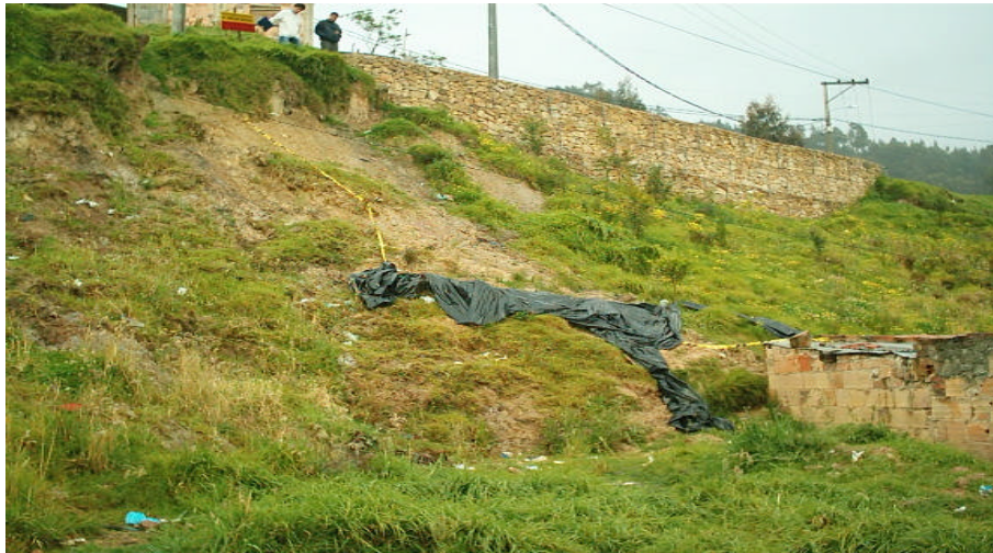
Fotografía No. 1. Se observan flujos de tierra en los depósitos antrópicos, que dejan expuesta la roca a procesos de meteorización.
