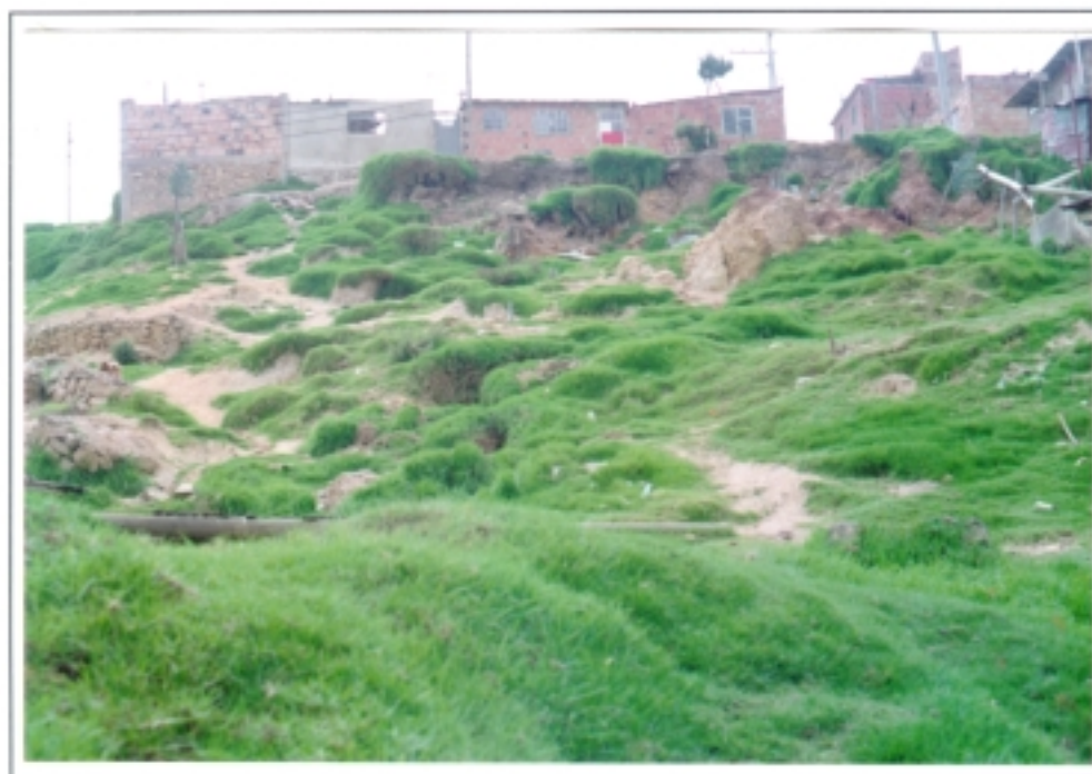
ROLLO 9044 Barrio Nueva Colombia FOTO 16 Edificaciones al borde de la quebrada y sobre material inestable Muros de contención. Fenómeno de reptación
