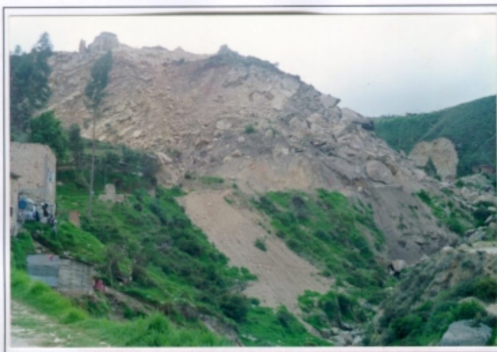
ROLLO 9044 Quebrada Quiba FOTO 25 Bloques en canteras y algunas viviendas aledañas
