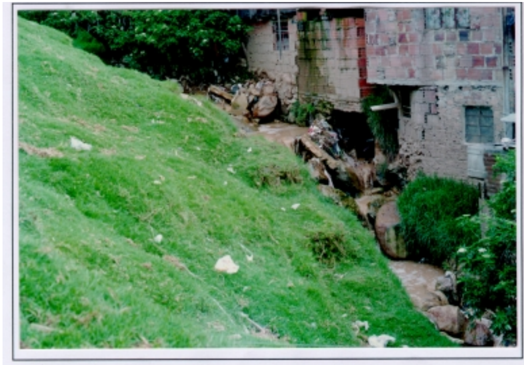
ROLLO 8612 Barrio Nueva Gloria (Quebrada El Zuque) FOTO 14 Casas sobre el curso de la Quebrada y afectadas por el socavamiento
