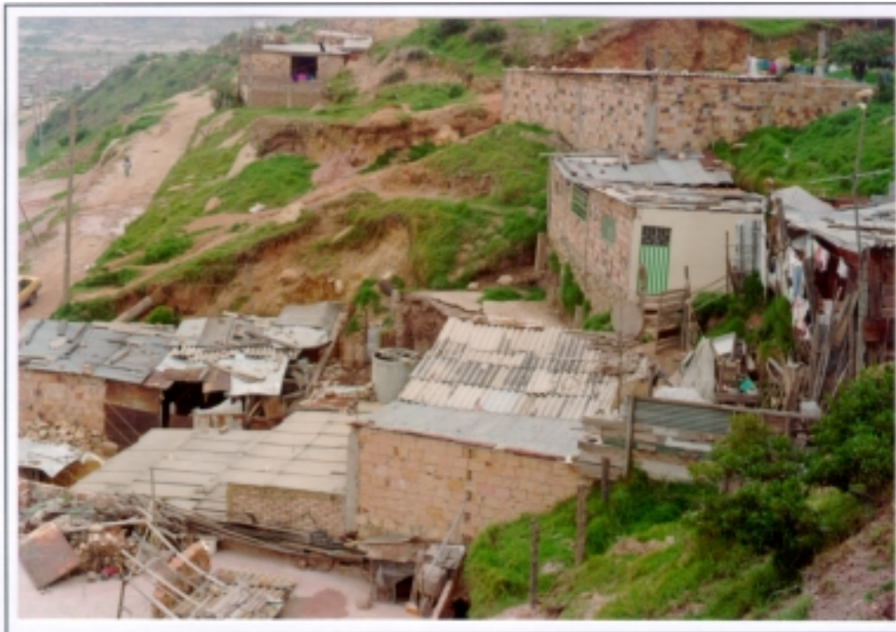
ROLLO 8331 Barrio El Pedregal FOTO 2 Casas con peligro de caída de bloques
