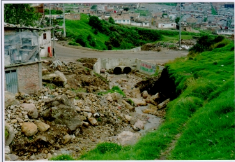
ROLLO 8332 Quebrada El Zuque, Barrio Quindio FOTO 1 Alcantarillas inadecuadas y gran cantidad de material inestable
