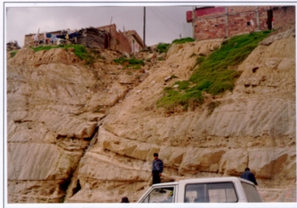
ROLLO 9044 Barrio La Playita FOTO 17 Mal manejo de aguas y casa sobre material inestable
