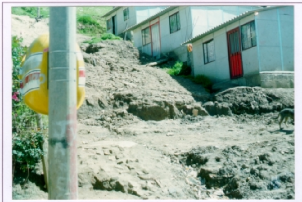
ROLLO 8613 Barrio Voz de Alerta FOTO 12 Casas recién construidas sobre material poco consolidado
