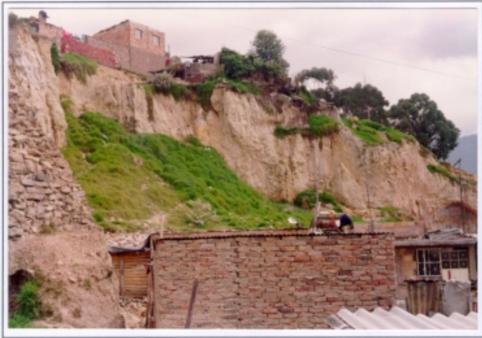
ROLLO 9098 Barrio La Playita FOTO 16 Casa sobre antiguas canteras y en zonas de materiales inestables
