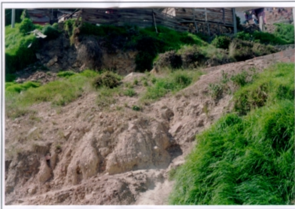
ROLLO 9047 Barrio Jerusalén FOTO 2 Casas construidas sobre material inconsolidado
