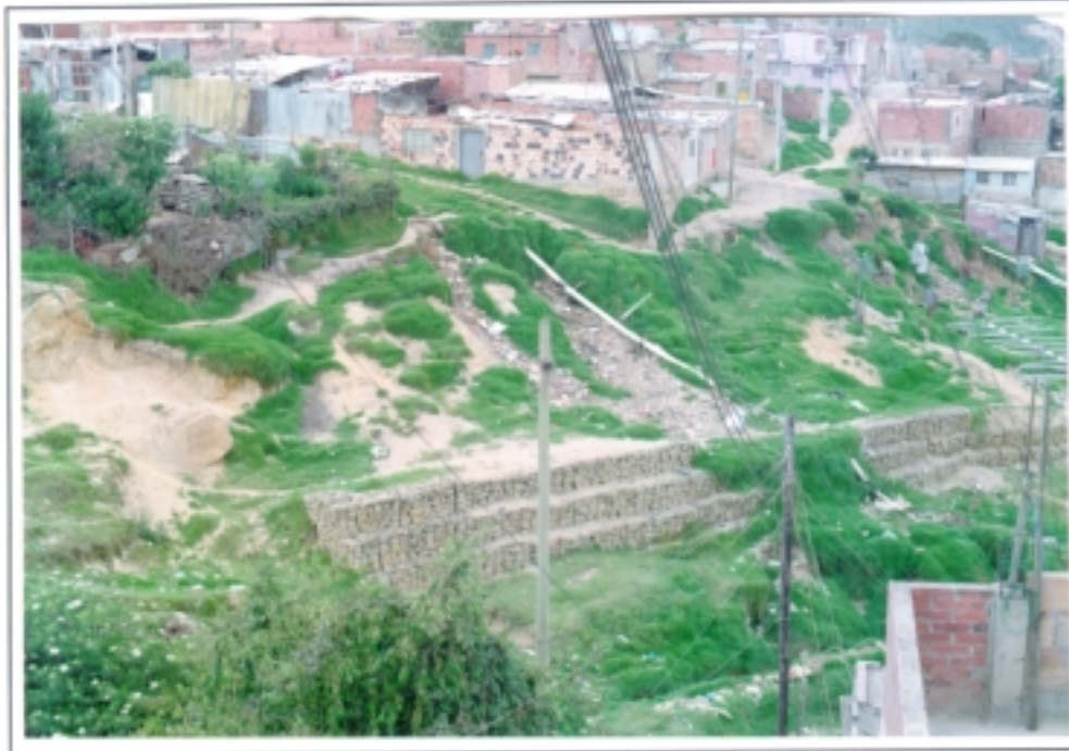
ROLLO 9044 Quebrada Lima – Barrio Nueva Colombia FOTO 23 Estructuras sobre materiales inestables y muros de contención debilitados
