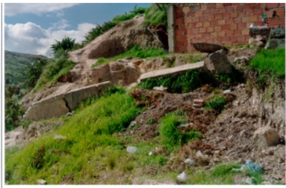
Barrio Juan José Rondón Construcciones al borde de la quebrada
