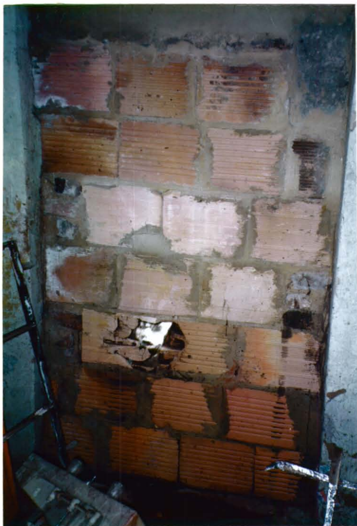
- Paredes rotas dejó la inundación (barrio Quindío)
