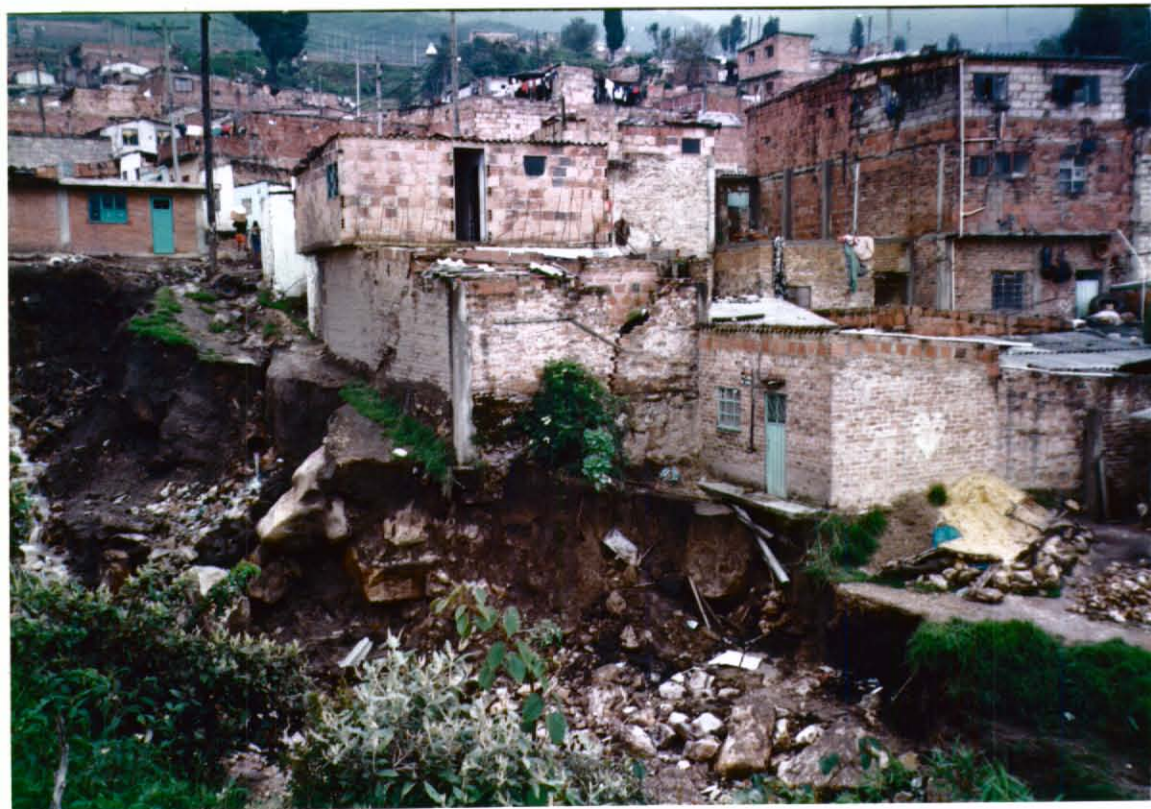
- Cimientos arrasados, pared agrietada a punto de caer (barrio Quindío)
