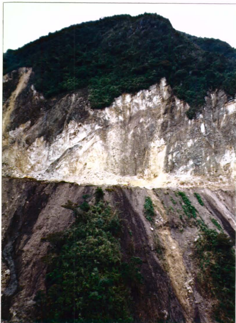
- Erosión, cantera Zuque de la Secretaría de Obras de Bogotá.
