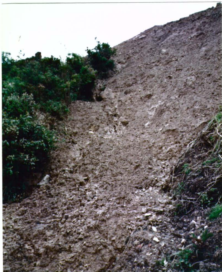
- Suelo erosionado e inestable que requiere trabajo de estabilización para construir. (Barrio Moralba).
