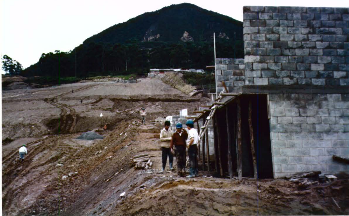
- A pesar del riesgo que hay en el sector los urbanizadores construyen, al parecer sin hacer las obras de estabilización del terreno necesarias. Paseito I, II, III.
