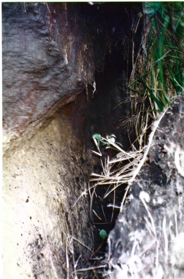
- Agrietamiento y desprendimiento en la parte media de la montaña, con más de 30 centímetros de separación. Lugar por donde la quebrada "desfogó" sus aguas represadas.
