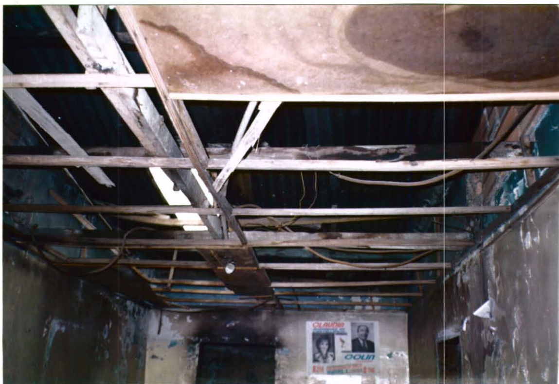
- El agua arrasó el techo (barrio Quindío)
