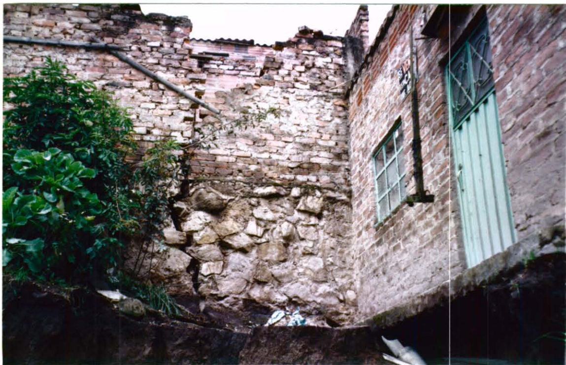
- Paredes agrietadas, barrio Quindio
