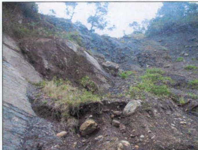
Foto 4-22. Deslizamiento en la margen izquierda del río Chochal al sur de Nazareth se aprecia hacia la parte superior el depósito torrencial aterrazado de Nazareth. Hacia la parte inferior izquierda los estratos de la formación chipaque. Este deslizamiento es de tipo remontante.
