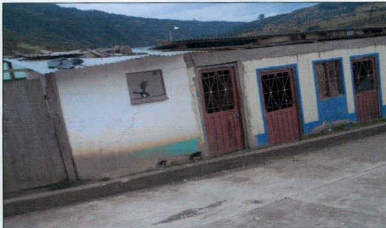
Foto 4-32 Deterioro de una de las viviendas en la calle principal al Nor Occidente de la cancha cubierta, la cual se ubica sobre rellenos mal conformados y desconfinados por corte ejecutado en la parte posterior.
