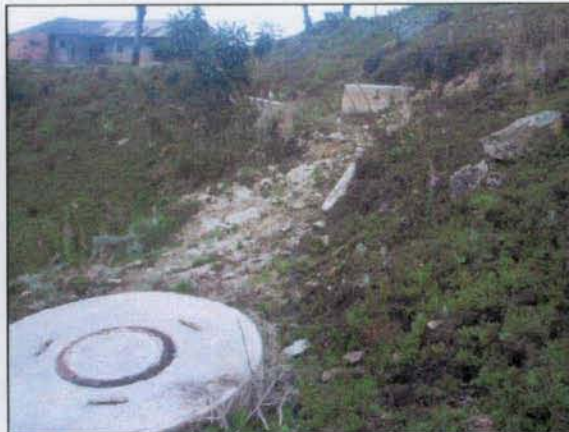
Foto 4-6. Se aprecia un pequeño escarpe cercano a la tubería y pozos de alcantarillado.
