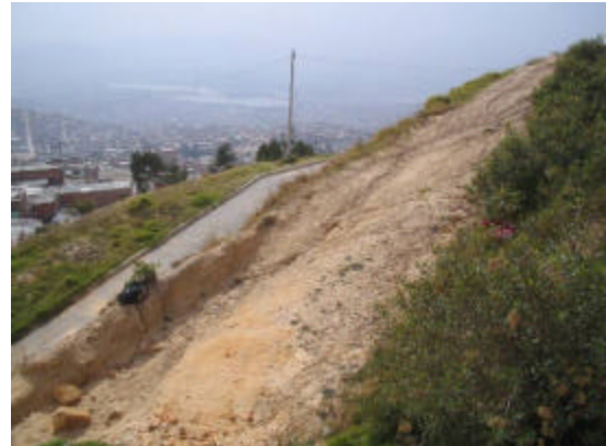
Fotografía 16. La escorrentía genera surcos y ya se observan grietas en otros sectores del talud.
