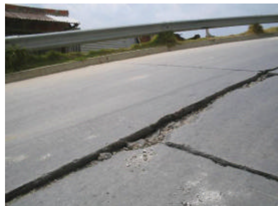
Fotografía 12. Las grietas en la vía, junto con el paso de buses de considerable peso, generan vibraciones en el terreno que perjudican el escarpe rocoso cercano a la vía.
