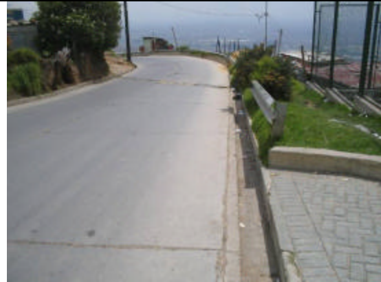
Fotografía 8. Las cunetas de la vía se encuentran dispuestas en solo una de las calzadas. También se encuentran obstruidas por basuras.
