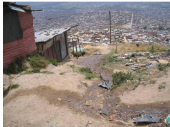
Fotografía 10. El agua fluye hacia el talud, generando cárcavamiento y filtrándose hacia los estratos más permeables.
