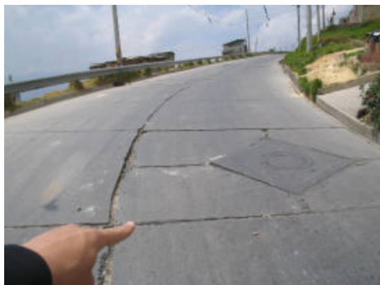
Fotografía 11. El estado de la vía que conduce hacia el Barrio Los Alpes es regular, dada la presencia de grietas en las losas de concreto hidráulico.
