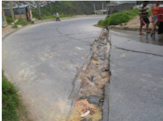
Fotografía 15. Las cunetas que intercambian el flujo de un lado al otro de la vía se encuentran totalmente tapadas.
