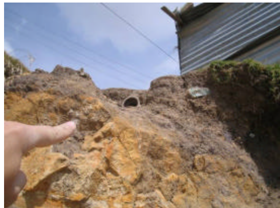
Fotografía 6. El agua servida se infiltra a través de las discontinuidades de la roca arenisca o por las zonas de brecha de falla.
