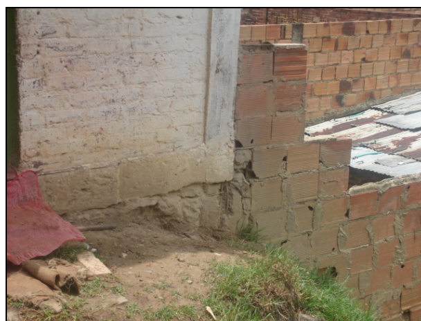
Fotografía 6-5 Deficiencias del vibrado en el arranque de las columnas del primer piso y en los empates entre columnas y vigas
