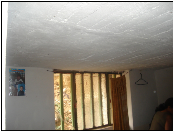
Fotografía 6-3 Deflexiones en la parte interior del primer nivel
