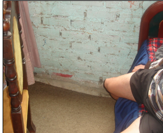
Fotografía 6-7 Resane que el residente hizo de las grietas entre el muro y la placa, y se puede apreciar también una fisura horizontal en la segunda hilada.
