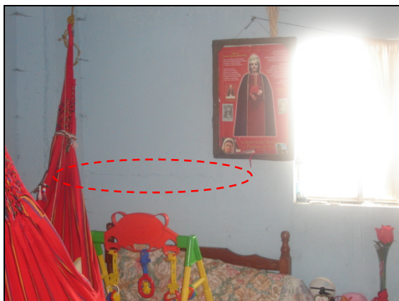
Fotografía 6-10 Fisura en el muro que da hacia la zona verde.
