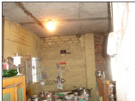
Fotografía 6-11 En la placa de contrapiso se presenta una grieta atrás de la última columna.
