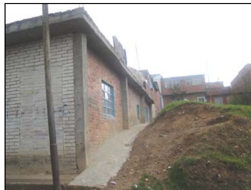
Fotografía 6-9 Los muros que dan contra la zona verde presentan algunas fisuras
