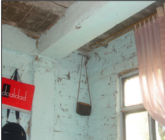
Fotografía 6-6 Grietas que hay hacia el oriente del pórtico existente.
