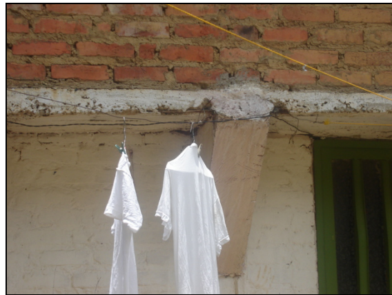
Fotografía 6-4 Deflexiones en la parte exterior del primer nivel
