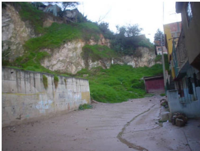
Fotografía 1-1 Muro de retención para caída de bloques en la zona A
