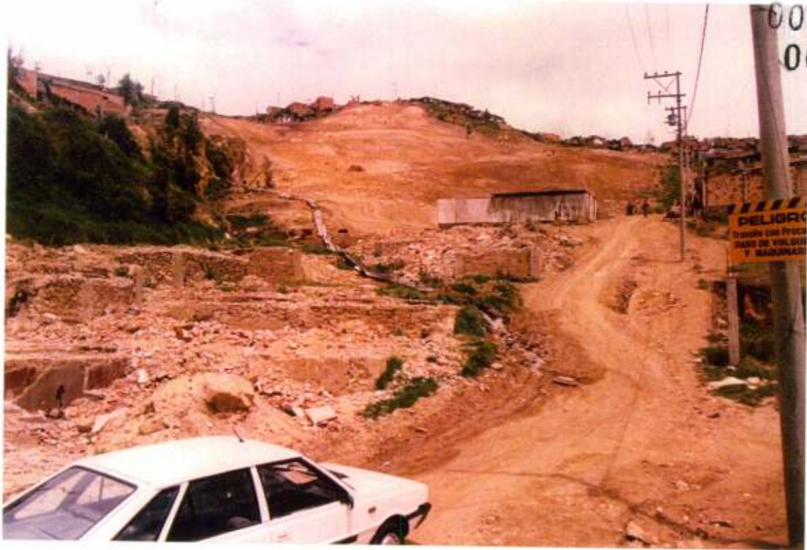
5. Estado del terraceo en julio /2000, en la parte inferior se destaca el manejo temporal de las aguas.
