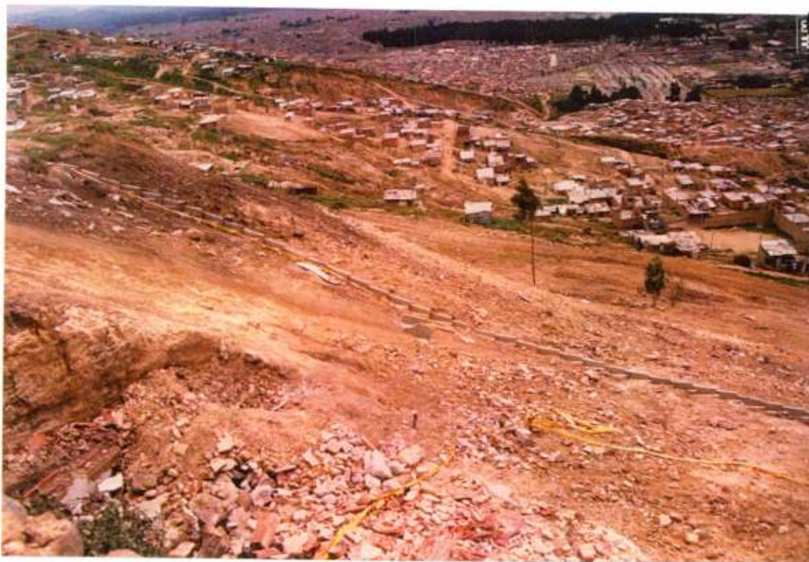
7. Flanco izquierdo del deslizamiento terraceado, en julio/2000.
