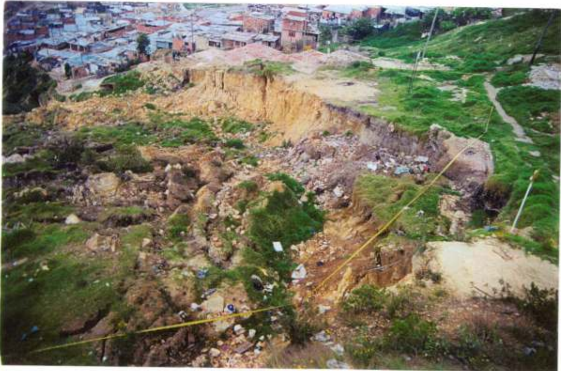
4. Fianco derecho del deslizamiento (mayo 2000).
