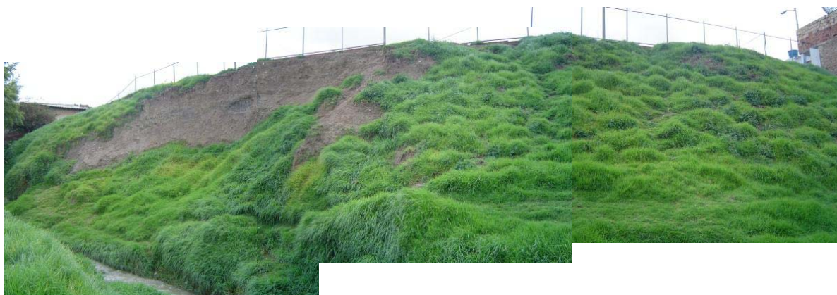
Foto 2 – Talud desarrollado sobre la Formación Sabana. Se aprecia un deslizamiento por socavación de la quebrada
