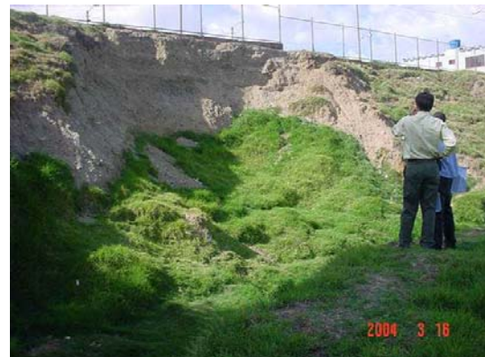
Foto 5 – Deslizamiento en inflexión de la quebrada sobre el costado izquierdo de la misma, que afecta el talud de la Formación Sabana
