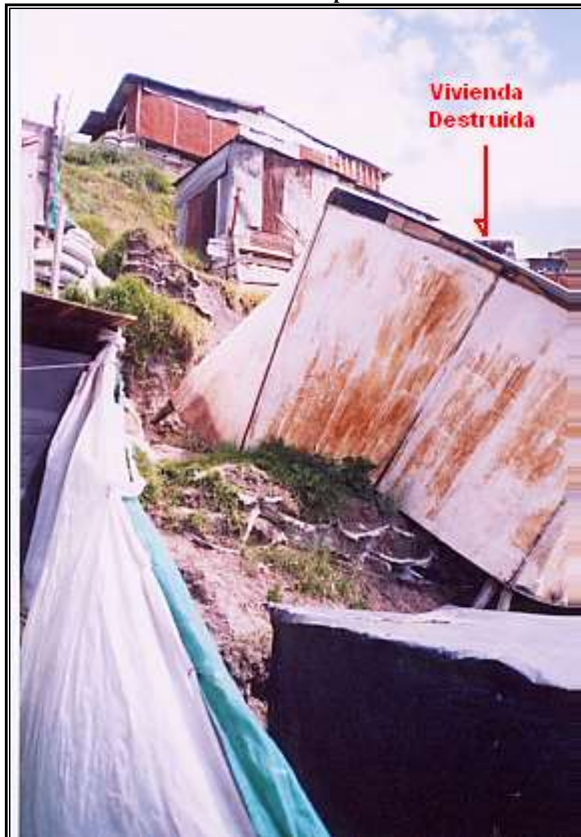
Fotografía 3. 23 Vivienda de la Manzana 55 destruida por falla en los taludes de corte en la ladera de contrapendiente
