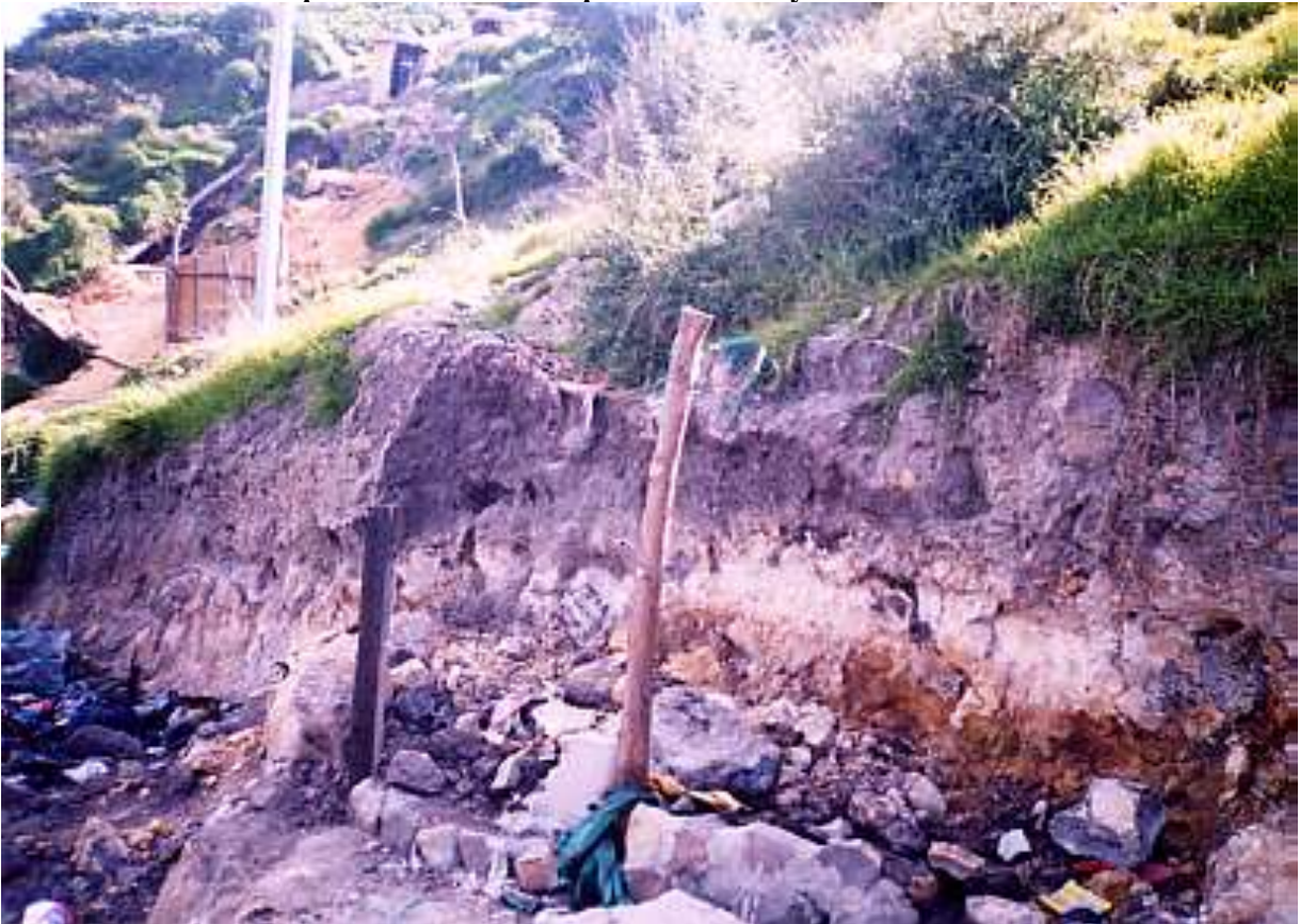
Fotografía 3. 24 Corte posterior de la vivienda 7 – Manzana. Desprendimientos del deposito Coluvial y roca meteorizada
