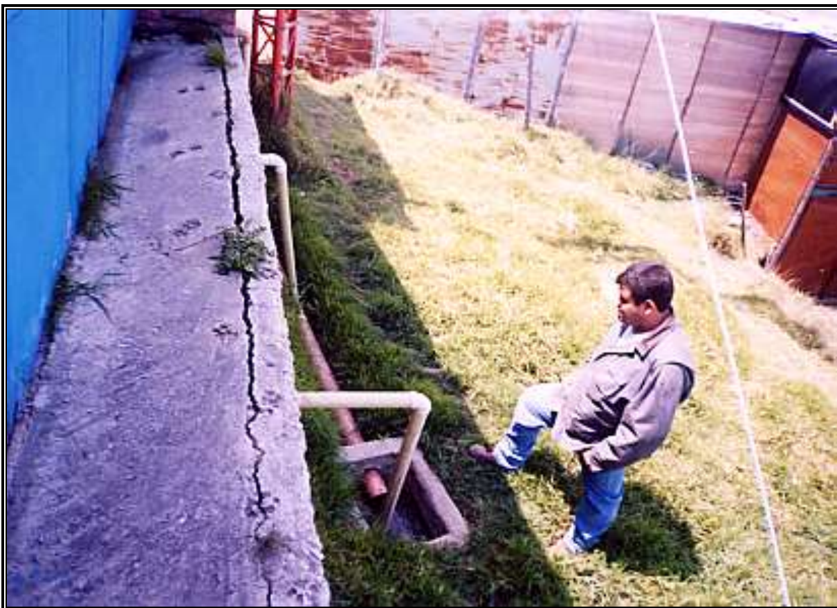
Fotografía 6. 1. Sistema de drenaje realizados en los predios 51-2 y 51-3
