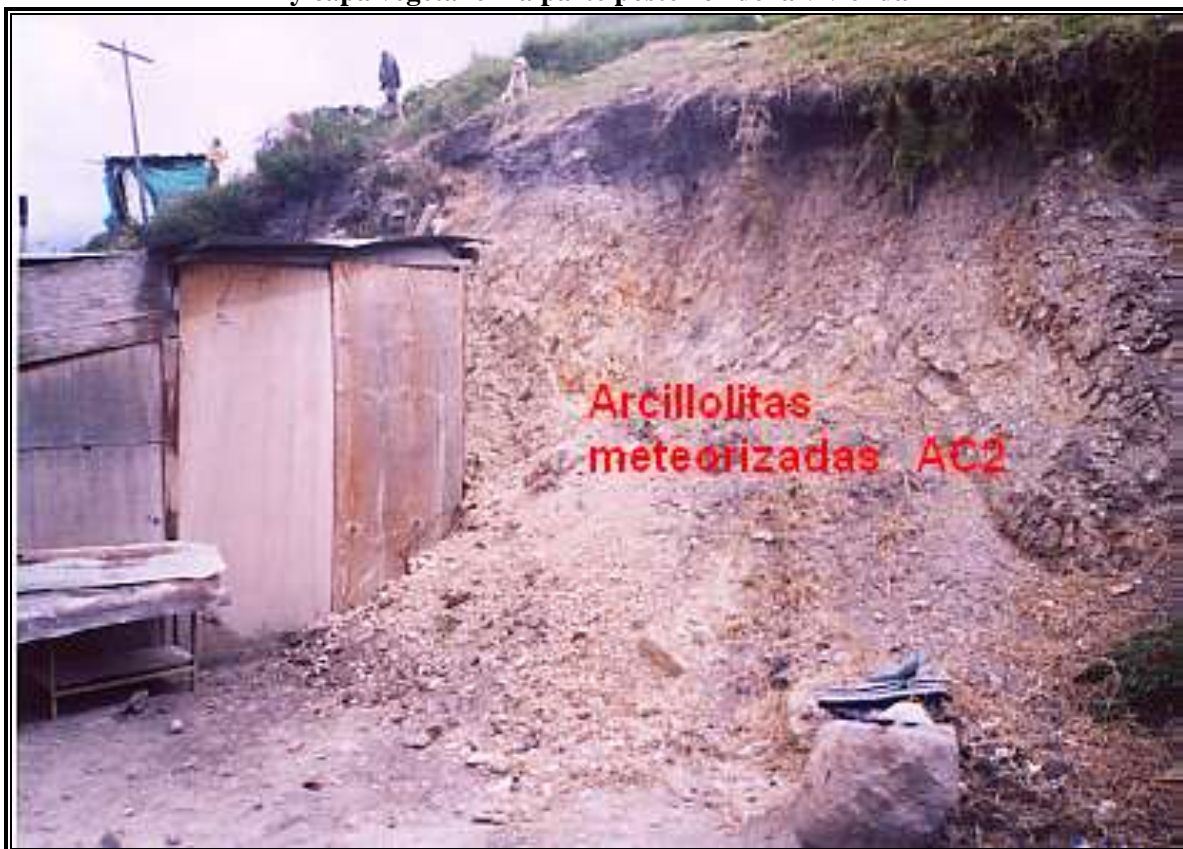
Fotografía 3. 9 Casa 2 de la Manzana 11. Caída de arcillolitas meteorizadas Ac2 y capa vegetal en la parte posterior de la vivienda
