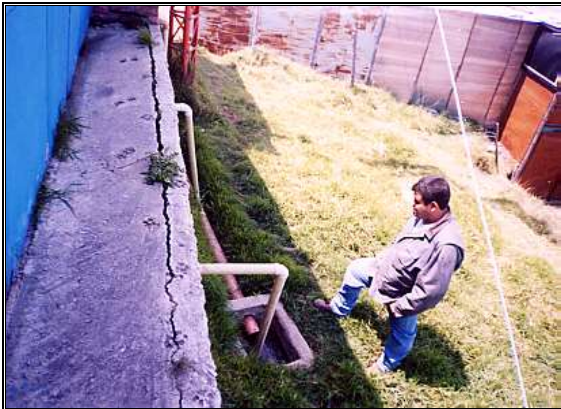
Fotografía 3. 25 Filtros en la cimentación de la vivienda 4 de la Manzana 51 para drenar aguas de infiltración en los taludes y terreno. Obsérvese las grietas en la cimentación
