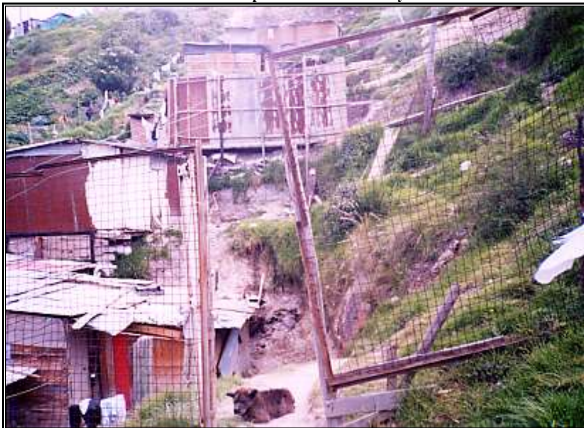
Fotografía 3. 26 Viviendas 8,10 y 11 de la Manzana 11. Taludes con desprendimientos de roca y suelo
