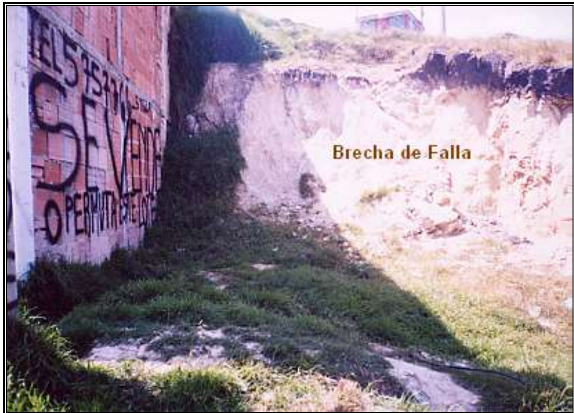
Fotografía 3. 12 Talud sobre la vía principal entre las Calles 74 y 75 Sur. Areniscas de la Unidad Ar1 brechadas por efectos del fallamiento
