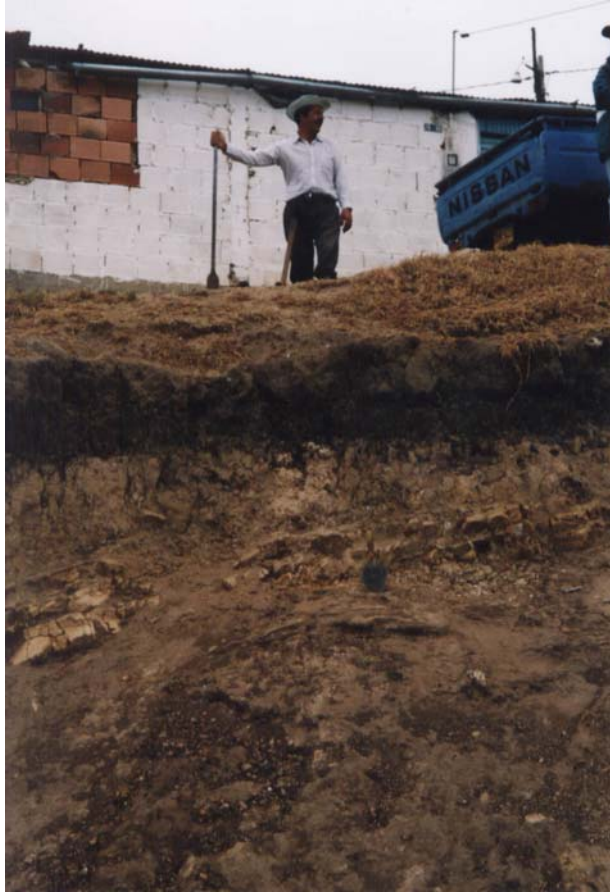
Punto 6 – KR 90 con CL 54. Vista hacia el cuerpo del deslizamiento. Nótese en el perfil el material residual, la arcilla carbonosa y la roca arenisca subyacente.
