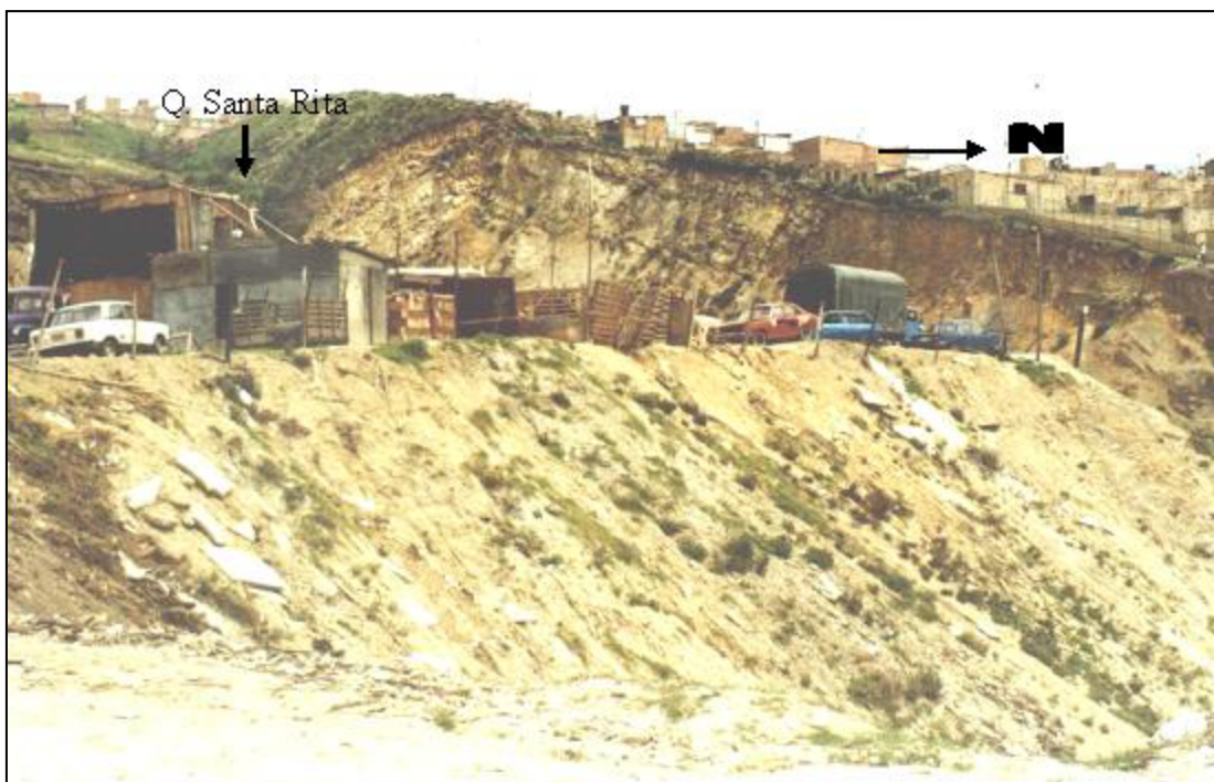
Foto 4.6. Flanco derecho de la quebrada Santa Rita. Rellenos mecánicos conformados por escombros de construcción, suelo residual removido y basuras, entre otros. Este relleno está siendo utilizado como parqueadero de vehículos (May/02).
