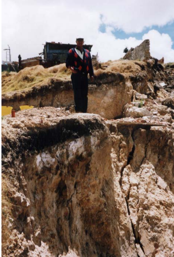
Punto 4 – KR 88 con CL 56. Zona de material removido. Nótense el perfil del terreno en el escarpe.
