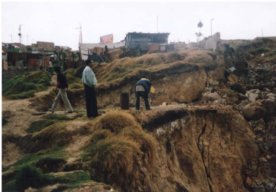
Punto 4 – KR 88 con CL 56. Zona de material removido. Notense las grietas y estado del terreno. No existen vías ni viviendas.
