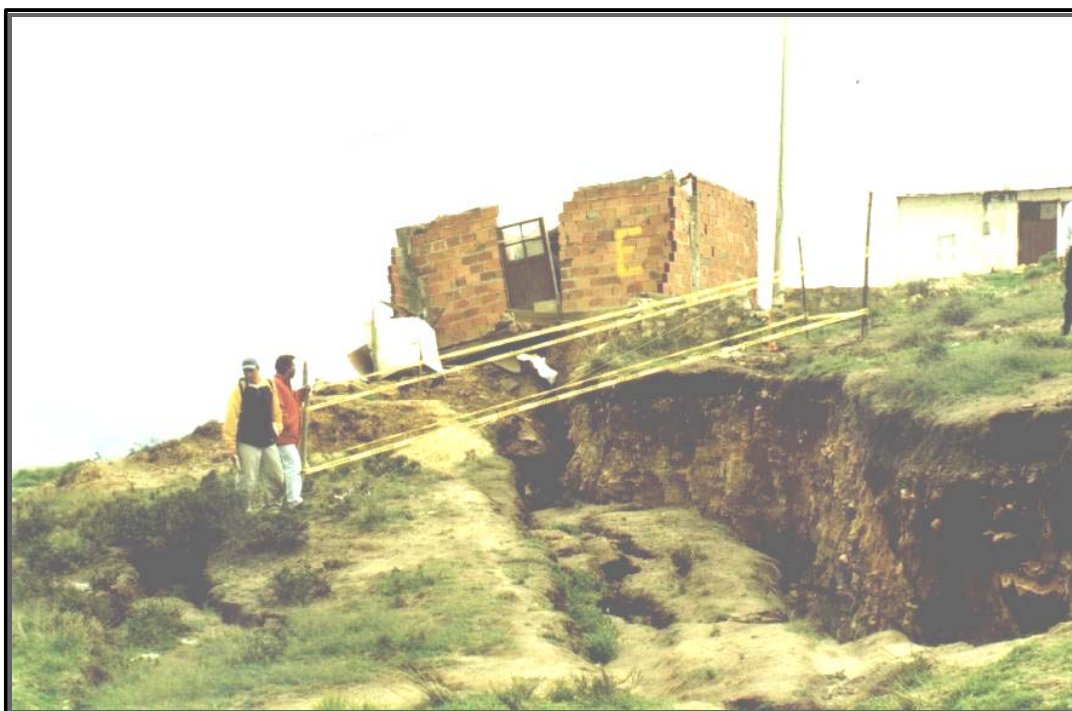
Foto 4.9. Vivienda afectada por agrietamientos que se extienden a lo largo de la carrera 89, Barrio El Espino sector I. (May/02). En el capítulo de Geología estos fenómenos se describen como la Unidad de Suelo Residual y Roca desplazada (Qsd).
