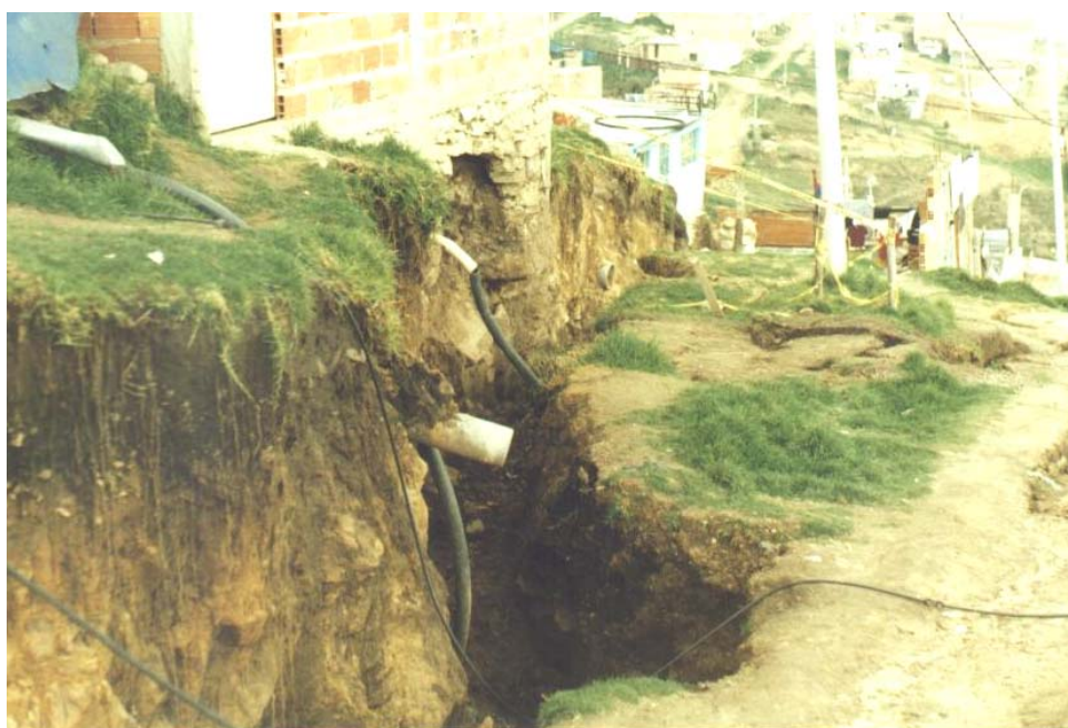
Foto 4.8. Detalle de los agrietamientos que afectaron las tuberías de acueducto y alcantarillado. Estas grietas alcanzan aberturas cercanas al metro y profundidades mayores a los 3 metros. Carrera 89, barrio Cerros del Diamante (May/02).
