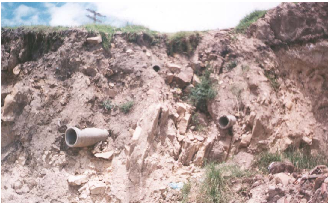
Foto 8.7 Tubería aflorando en al cara del talud
