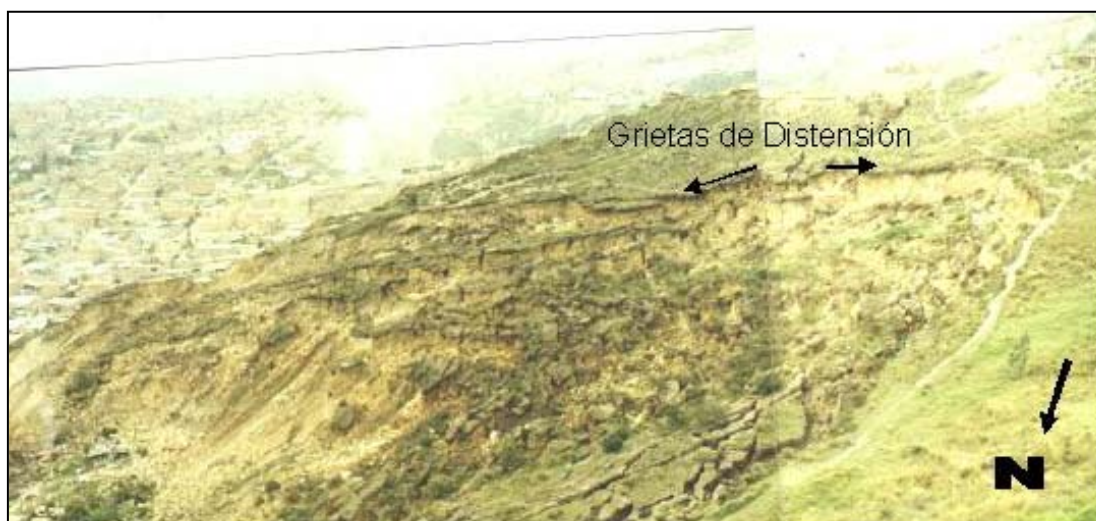
Foto 4.5. Panorámica de suelos residuales y roca desplazada afectando la ladera derecha de la quebrada Santa Rita (Cantera Santa Rita). Obsérvese la corona principal y los materiales conformados por Suelo residual, guijarros, gravas y bloques de arenisca. Hacia la parte superior de la corona principal se observan grietas de distensión. (May/02).
