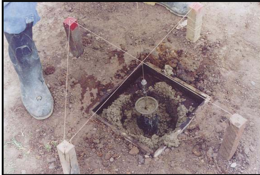
Foto 7.1 Detalle constructivo mojones. Se observa la plomada al punto central del mojón en el punto referenciado en los lineamientos topográficos. (May/02)
