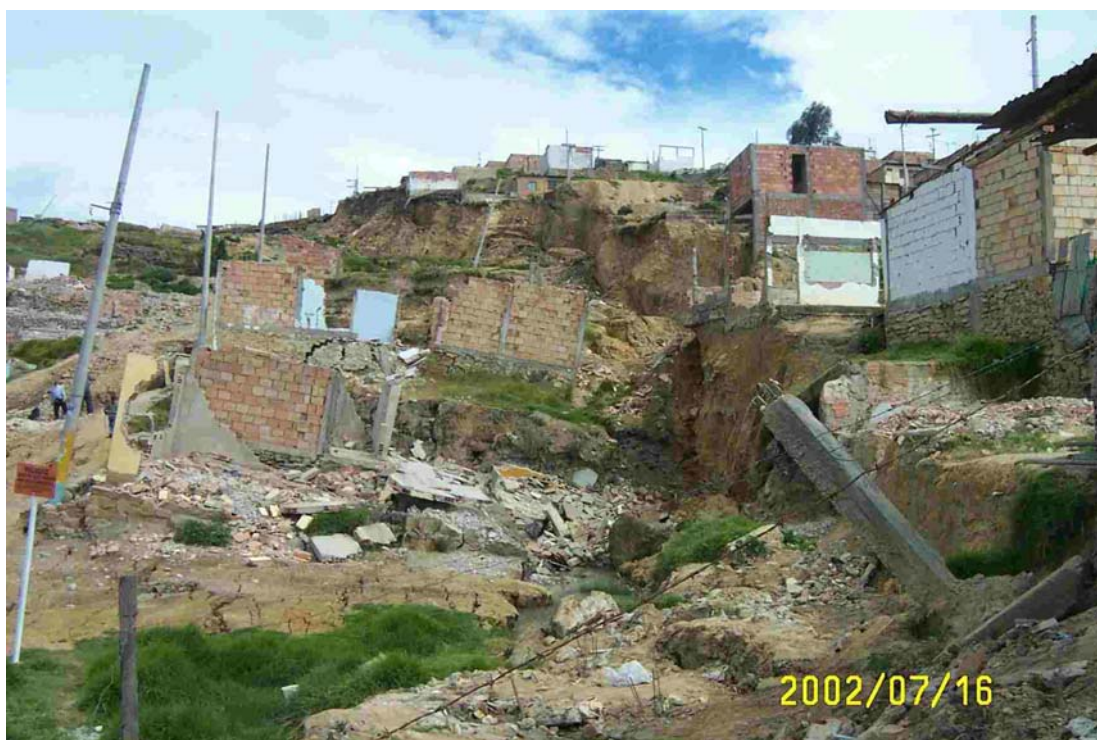
Foto 8.6 Aporte de aguas negras al deslizamiento por tubos de alcantarillado rotos
