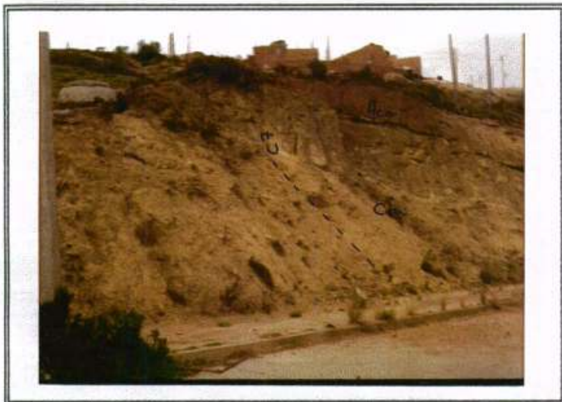
FOTO 12 Talud Nº 7 Afloramiento de gruesos bancos de Areniscas poco fracturadas ; hacia la base arcillolitas con bloques de areniscas
