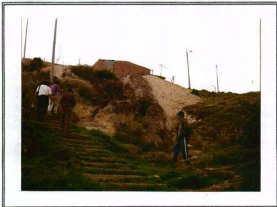
FOTO 13. Talud Nº.7 Procesos de carcavamiento en la parte superior de la vía ; afecta una secuencia de arcillolitas y depósitos antrópicos.
