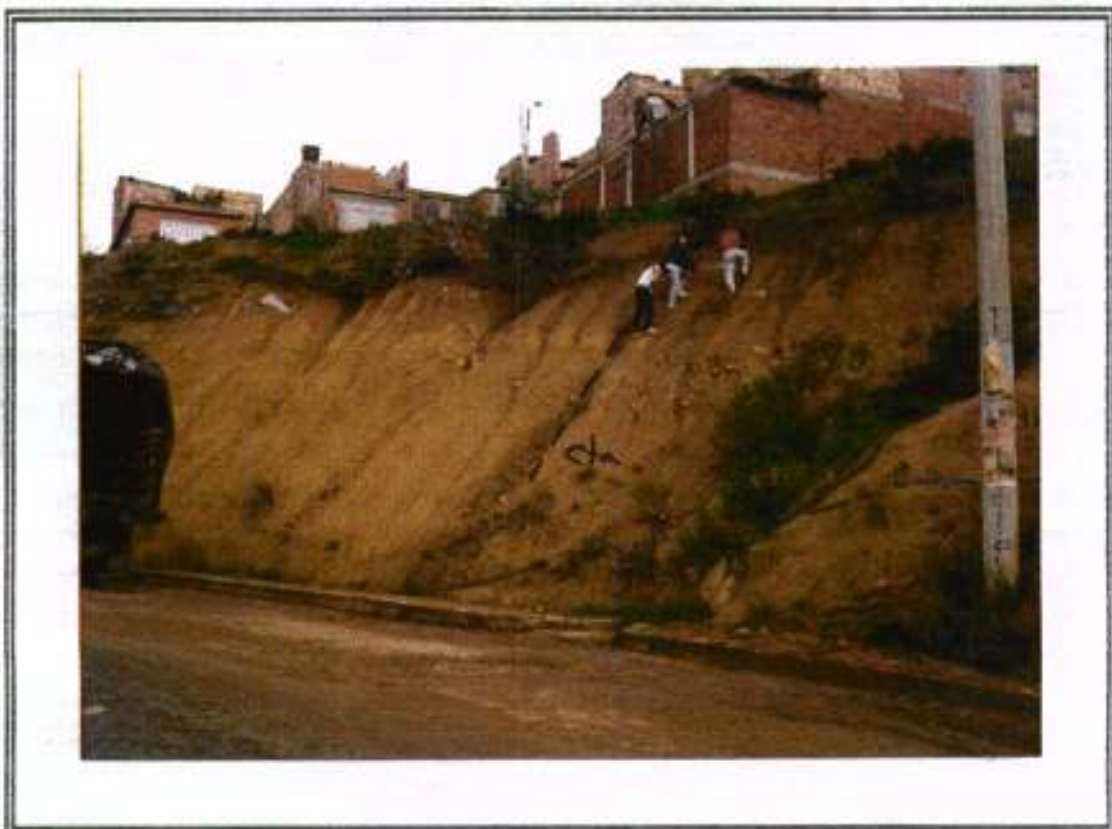
FOTO 3 Talud Nº1 Arcillolitas en la base de la secuencia y delgados estratos de areniscas altamente fracturados ; en la parte superior un suelo negro endurecido. Procesos de erosión
