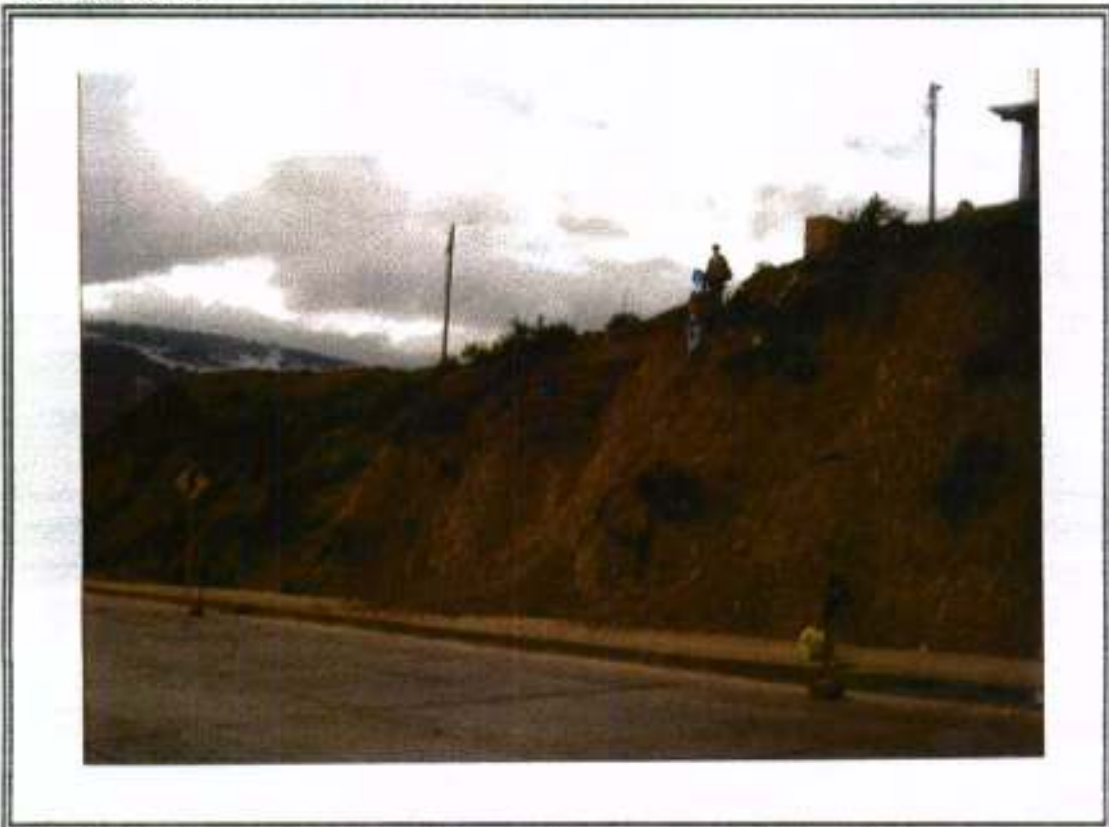
FOTO 6 Talud Nº2 Arcillolitas y limolitas con intercalaciones menores de areniscas meteorizadas y plegadas. Se observan los procesos erosivos de desprendimientos de masas de suelos y
