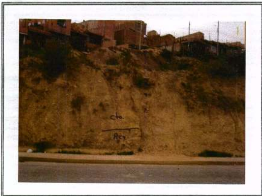
FOTO 8 Talud Nº.4 Afloramiento de areniscas hacia la base de la secuencia ; en la parte superior arcillolitas meteorizadas. Se observan cárcavas producidas por la ruptura de la tubería del
