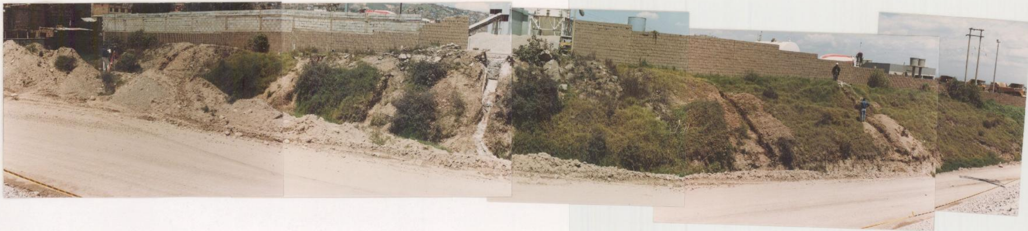
FOTO 3. Costado Sur Oriental del Predio de la Planta Sur. Se muestran las trincheras y el aspecto del talud en el terraplén.
