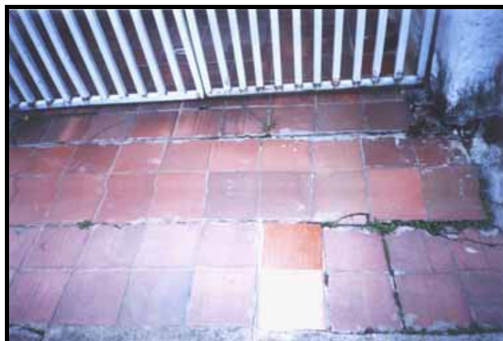
Fotografía No. 4. Grieta de daño severo en el piso del antejardín la casa de la Carrera 10F No. 36-64 Sur, Manzana 7.
