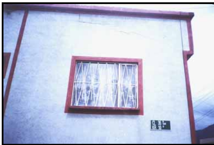
Fotografía No. 6. Grieta en muro (parte superior de la imagen) casa de la Carrera 10D No. 36A-75 Sur, Manzana 4.
