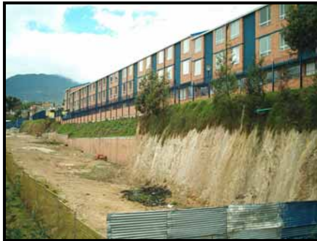
Fotografía No. 14. Areniscas de la Formación Regadera, en el talud de corte de la cimentación de los edificios en la urbanización Bosques de San Carlos contigua al barrio Pijaos-Jorge E. Cavelier.
