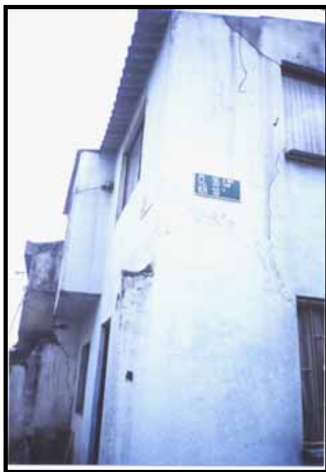
Fotografía No. 5. Grieta pasante, en muro de la casa esquinera Carrera 10F con calle 36A Bis Sur.
