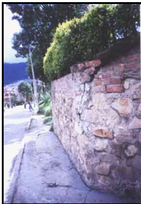
Fotografía No. 9. Grieta en el muro de aislamiento de la zona verde de la Carrera 10F No. 36-50 Sur, Manzana 7.
