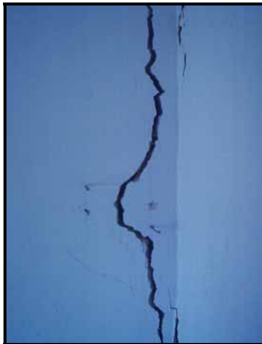
Fotografía No. 3. Grieta en muro de ola habitación en la casa ubicada en la Carrera 10F 36-80 sur (Manzana 7). Se realizó un monitoreo manual mediante el uso de marcas con el objeto de detectar de movimientos en el tiempo de ejecución del proyecto.
