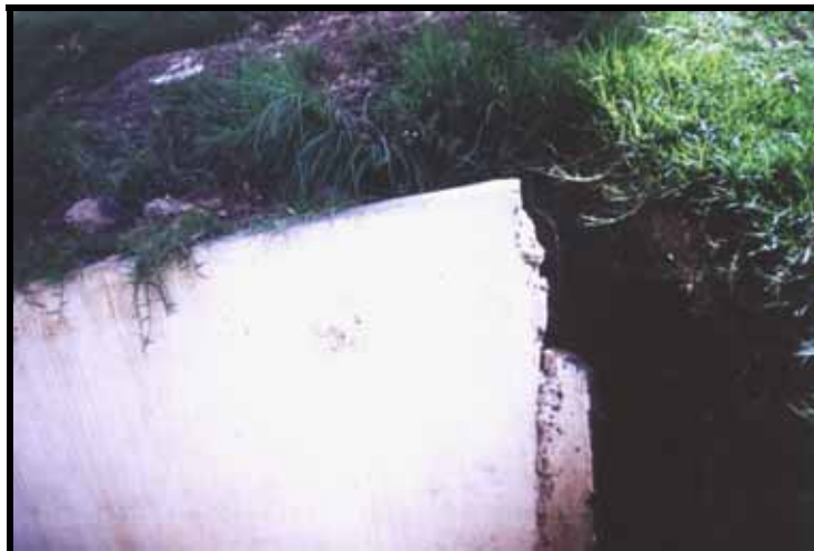
Fotografía No. 11. Muro de aislamiento existente en la Carrera 11A Sur, Manzana 12, sometido a un fenómeno de remoción en masa local. La Sra de la casa situada en frente de éste, es decir, cra 11ª-36ª-91 ha percibido el alejamiento del muro del terreno a largo de un año, tal y como se aprecia en la fotografía.
