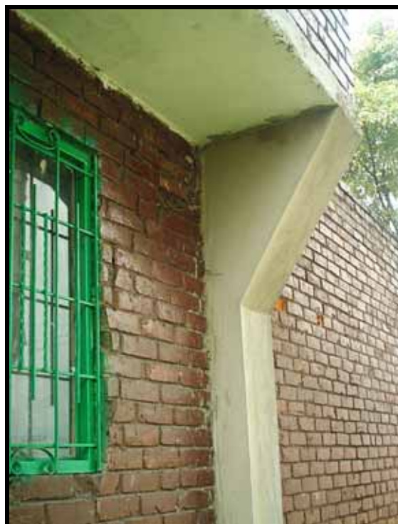
Fotografía No. 2. Desplome del muro en la casa localizada en la diagonal 36sur con carrera 10D No. 36-39 sur (Manzana 7). Se puede observar que en la parte superior se presenta agrietamiento en las columna de refuerzo construida hace menos de 2 años en la parte exterior de la casa (costado norte). En esta casa se realizó el apique C1.
