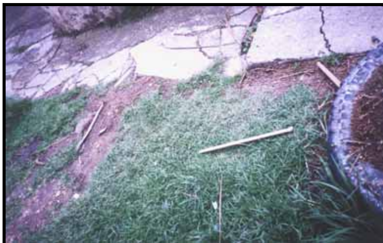
Fotografía No. 12. Estado del andén en la carrera 10F contiguo a la manzana 7.
