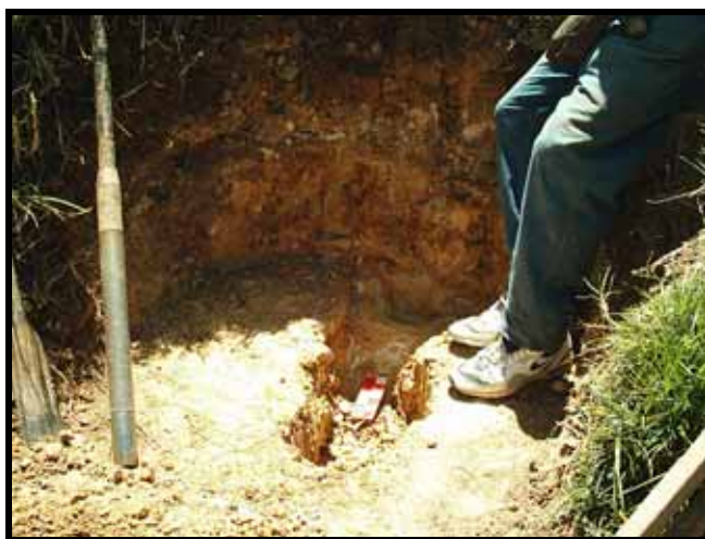
Fotografía No. 3. Estructura de drenaje tapada encontrada en el punto del sondeo manual No. 2, ubicado en la calle 36 B Sur con carrera 12.
