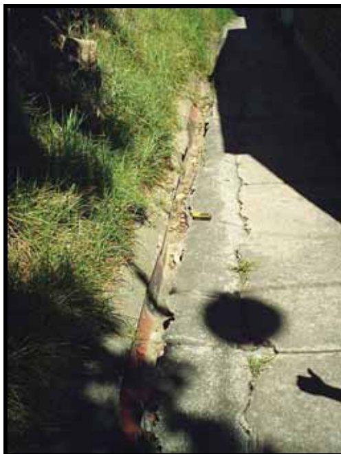
Fotografía No. 5 Cuneta aladaña a una de las casas más afectadas. Nótese que la cuneta disminuye su sección como resultado del empuje del proceso DTPI-001. Casa esquinera entre la carrera 12 y la calle 36 B sur.
