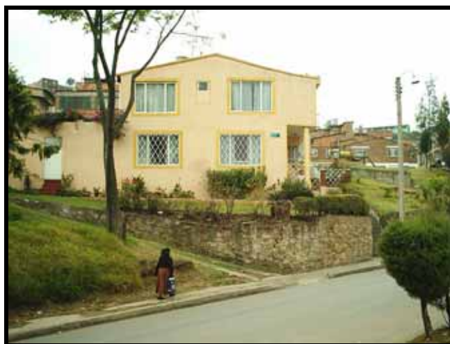
Fotografía No. 6 Sector de casas afectadas sobre la diagonal 36 sur aladañas al parque central. En primer plano el muro se encuentra agrietado. El parque y las casas se ubican sobre Cuaternario mixto.
