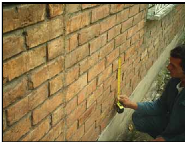
Fotografía No. 1. Grieta en la casa de la Manzana 10 Carrera 12 No. 36 a -63. También se realizó un monitoreo manual mediante la colocación de marcas con el fin de tener referencias de movimientos en el tiempo de ejecución del proyecto.
