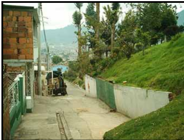
Fotografía No. 7. Muro de cerramiento de la zona verde, inclinado por un empuje del relleno. Este se definió como deslizamiento traslacional potencial incipiente DTPI-002. Este sitio se ubica sobre la carrera 11A.
