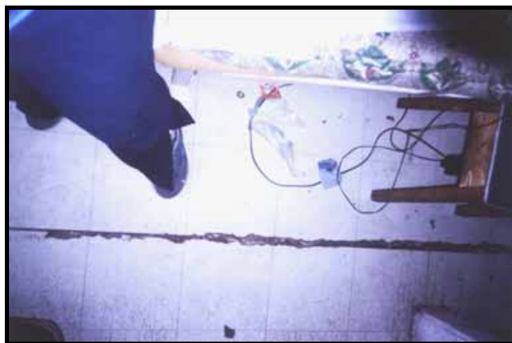
Fotografía No. 10. Grietas categorizadas de daño severo en el piso de la habitación de la casa ubicada en la carrera 10F No. 36-80 Sur, Manzana 7.
