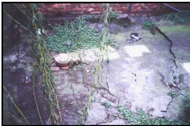
Fotografía No. 7. Grietas severas y hundimientos del piso del patio de la casa de la Carrera 10D No. 36A-62 Sur, Manzana 3.
