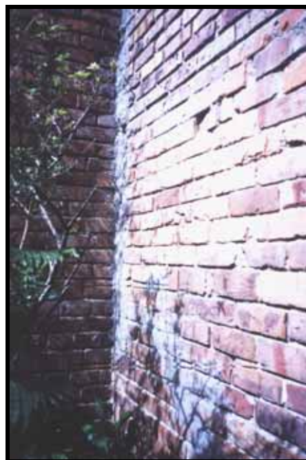
Fotografía No. 8. Grietas resanadas (hasta de 7 cm. de ancho) en el muro del patio de la casa de la Carrera 10D No. 36-39 Sur, Manzana 7.
