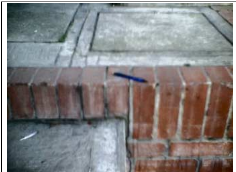
Foto 8. Fisuras en los alrededores del edificio
