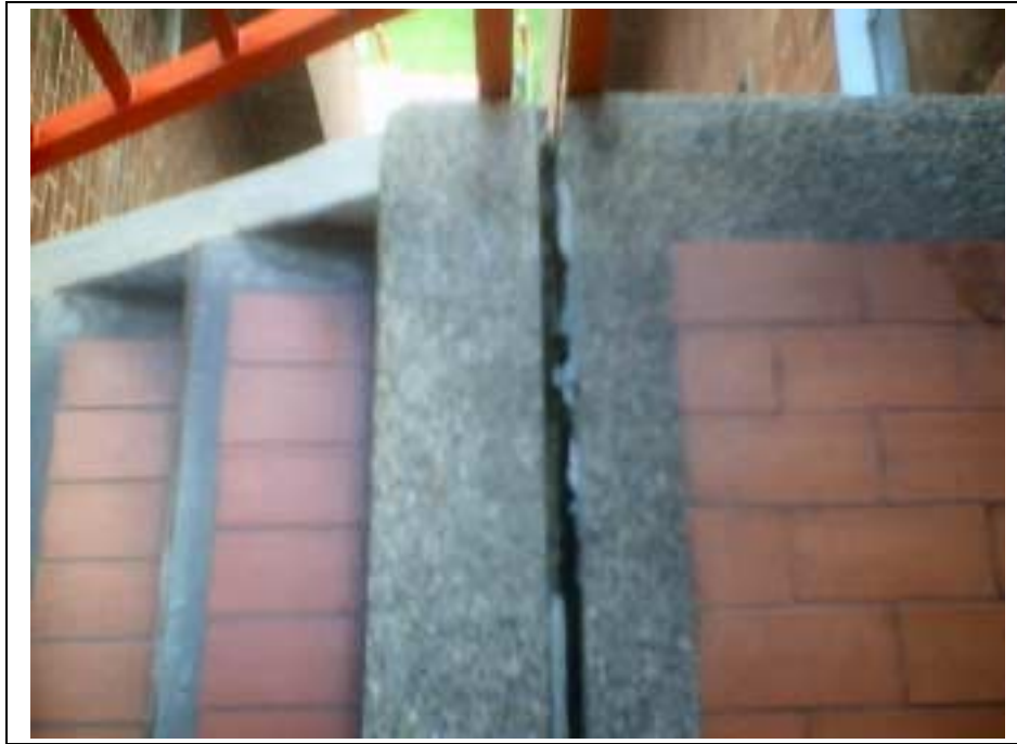
Foto 4. Fisura en escaleras, piso 6
