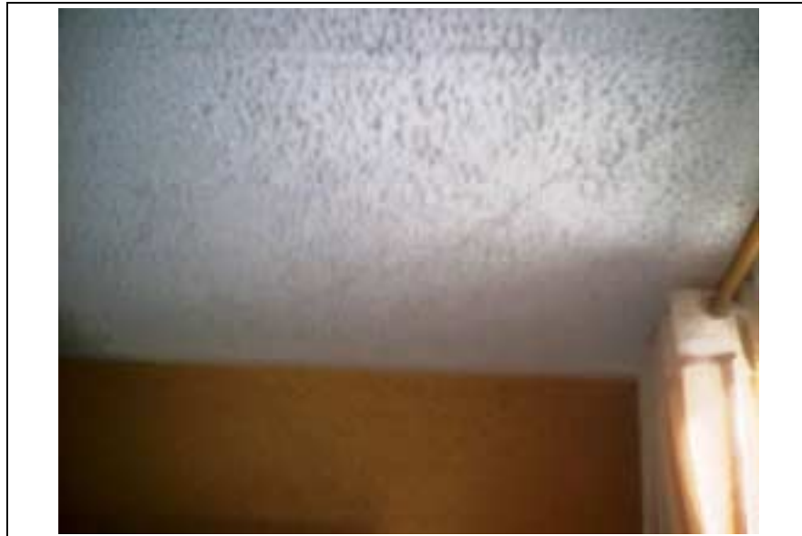
Foto 15. Fisura en cielo raso
