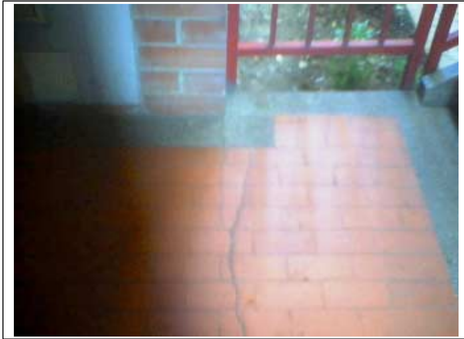
Foto 14. Fisura en escaleras
