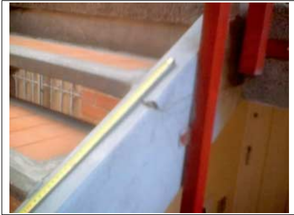
Foto 20. Fisuras en las Vigas Gualderas
