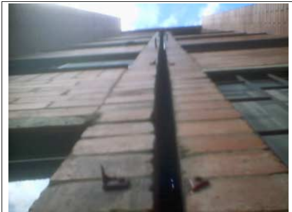
Foto 17. Vestigios de bajante desprendida por separación de bloques
