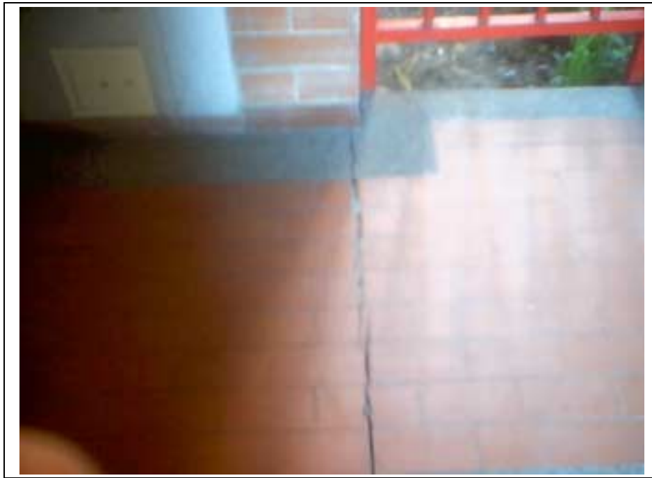
Foto 2. Fisura en escalera, piso 1
