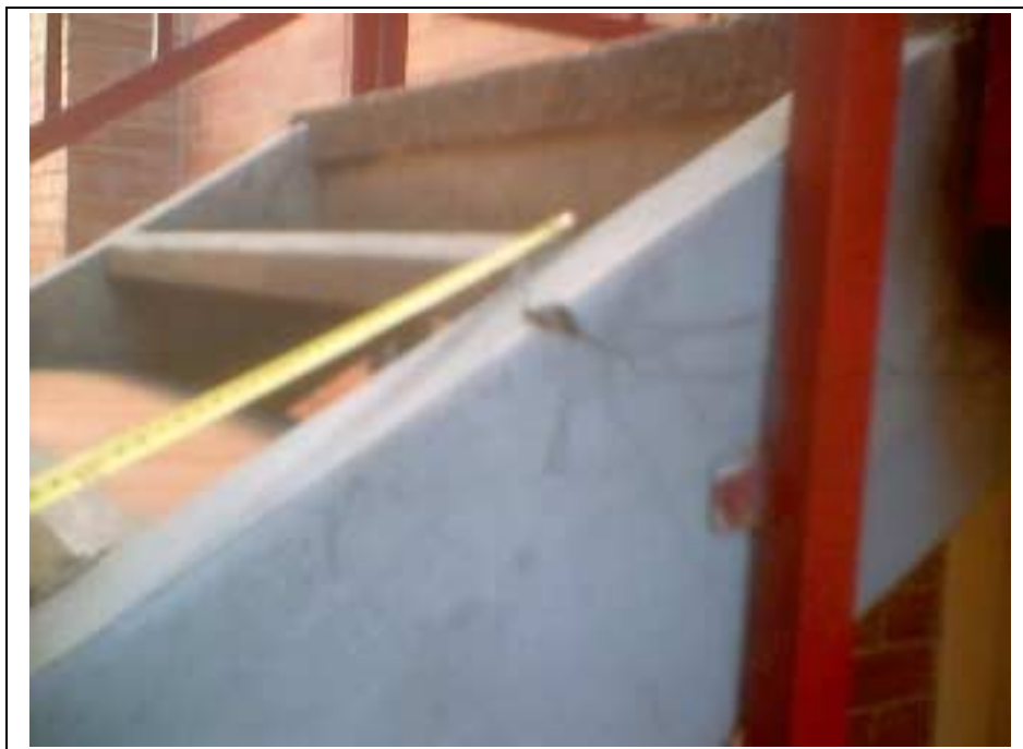
Foto 13. Fisura en Viguetas de escalera
