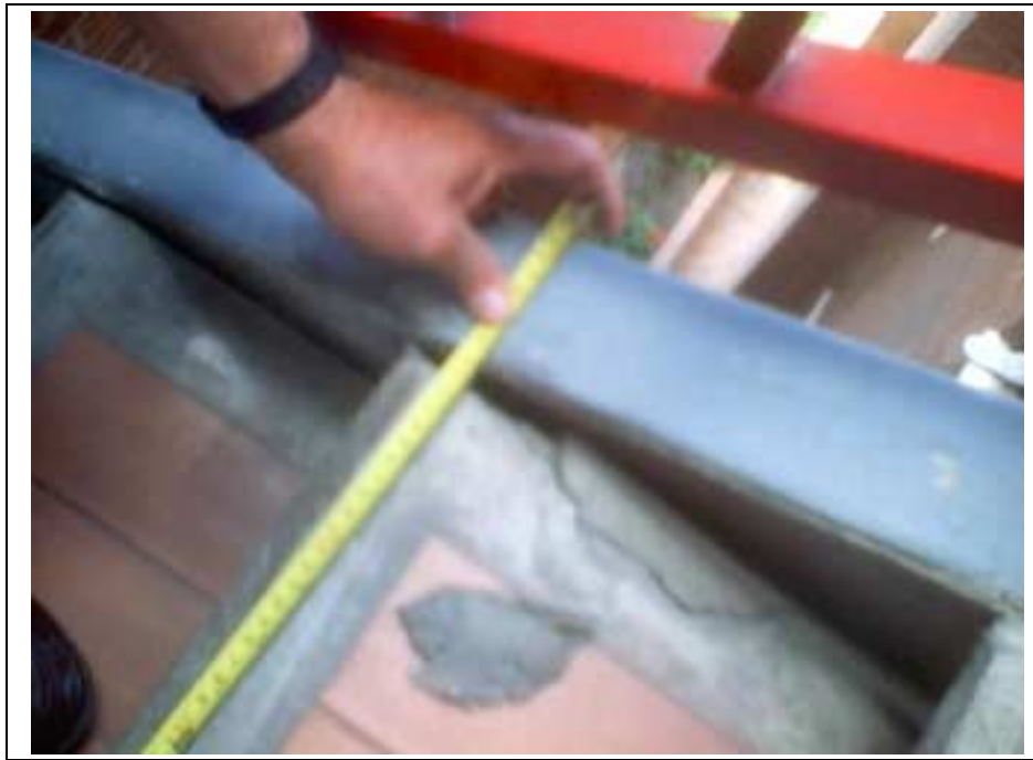
Foto 10. Desplazamiento lateral de los escalones
