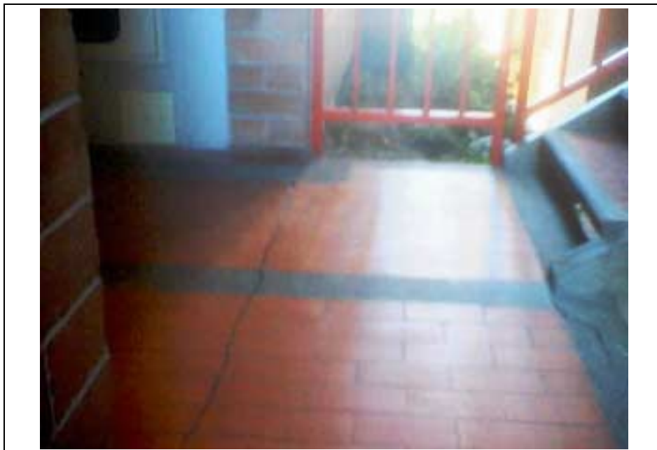
Foto 19. Fisura en la zona de Arranque de la Escalera.
