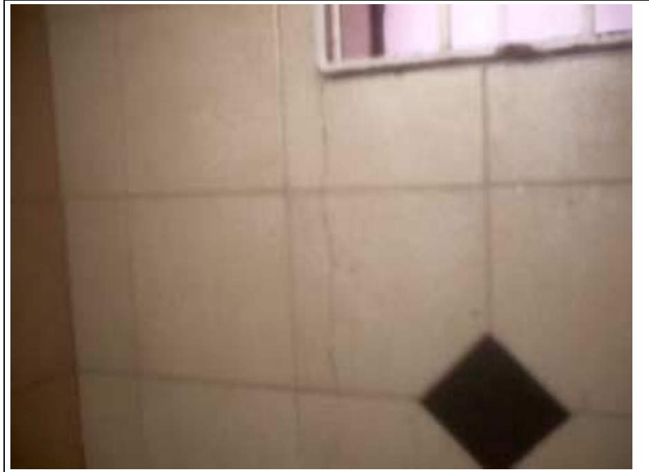
Foto 9. Fisuras al interior de los apartamentos
