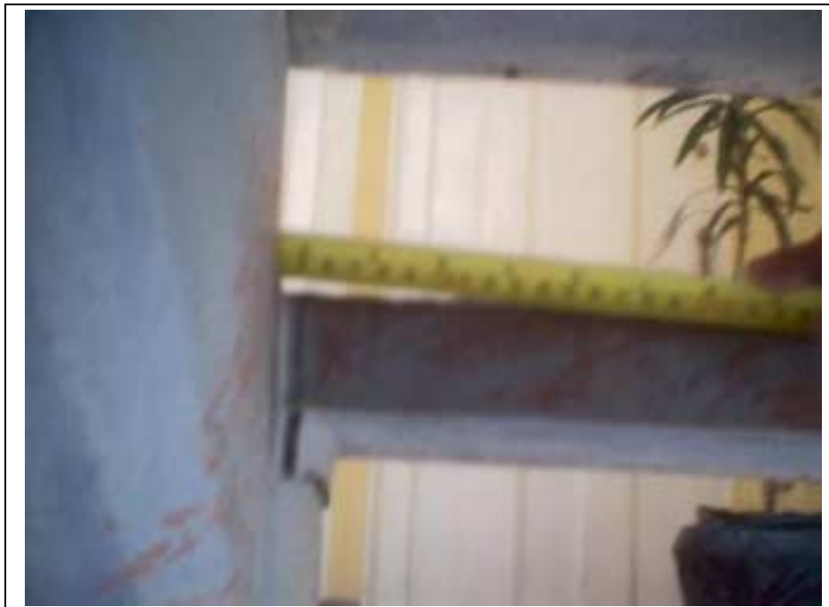
Foto 11. Desplazamiento lateral de los escalones
