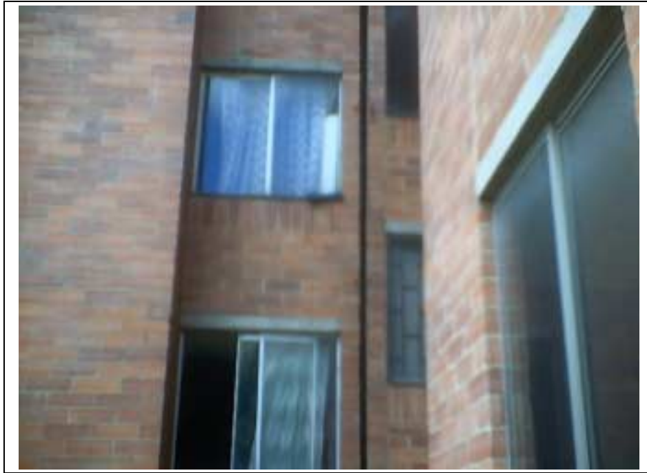
Foto 16. Separación entre torres de los bloques 3 y 4
