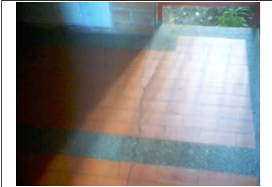
Foto 6. Fisuras en escaleras, piso 1
