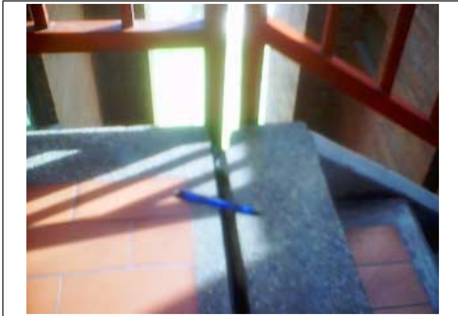
Foto 7. Fisuras en escaleras, piso 6
