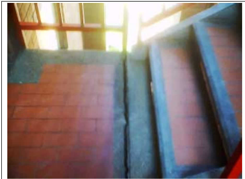
Foto 3. Fisura en escaleras, piso 3
