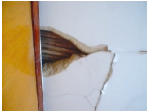
Fotografía 3. Desprendimientos y fisuras en cielorraso. Puede apreciarse la esterilla de guadua y el pañete que lo conforman.
