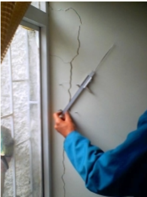
Fotografía 2. Medición de distancias para control de desplazamiento, en el punto de control B, de la vivienda identificada con el No. 28A – 36 Sur.
