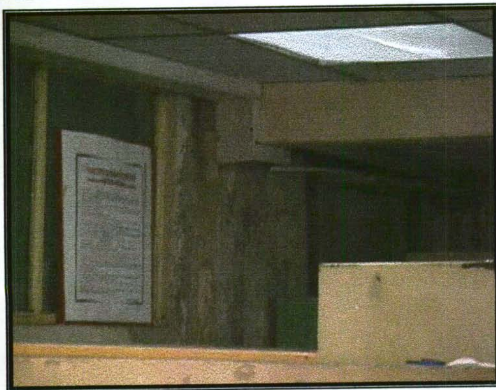
Foto 23. DETERIORO EN MUROS – ZONA MUROS DE CARGA
