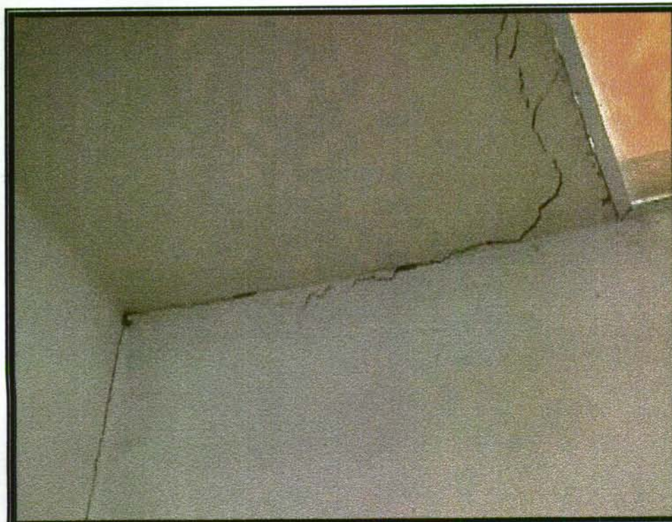
Foto 12. DETERIORO Y DESPRENDIMIENTO DE MURO DE MAMPOSTERIA
