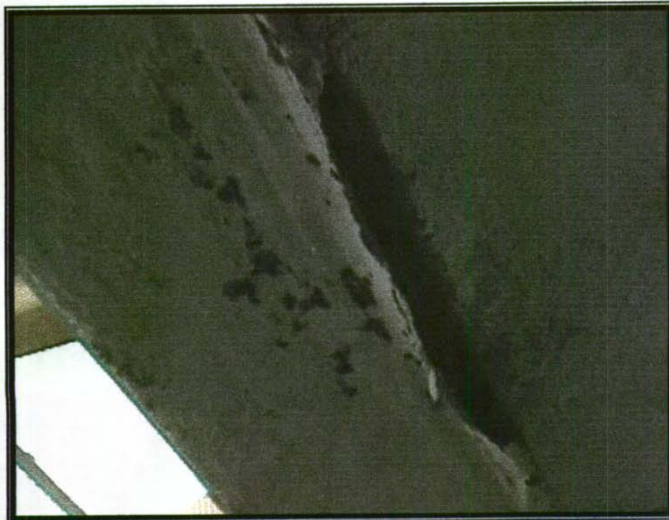
Foto 25. DETERIORO BAJO PLACA DE SEGUNDO PISO – ZONA MUROS DE CARGA
