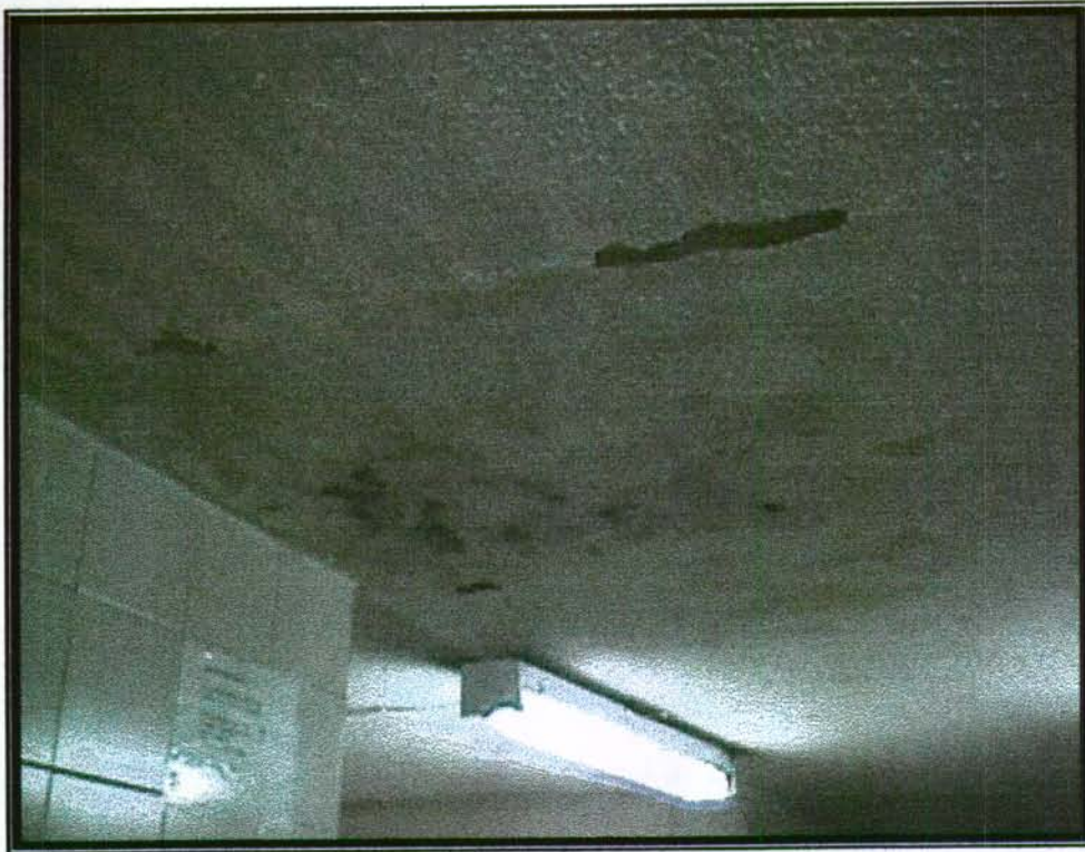
Foto 24. DETERIORO BAJO PLACA – ZONA DE MUROS DE CARGA
