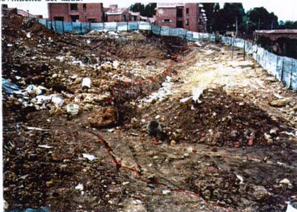
Vista en detalle de las deformaciones que afectaron el talud del proyecto, en la parte posterior del filtro y el muro en tierra reforzada.
