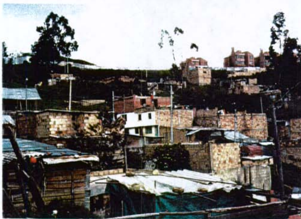
Detalle de las laderas del sector III contiguas al proyecto Urbanístico Monticello, con evidencias de saturación superficial.
