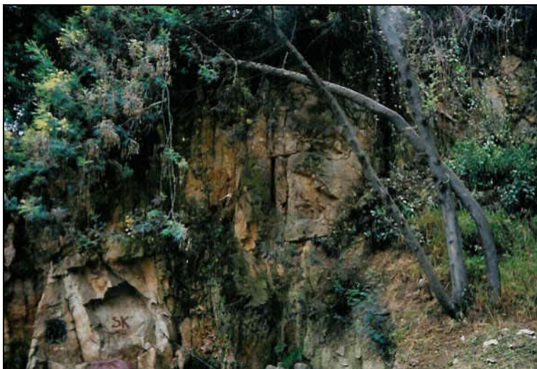
Foto 3. Vista del talud de corte en frente del Conjunto Residencial Aragón; el sustrato de arenisca buza levemente en la misma dirección de la ladera natural, y éste en conjunto con otras familias de diaclasas verticales que generan bloques susceptibles a desprendimientos.
