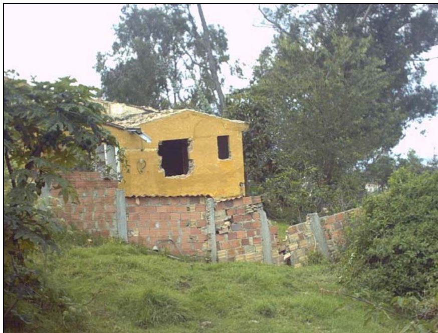
Foto 24. Predio de propiedad del señor Octavio Méndez, localizado en la Carrera 90 No. 157-15. Obsérvese el gran deterioro que ha sufrido la edificación por el movimiento del talud.
