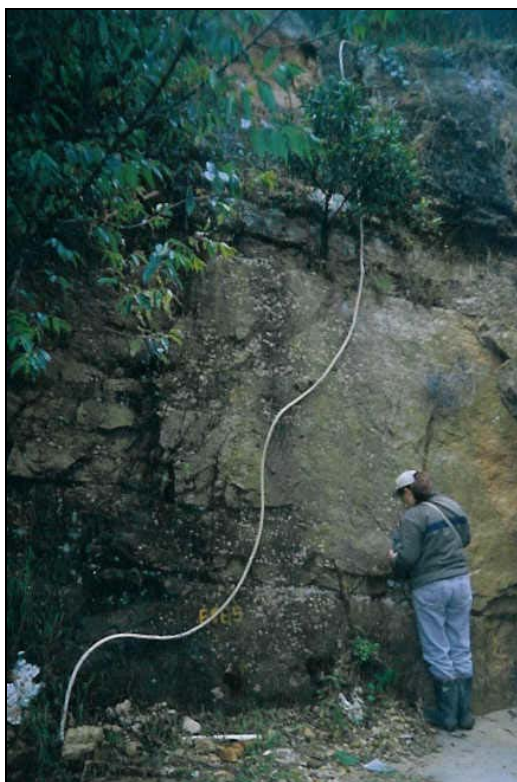
Foto 22. Talud del corte oriental en el interior del Conjunto Residencial Aragón. Se encuentran afloramientos de cuarzo-arenitas intercaladas con capas delgadas del mismo material mas fracturado; se pueden presentar desprendimientos ocasionales de bloques.
