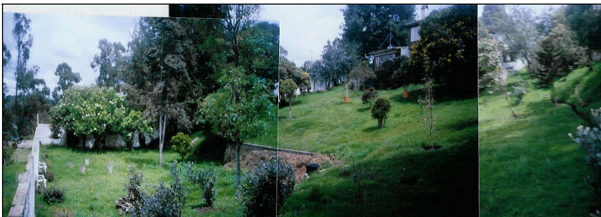
Foto 19. Predio de la señora Carmenza de Yepes, visto desde el lado sur. Allí se encuentran algunos rellenos locales detrás del muro cerramiento y de un muro interno localizado en la parte media de la foto. El agua superficial es conducida a lo largo de un zanjón que se prolonga por el muro oriental (lado izquierdo de la foto), saturando el terreno en la parte baja al otro lado del muro.
