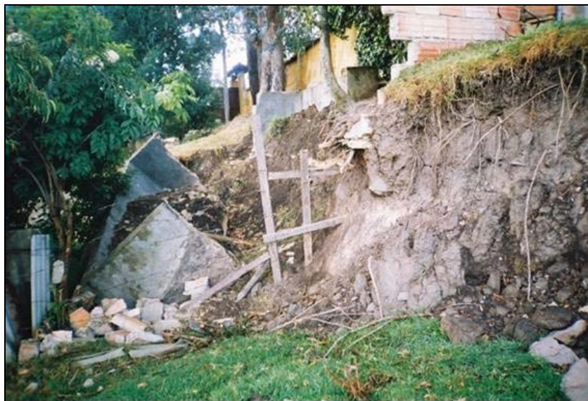
Foto 31. Tanque localizado en el tercer escarpe, al costado sur-occidental de la casa del señor Méndez. Este tanque falló por la pérdida de soporte generada por el hundimiento de falla. Recientemente el tanque se partió por la mitad y cayó a la parte baja.
