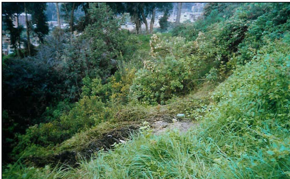
Foto 11. Parte baja de la Zona Geotécnica 2; tomada desde la esquina nor-occidental del predio del señor Octavio Méndez. Se generó un primer deslizamiento rotacional de poca profundidad, que comprometió una capa superficial de coluvión; la pata de este deslizamiento aflora al lado de un parque recreacional adjunto a la Urbanización Aragón.
