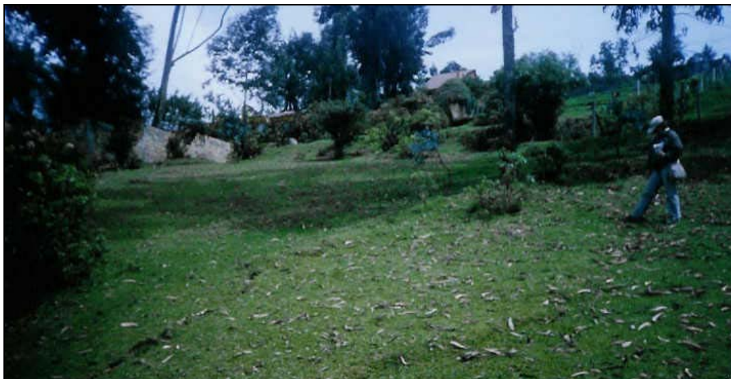
Foto 14. Proyección del segundo escarpe por el costado sur del predio del señor Méndez. Nótese el muro volcado hacia la derecha, al fondo de la foto y la prolongación del escarpe en curva cerrada, justa atrás del sitio donde está parada la Geóloga Pilar García. En este sitio también se genera la corona de un pequeño flujo de tierras, producto de la presencia abundante de agua en el suelo.
