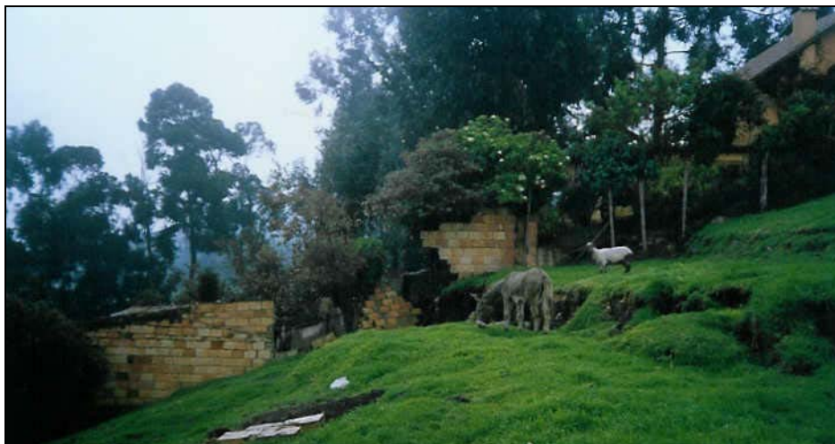
Foto 15. Vista desde el lado sur del lindero oriental del predio del señor Octavio Méndez. Se generó en este invierno (diciembre de 2004), un tercer escarpe de falla que afectó el muro de cerramiento y un tanque de agua potable que se encuentra detrás de este. Al lado derecho, se encuentra otra casaquinta, en la cual ya existe un cuarto escalón que alcanza a afectar el patio trasero de éste casa. Es urgente llevar a cabo medidas de estabilización a corto plazo, con el objeto de frenar el efecto regresivo del deslizamiento.
