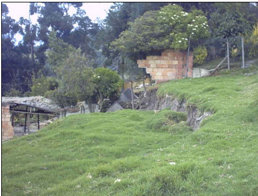
Foto 32. Vista del asentamiento diferencial (aproximadamente 1 m) que afecto la casa del señor Octavio Méndez (al fondo).
