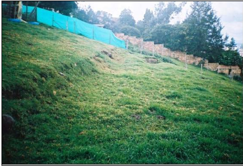
Foto 37. Al costado sur del predio del señor Raúl Cristancho, se está generando un cuarto escarpe que puede afectar la casa quinta; se considera necesario la ejecución de obras antes que el deslizamiento evolucione regresivamente y genere daños sobre esta propiedad.
