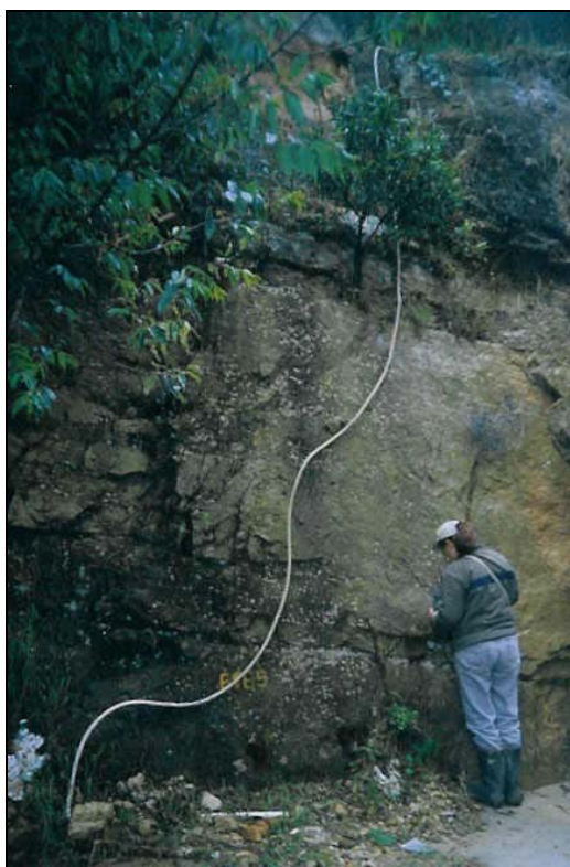
Foto 22. Talud del corte oriental en el interior del Conjunto Residencial Aragón. Se encuentran afloramientos de cuarzo-arenitas intercaladas con capas delgadas del mismo material mas fracturado; se pueden presentar desprendimientos ocasionales de bloques.
