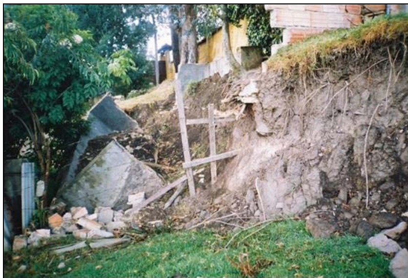
Foto 36. Tanque localizado en el tercer escarpe, al costado sur-occidental de la casa del señor Méndez. Este tanque falló por la pérdida de soporte generada por el hundimiento de falla. Recientemente el tanque se partió por la mitad y cayó a la parte baja.
