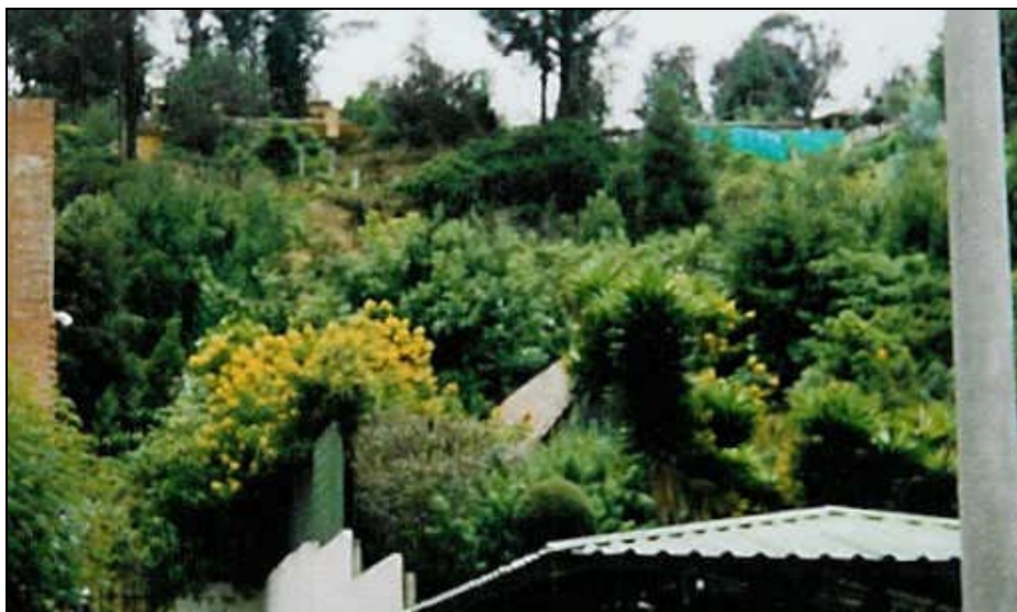
Foto 2. Vista desde la parte baja, de la zona inestable que afecta el predio del Señor Octavio Méndez y zonas adyacentes (foto tomada en el mes de Octubre/2004). Los escarpes insinúan una falla relativamente profunda que en caso de reactivarse puede generar daños de los predios en la parte alta e invadir colegios y urbanizaciones en la parte baja, con un potencial de daño alto.
