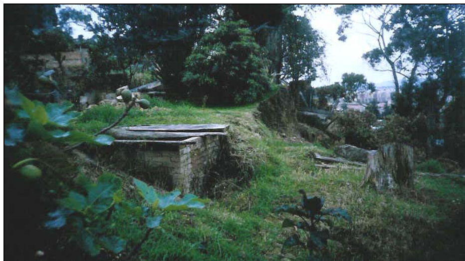
Foto 13. Detalle del segundo escarpe de falla en el interior del patio trasero del señor Méndez. Se generó un escalonamiento del orden de 2 m de altura que coincidió con el sitio de un tanque colector de aguas negras.
