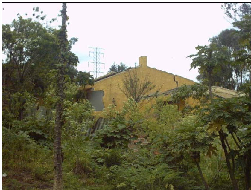
Foto 31. Vista lateral (hacia el norte) de la casa de propiedad del señor Octavio Méndez. La casa se encuentra deshabitada, por los grandes daños ocasionados por el deslizamiento. Obsérvense las fisuras en los muros.
