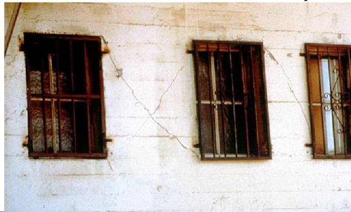
Elemento estructural sometido a tensiones de rotura
