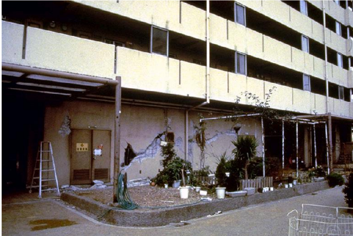
Muros fallados por cortante, Kobe, 1995
