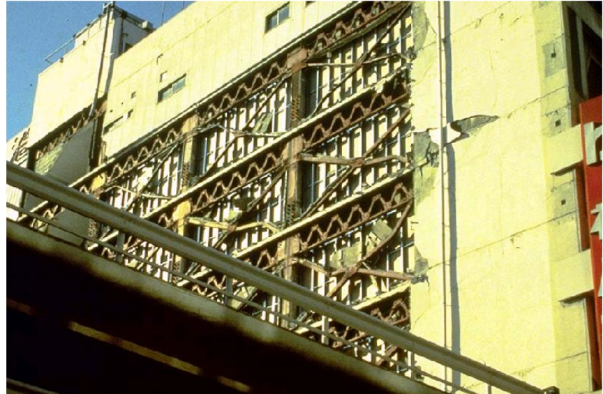
Pandeo de riostras en pórtico de acero. Kobe, 1995
