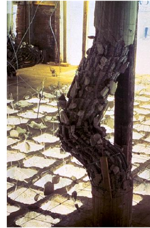
Columna de hormigón, Méjico 1985
