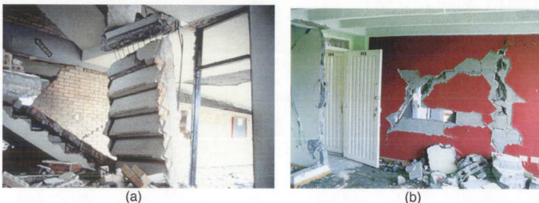
Figura 3-2: Daños en elementos no estructurales. (a) Escaleras, (b) Muros divisorios
