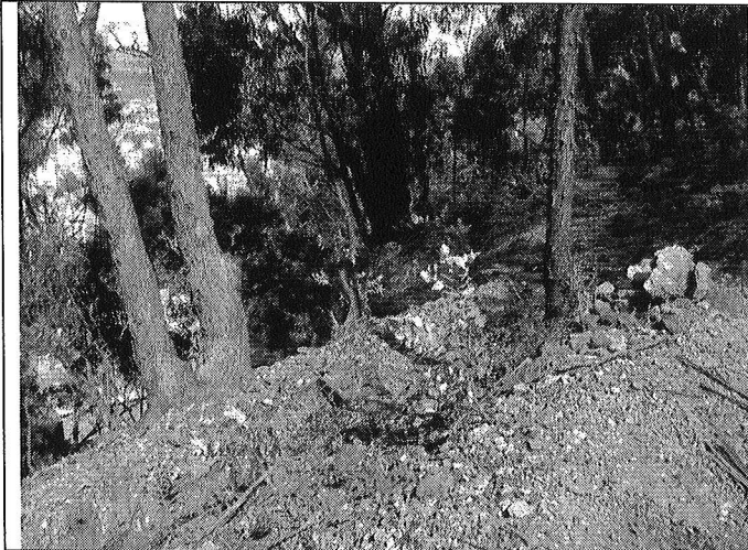
Foto 5. Vista de la parte alta del talud de corte evaluado, ubicado al costado oriental del predio de la Transversal 2 Este No. 78-03, Barrio Los Rosales de la Localidad de Chapinero.
