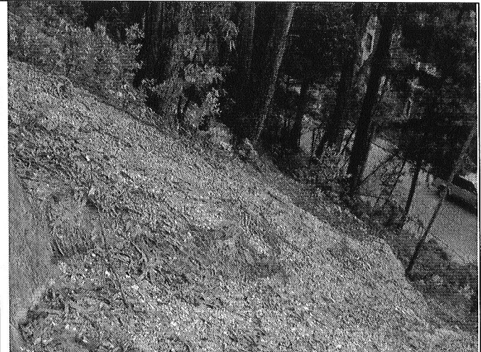
Foto 6. Parte media del talud de corte evaluado, ubicado al costado oriental del predio de la Transversal 2 Este No. 78-03, Barrio Los Rosales de la Localidad de Chapinero, de corte, donde se observa la meteorización de la arenisca.
