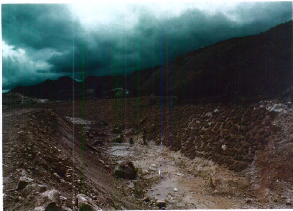
FOTO 10. Proceso de revegetalización del talud con cespedón. Finalmente se tendrá una cobertura del 100%.
