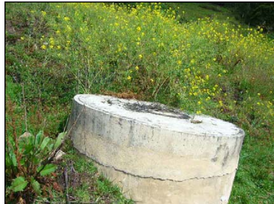
Fotografía 8 Detalle inclinación del pozo de alcantarillado en Betania II
