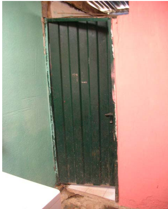
ZONA INTERIOR DEL PREDIO 0010, PRESENTA GRIETAS Y DESCUADRE EN LAS PUERTAS Y VENTANAS
