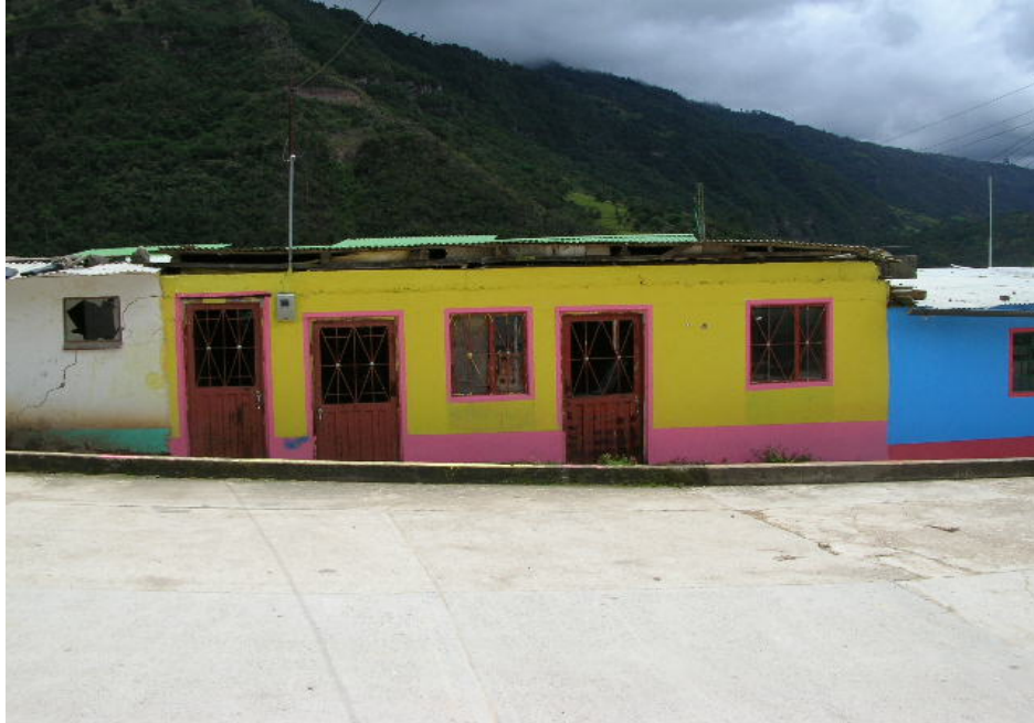
PREDIO 0012, ZONA CONSTRUIDA EN MAMPOSTERÍA NO REFORZADA, PRESENTA GRIETAS LONGITUDINALES EN LA PARTE SUPERIOR, FOTOGRAFIA VISTA HACIA EL SUR-ESTE
