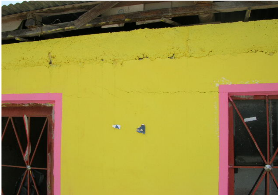
GRIETAS LONGITUDINALES EN LA FACHADA PRINCIPAL DEL PREDIO
