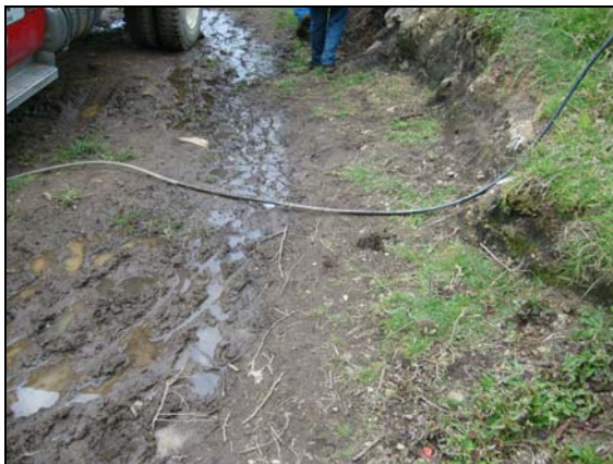
Fotografía 5 Fuga de agua en el pie del Talud, del Sitio Betania I
