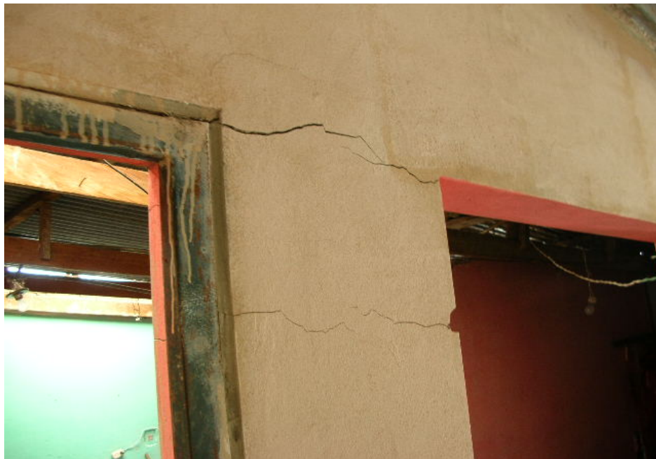
GRIETAS EXISTENTES EN LA ALCOBA PRINCIPAL
