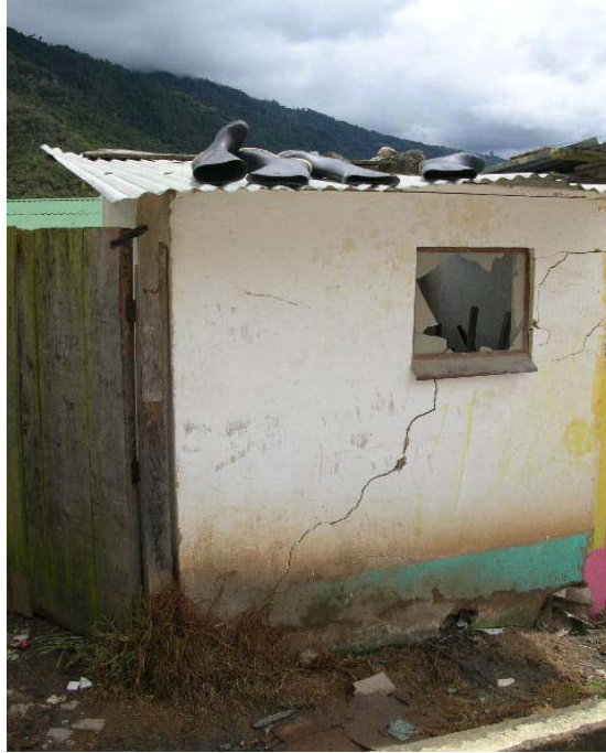
PREDIO 0011, ZONA DEL LOTE CONSTRUIDO EN MAMPOSTERIA NO REFORZADA, PRESENTA GRIETAS DIAGONALES, FOTOGRAFIA VISTA HACIA EL SUR-ESTE
