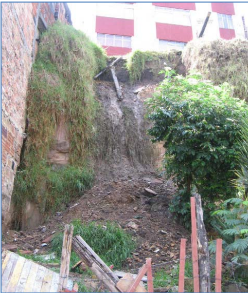
Foto 3. Evento del 1 de noviembre de 2006 – Predio en el que se presentó la falla del talud de corte generando desprendimientos de suelo
