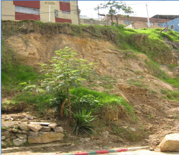
Foto 10. Vista del movimiento de inestabilidad (deslizamientos y desprendimiento de suelos, junto con la caída de rocas y detritos embebidos dentro de la roca meteorizada) reciente ocurrido en el sector oriental de la zona de estudio. Obsérvese en la parte media inferior del escarpe el depósito de coluvión reciente, igualmente afectado por un movimiento más reciente.
