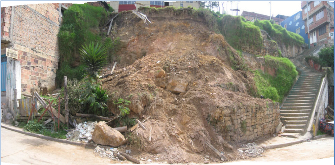
Foto 5. Aspecto del talud el 4 de diciembre de 2006 – Predio de la Carrera 17A No. 33B – 50 Sur en el que se presentó la falla del talud de corte generando desprendimientos de suelo y bloques de roca que afectaron la transitabilidad de la Carrera 17A entre Calles 33B Sur y 34 Sur.
