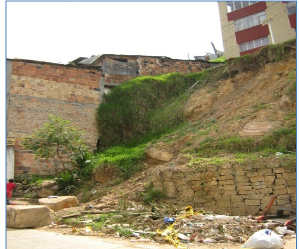
Foto 11. Vista de detalle del deslizamiento. Obsérvese en la parte superior del sitio inestabilizado y a cierta distancia, una construcción de varios pisos; en la parte inferior derecha un muro en gaviones; en la orilla de la vía depósitos de escombros y algunos bloques rocosos.
