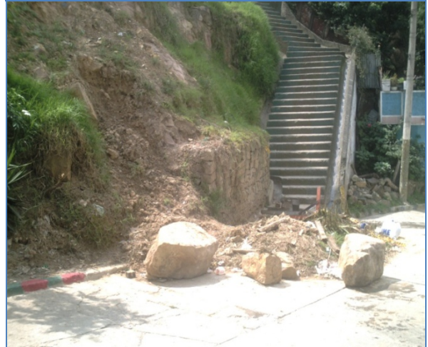
Foto 7. Se ilustra la caída de rocas y detritos a la vía.
