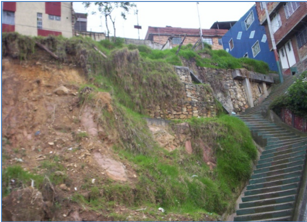
Foto 1, Vista del muro de piedra pegada construido en el costado oriental de la zona de estudio.
