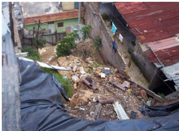
Foto 1, Zona inestable con presencia de material de escombros.
