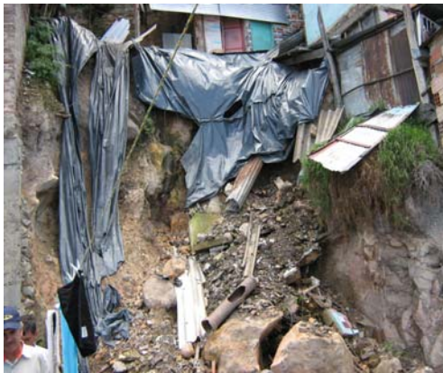
Foto 7. Obsérvese el material producto de la caída de rocas y detritos; en las partes laterales afloramientos de rocas de composición arenacea.
