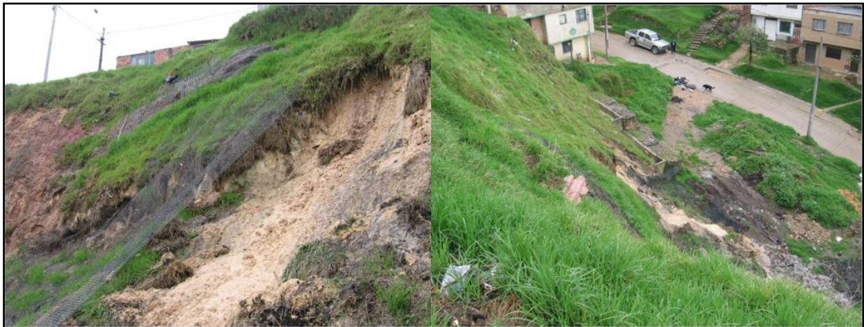
Foto 3 Detalle de las afectaciones en la parte superior frente a la carrera 18 K
