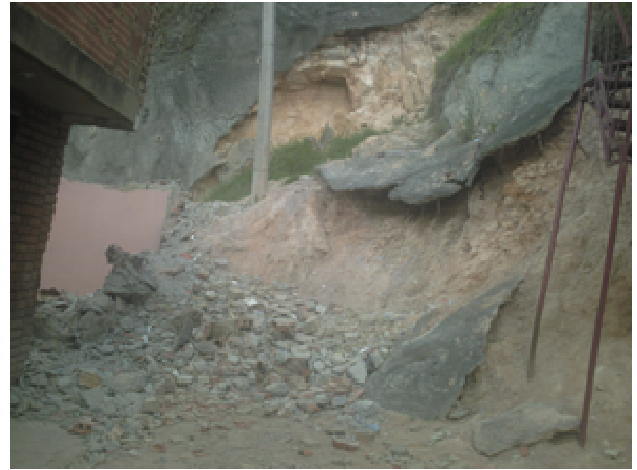
Foto 8. Afectación de la obra de mitigación existente en la zona norte.
