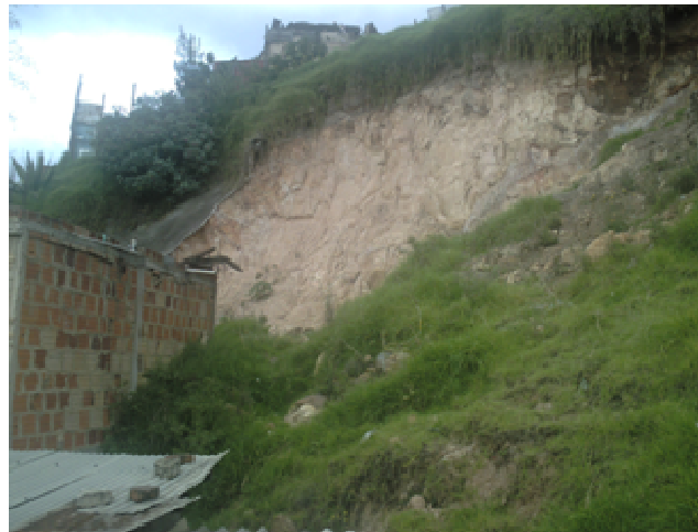
Foto 20. Viviendas ubicadas en la corona del talud norte.
