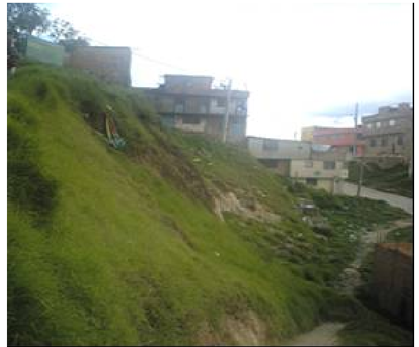
Foto 6. Viviendas afectadas den la pata del talud de la zona norte
