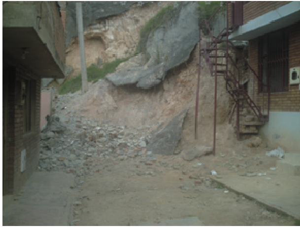
Foto 7. Viviendas afectadas den la pata del talud de la zona norte
