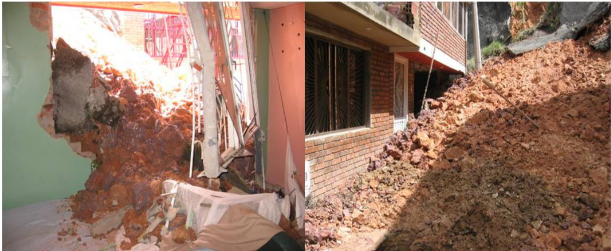
Foto 4. Detalle de las afectaciones en la parte anterior del predio (1) del Señor Luís Rodríguez.
