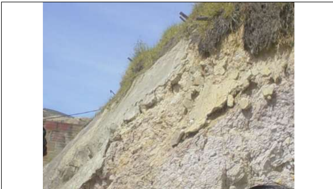
Fotografía 3-3 Desprendimiento de recubrimientos de cespedón y malla mortero.
