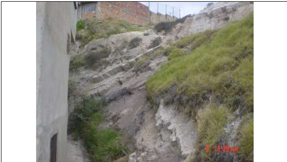
Fotografía 4-1 Areniscas fracturadas con posibilidad de desprendimiento de bloques en el corte ubicado hacia el occidente de la zona de estudio. Nótese la desfavorabilidad del corte paralelo a la dirección en que se tomó la fotografía.
