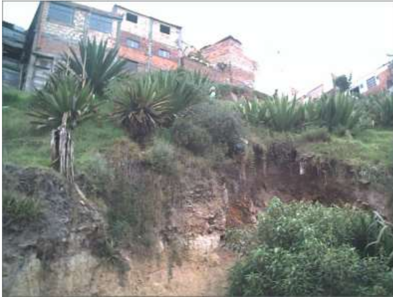
Fotografía 3-10. Pequeño deslizamiento ubicado en la interfase coluvión - arenisca brechada - arcillolita.
