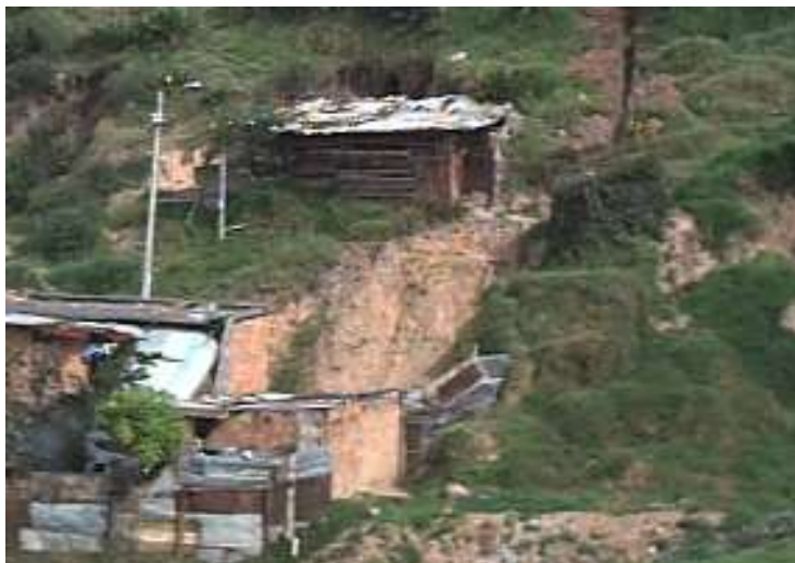
Fotografía 3-8. Panorámica del Deslizamiento 2. La casa en la parte superior vertía aguas incontroladamente que alimentaron materiales susceptibles (a la erosión las arenas de la parte alta y al flujo los residuales arcillosos de la parte baja) que fueron destapados en los cortes
