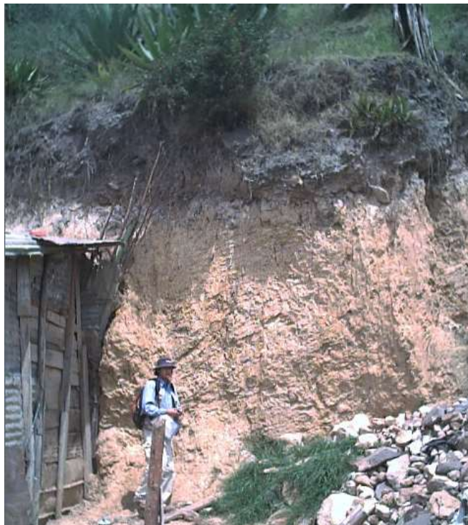
Fotografía 3-11. Desprendimientos de coluvión y flujos menores, asociados con desgate de talud y saturación de materiales en las épocas de lluvias.
