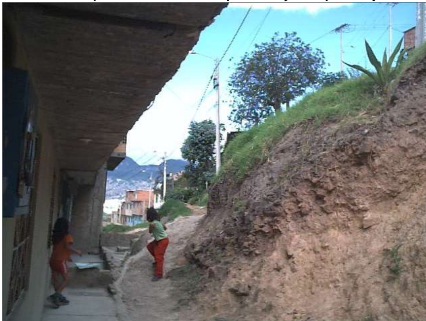
Fotografía 3-9. Despate del talud, quitando el coluvión antiguo que es el material de mejores condiciones de resistencia. Parte baja del Deslizamiento 2.
