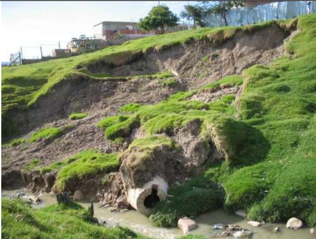
Fotografía 4-2. Evidencia de socavación lateral por parte de la quebrada Yomasa.
