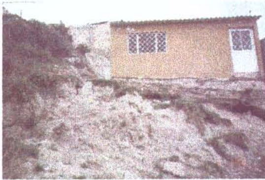
Erosión y Socavamiento
