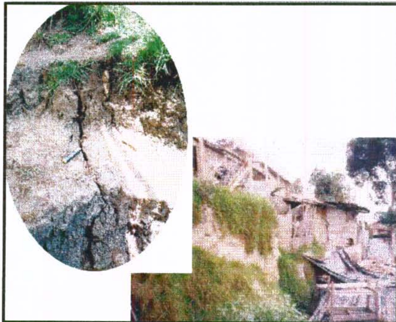
Foto 3-4. 1. Cortes y rellenos típicos realizados en las partes altas del área de estudio. Obsérvese el detalle, donde se están formando grietas por el desconfinamiento y el proceso de secado humedecimiento del suelo, que posteriormente forman “bloques de suelo” que se pueden desprender y afectar las viviendas vecinas.
