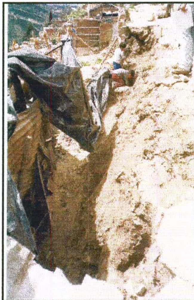
Foto 3-1. 5. Problemas típicos presentados en la zonas de pendiente alta a muy alta (mayor a 30°) en la zona de estudio.
