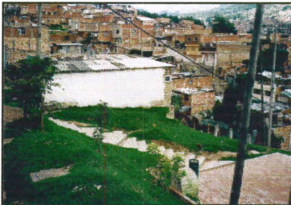
Foto 3-2. 2. Viviendas afectadas por el movimiento del denominado Sector 1.
