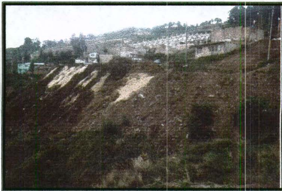
Foto No. 4. 5 Relleno de origen antrópico cuyos materiales son principalmente corresponden a escombros de construcción. Tiene un espesor, que alcanzando hasta los 10 metros. Este relleno se ha deslizado.
