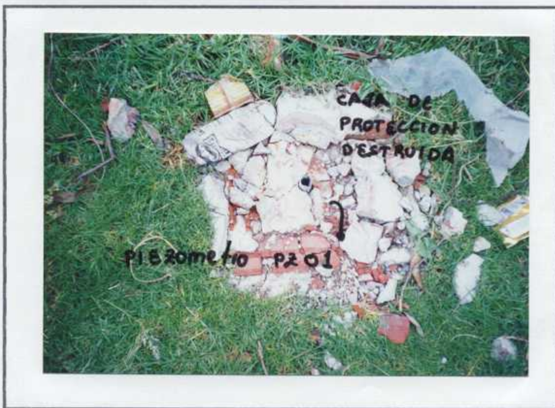
FOTOGRAFIA No 3. PIEZOMETRO PZ01 A 11.0 METROS. NOTESE LA DESTRUCCION DE LA CAJA DE PROTECCION
