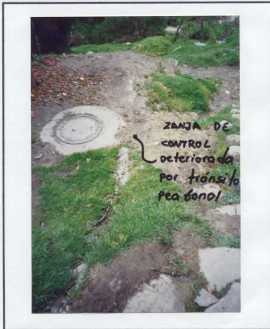
FOTOGRAFIA No 5. LOCALIZACION ZANJAS DE CONTROL EN MORTERO, NOTESE SU DESTRUCCION POR TRANSITO DE PERSONAS
