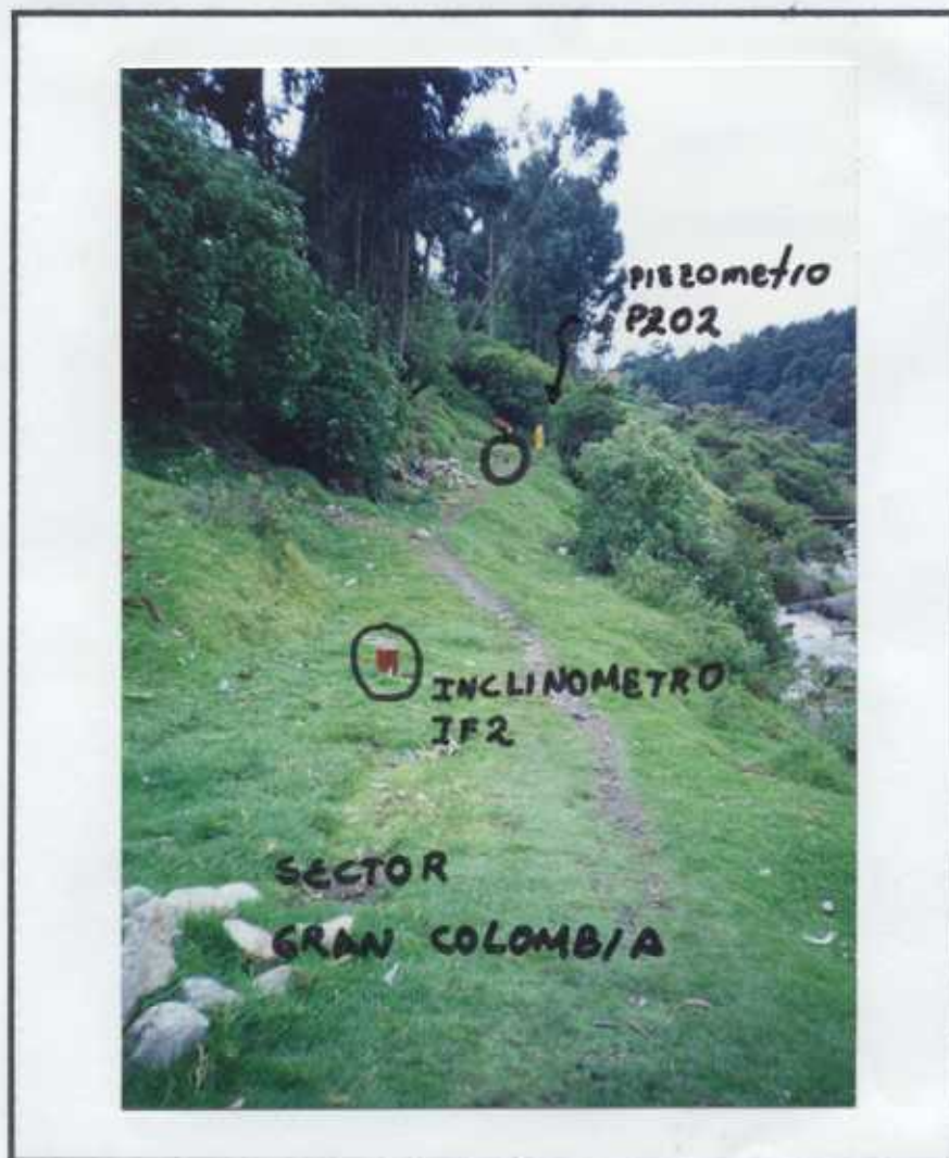
FOTOGRAFIA No 2. LOCALIZACION INCLINOMETRO IF2, PIEZOMETRO PZ02. INSTRUMENTOS EN BUEN ESTADO FUNCIONAL SECTOR GRAN COLOMBIA
