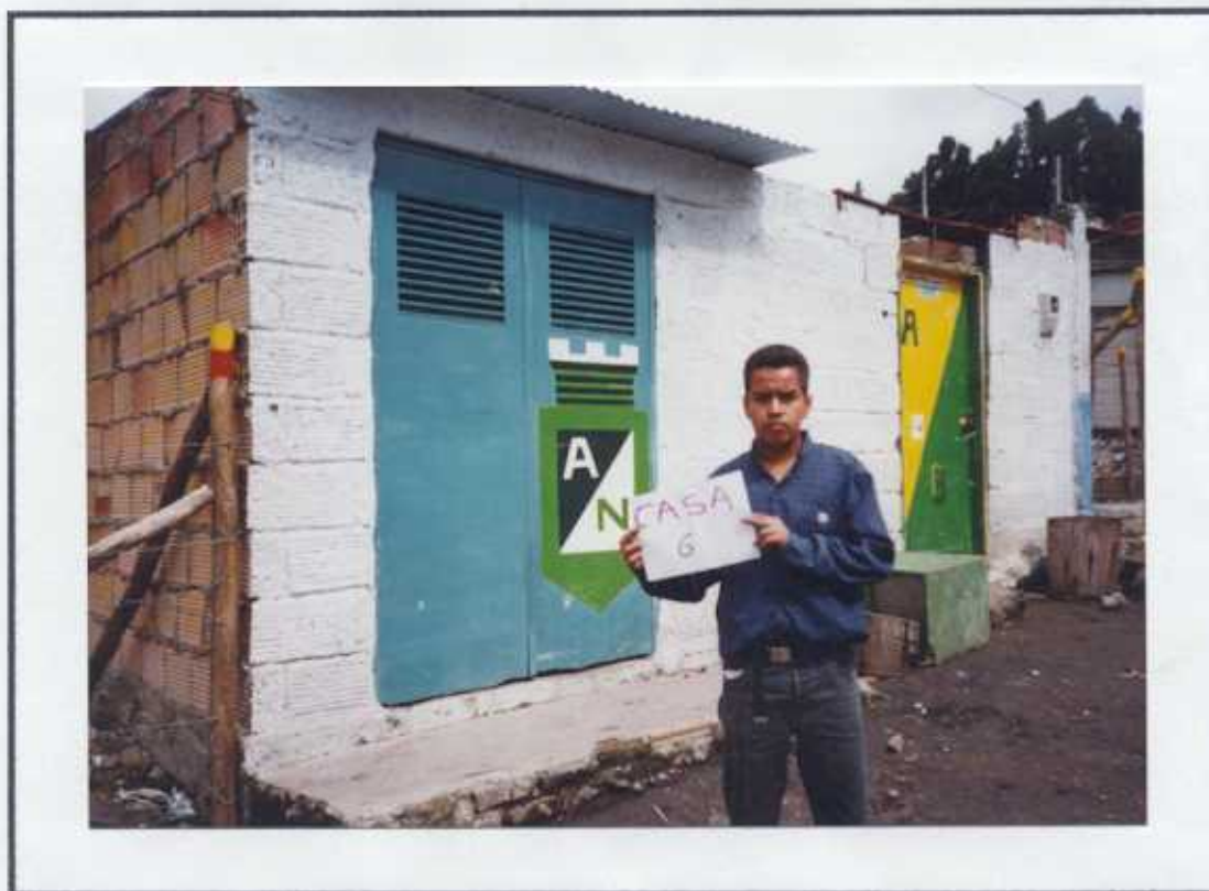
FOTOGRAFIA No12 CONTROL ESTRUCTURAL A VIVIENDAS CASA No 6 Sector Manila (Zona Activa) Demolición de casas vecinas
