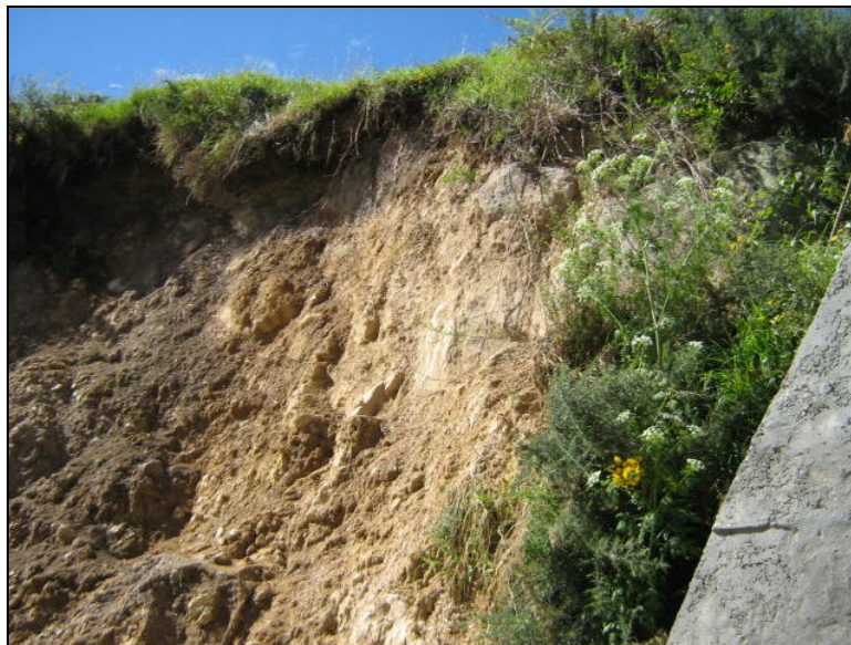
Fotografía No. 2 - Detalle de la fotografía anterior, en el escarpe o corona del sitio inestable. Nótese la coloración del material hacia la parte superior. También la presencia de bloques grandes.
