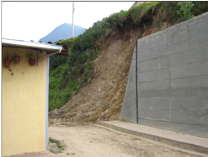
Fotografía No. 6 – Detalle de la parte Terminal del muro y proceso inestable a continuación.
