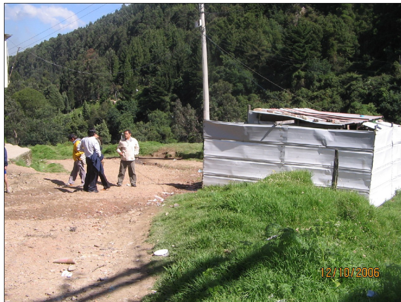
Fotografía No. 16 – Vía en la parte superior del talud inestable
