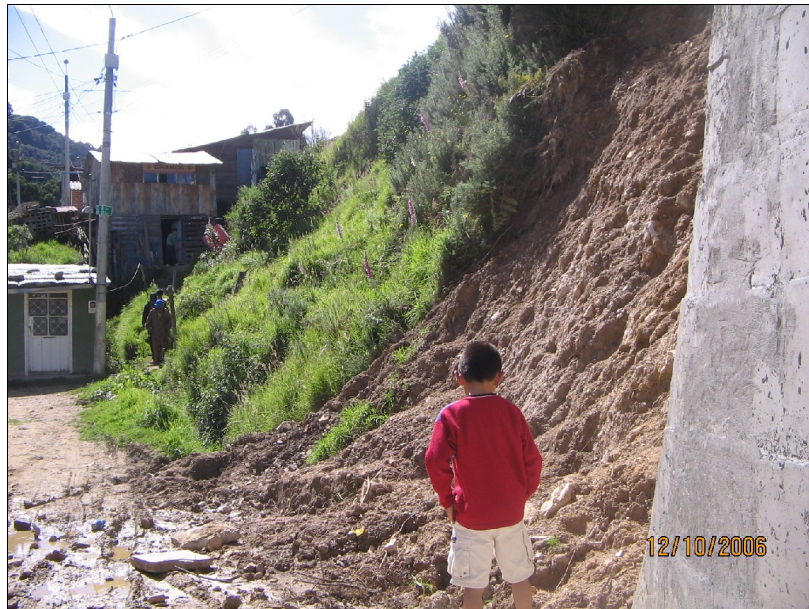
Fotografía No. 10 - Otro aspecto de todo el talud inmediatamente termina el muro existente
