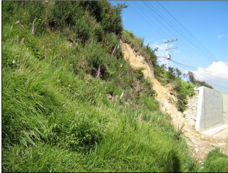
Fotografía No. 3 – Vista lateral del muro de Concreto, y la zona inestable que se deriva inmediatamente se pierde el confinamiento de la estructura.
