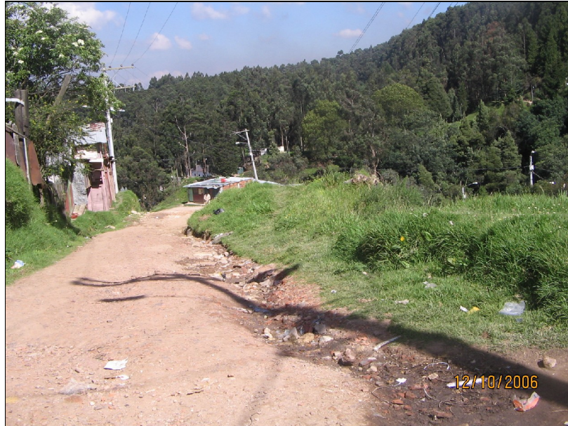
Fotografía No. 13 – Otra Panorámica del Terreno a lo largo de la calle localizada por encima del Talud inestable
