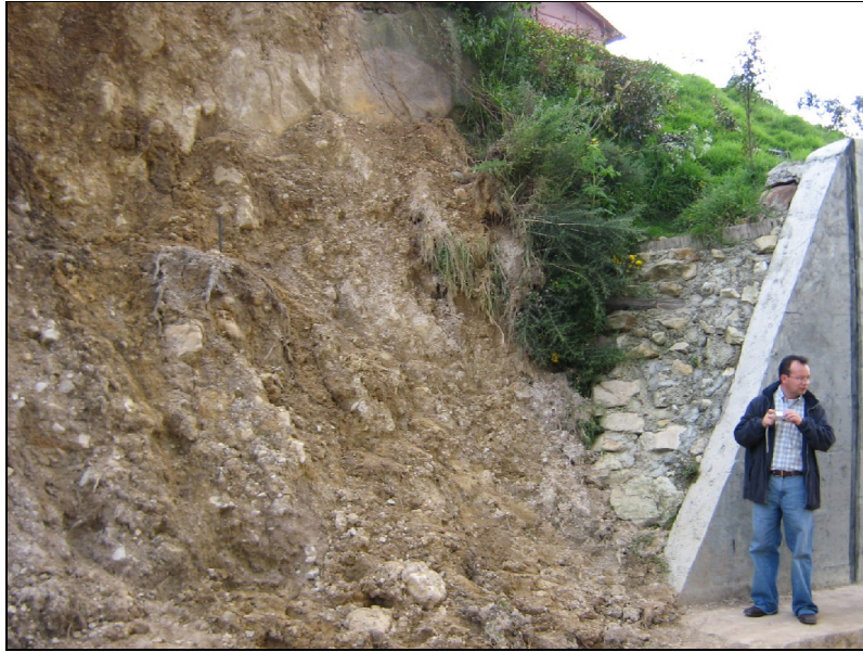
Fotografía No. 7 – Borde Terminal del Muro, con material llenante y de carga. Inmediatamente, se aprecia el primer sitio o movimiento segregado desde el talud de corte no confinado. Obsérvese adicionalmente el tamaño de los bloques matriz soportados.
