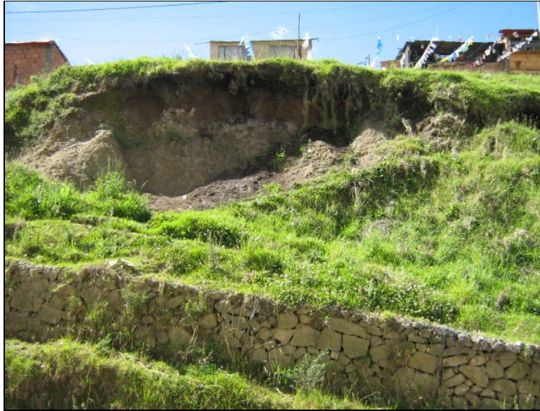
Fotografía No. 5 - Escarpe o corona de Movimiento en Masa relacionado al talud de corte de la vía. Por encima se prolonga el desarrollo de la urbanización. En algunos sitios se aprecian mangueras y conducciones enterradas. No se apreciaron escapes o fugas de agua..
