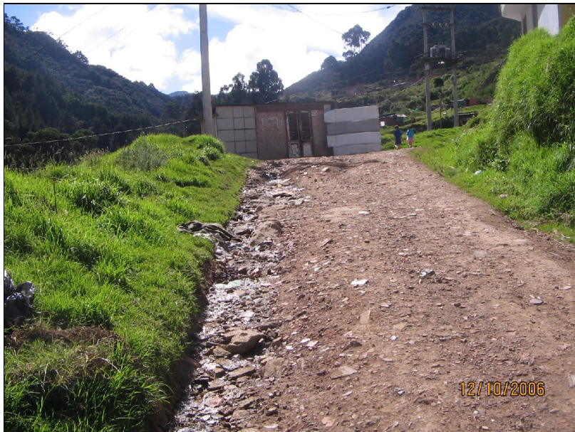
Fotografía No. 12 – Panorámica del Terreno a lo largo de la calle localizada por encima del Talud inestable. Obsérvese la humedad por ausencia de cunetas en la vía.
