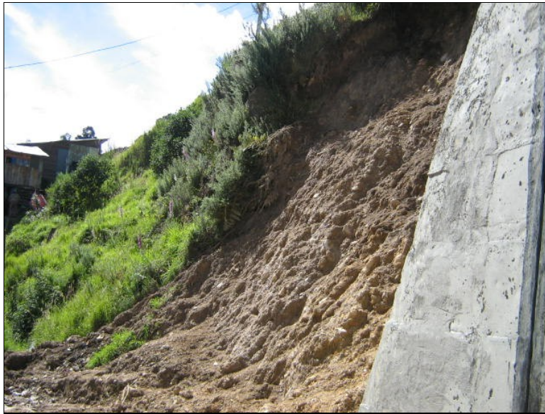
Fotografía No. 1 – Inestabilidad localizada inmediatamente a la terminación superior del Muro. Obsérvese material heterogéneo de bloques y guijarros líticos en matriz arcillo –limosa. La parte superior en tonos amarillo y naranja claro, abajo en tonos más oscuros.
