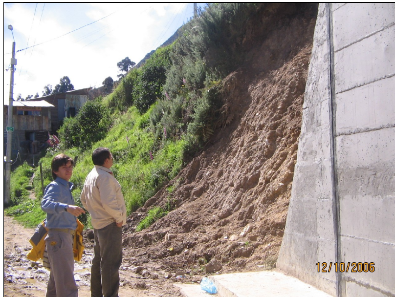
Fotografía No. 8 – Otro aspecto de la parte Terminal del muro y proceso inestable a continuación.
