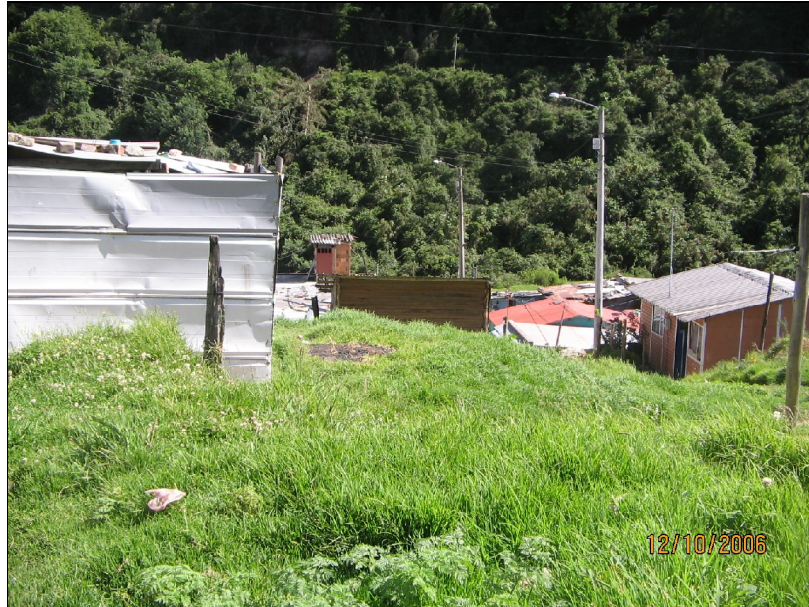
Fotografía No. 17 – Viviendas localizadas en la parte baja del talud adyacente a la zona inestable
