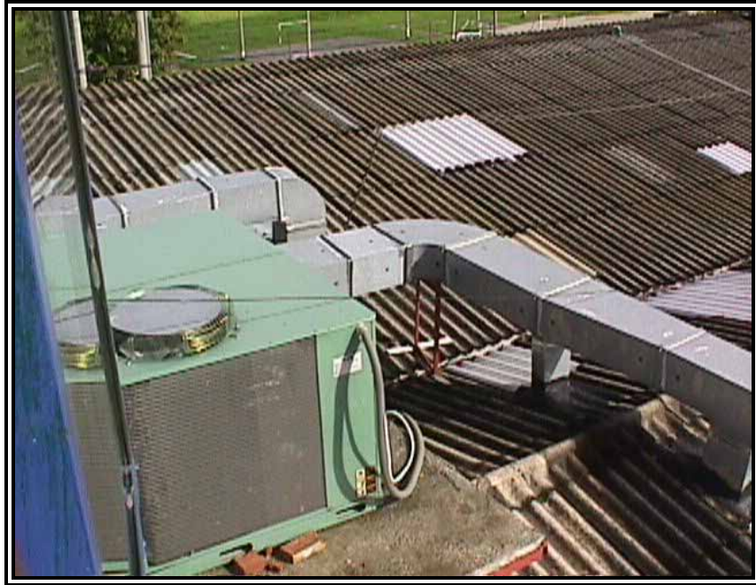
SISTEMA DE VENTILACIÓN
