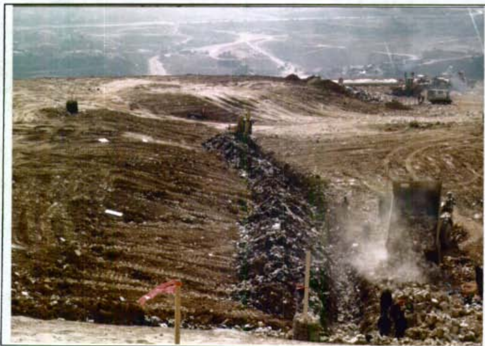
Fotografía # 17: Conformadas las celdas se procede con la construcción de los filtros de comunicación entre niveles, removiéndose la capa de cobertura y llenando la zanja con piedra rajón. (DJ#6 - 28-28A)
