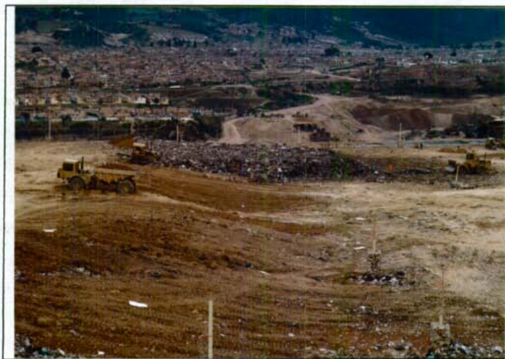
Fotografía # 16: Conformación de las celdas diarias, procediéndose a la cobertura total de las basuras dispuestas cada 24 horas. Adicionalmente se observa la localización de las chimeneas de ventilación. (DJ#3 - 26-26A)
