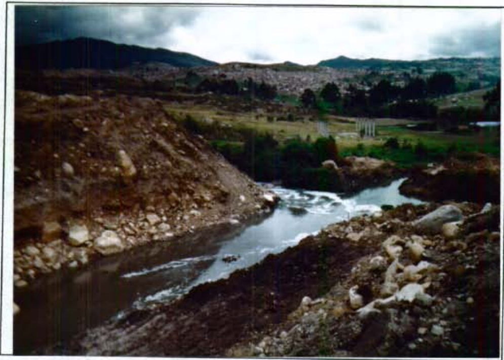
Fotografía # 37: Canal de desvío del Río Tunjuelito en la pata del derrumbe desde la desembocadura de la quebrada Yomasa. (DJ#4 - 19A-20)
