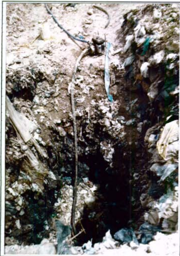
Fotografía # 24: Instalación de bomba con motor a gasolina para el drenaje de los pozos excavados durante los estudios de aprovechamiento del bio-gas. (DJ#3 - 9A-10)
