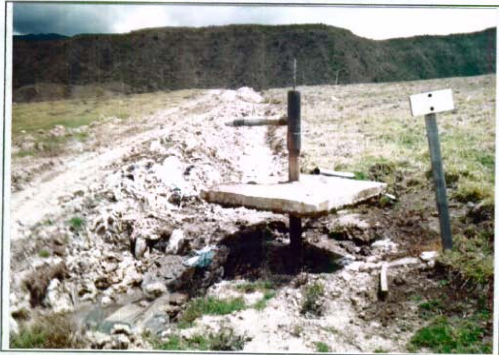
Fotografía # 32: Detalle que muestra los asentamientos presentados en el Relleno, zona I. (DJ#3 -4A-5)
