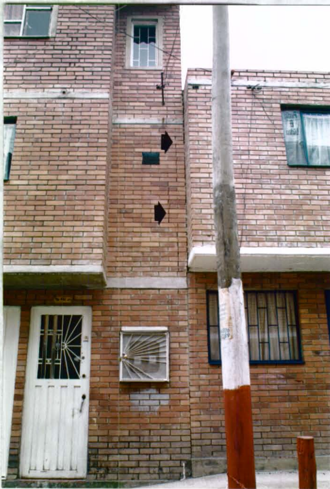
FOTOGRAFIA 21. Carrera 29 F #91F 43 Sur Int. 5. Las grietas en esta edificación afectan principalmente la segunda planta.
