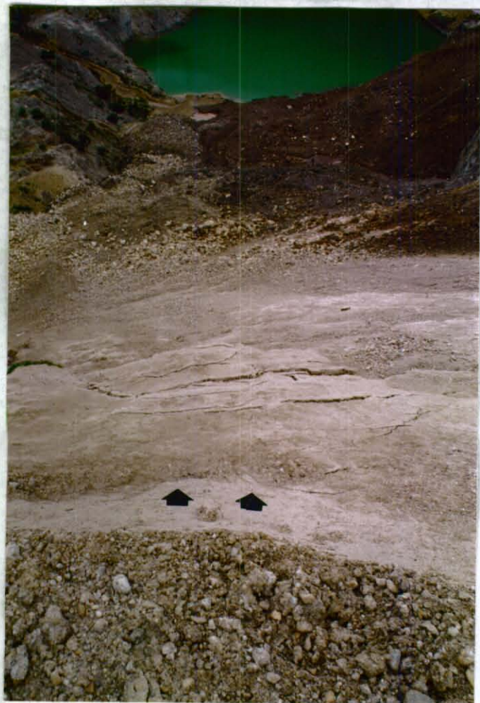
FOTOGRAFIA 5. Fotografía tomada en el sitio de relleno localizado en la esquina de la calle 91B Sur con la Avenida Boyacá (Sector Sur Occidental de la cantera). Nótese la formación de grietas producto de la sobre acumulación de materiales y la poca estabilidad que brinda este tipo de relleno.
