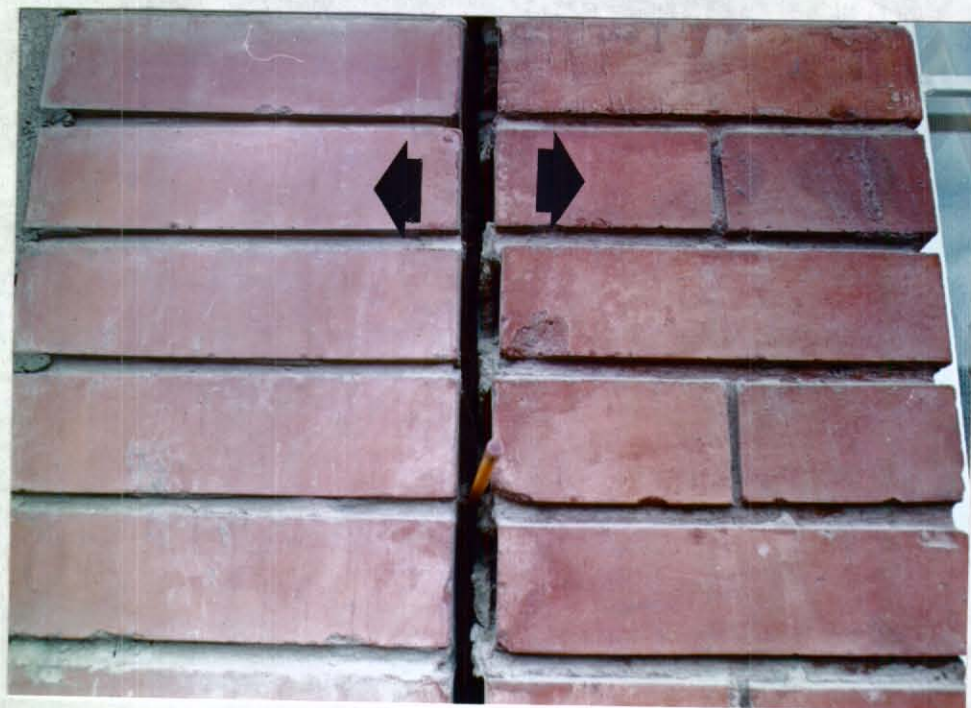
FOTOGRAFIA 15. Detalle de la fotografia anterior, aspecto de la separación entre las viviendas (1,6 cm).
