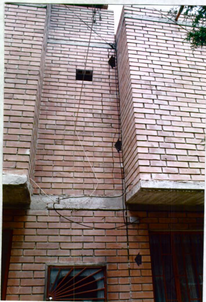
FOTOGRAFIA 19. Carrera 29 Este # 91 F - 78 Sur. En algunos casos las grietas no se presentan de un solo lado de la zona de división de 2 viviendas. Nótese como las grietas afectan ambas edificaciones (posible movimiento con arrastre diferencial).
