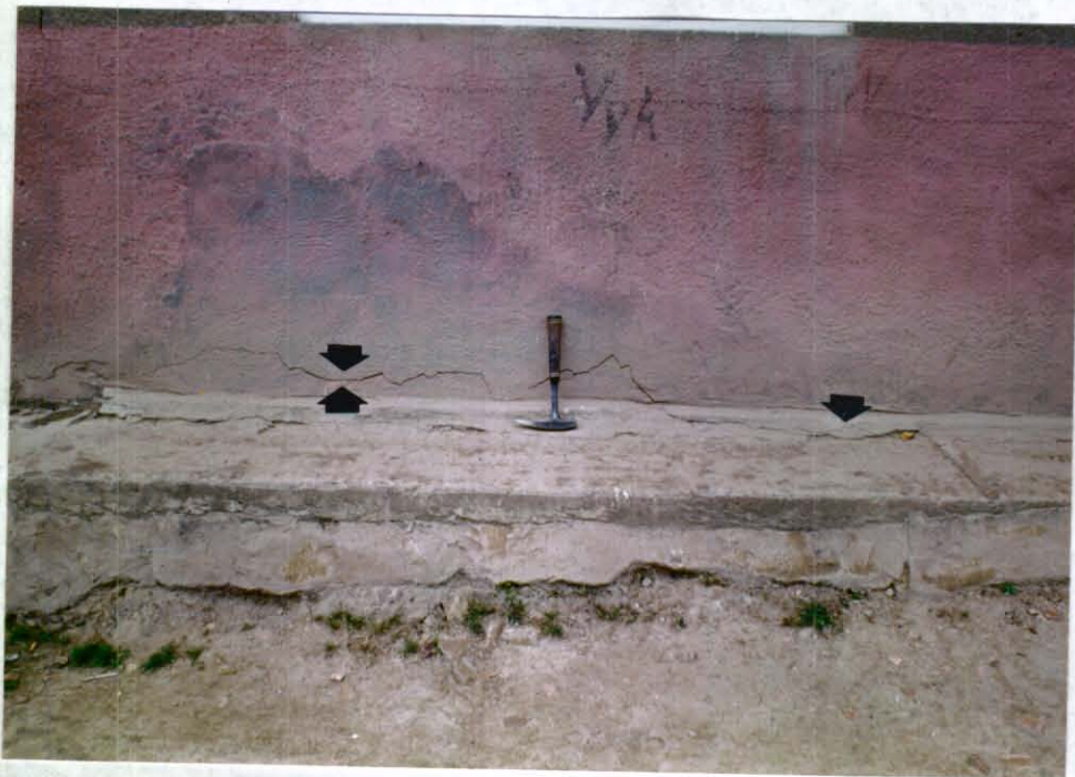
FOTOGRAFIA 22. Calle 918 Sur. El agrietamiento al nivel de andenes y edificaciones es ahora mas evidente y mayor a 0,7 cm.
