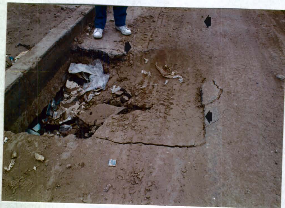
FOTOGRAFIA 6. Calle 91B Sur Carrera 31 Este, parte Suroccidental de la cantera. Los trabajos de adecuación de la red de alcantarillado han producido daños y hundimientos en la vía sobre la zona del gasoducto, en la actualidad este colector de aguas lluvias esta fuera de servicio y taponado con basuras.
