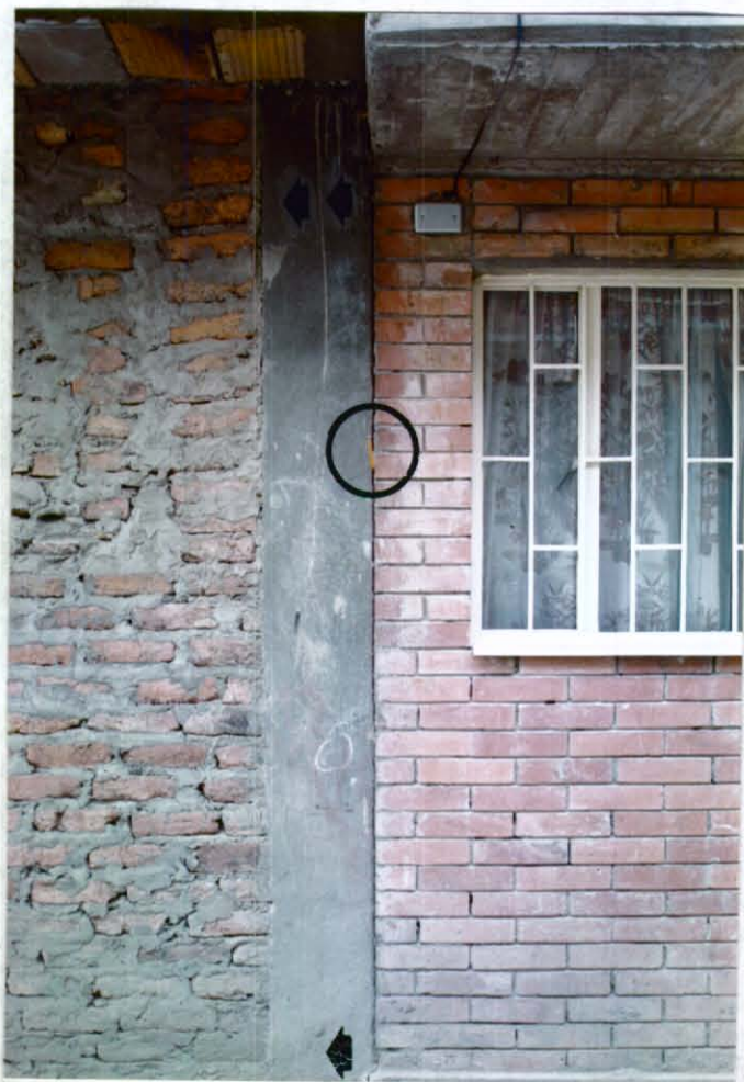
FOTOGRAFIA 16. Carrera 30B Este # 91K 35 Sur. Han aparecido grietas de separación entre la primera y tercera casa inmediatamente contiguas a la calle 91B Sur. Estas grietas no se presentaban en 1992.
