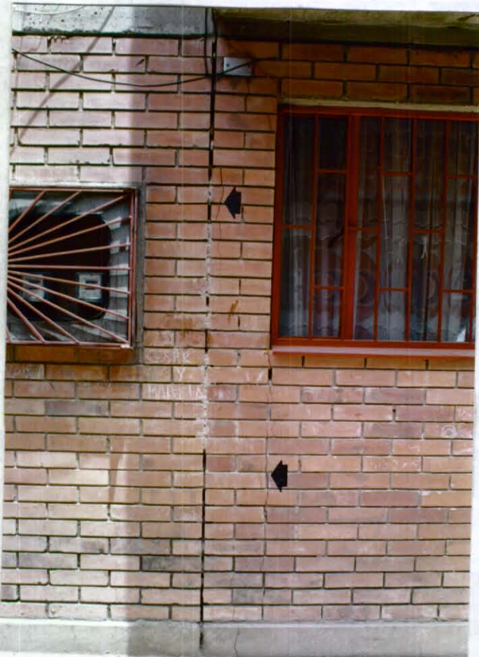
FOTOGRAFIA 20. Las grietas en esta edificación están afectando exclusivamente la planta baja.
