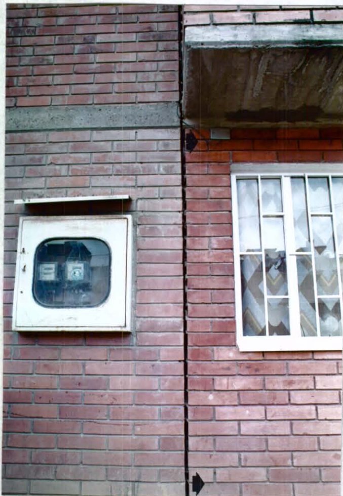
FOTOGRAFIA 14. Carrera 29A Este #91K 23 Sur. La aparición de nuevas y amplias grietas de separación entre edificaciones es preocupante. El asentamiento del suelo es relativamente rapido teniendo en cuenta el tipo de material que conforma el subsuelo (gravas gruesas clasto soportadas).
