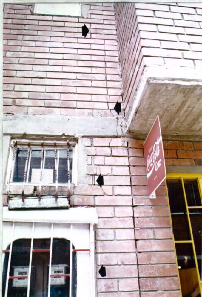
FOTOGRAFIA 13. 9/12/26 Carrera 30A Este #91K 23 Sur. El agrietamiento en este sector de los conjuntos de viviendas es nuevo y afecta indiferenciadamente los muros exteriores e interiores de la primera y segunda planta.
