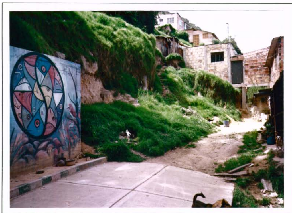
Foto No. 17. Barrio Ayacucho. Viviendas afectadas por desprendimientos de materiales, se recomienda prolongar el muro.
