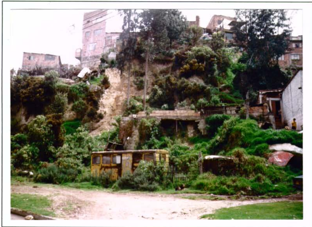
Foto No. 7 Barrio Montecarlo. Talud inestable y expuesto a la erosión en la Calle 12 Sur con Carrera 12 Este
