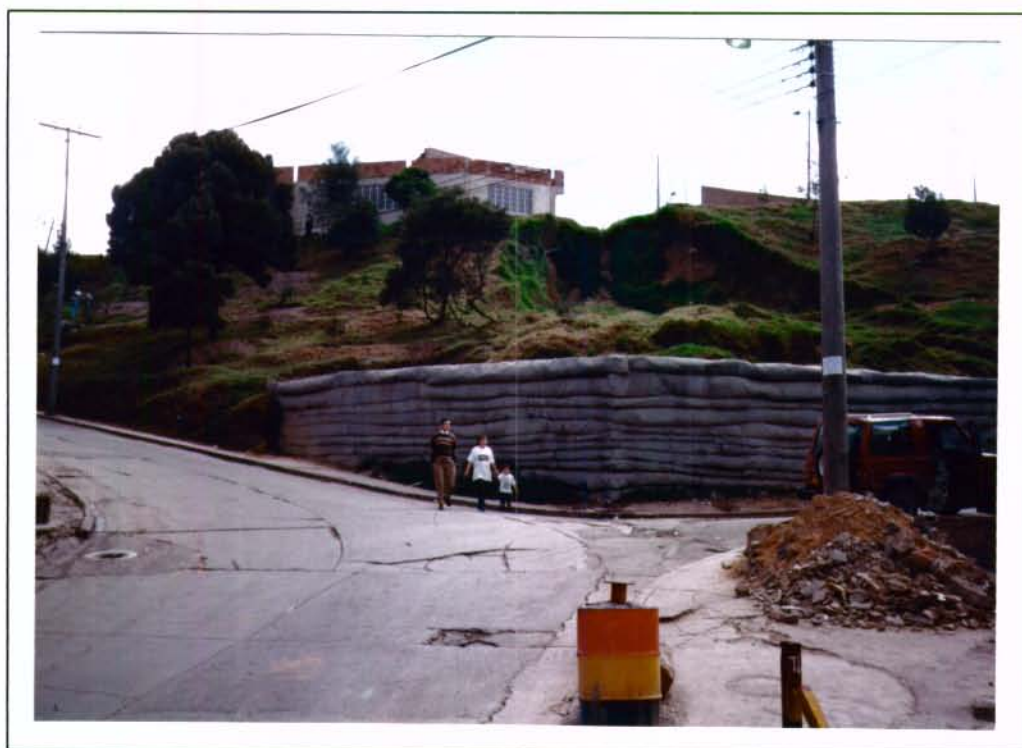
Foto No. 20: Barrio Guacamayas. Deslizamiento en la zona verde del barrio.
