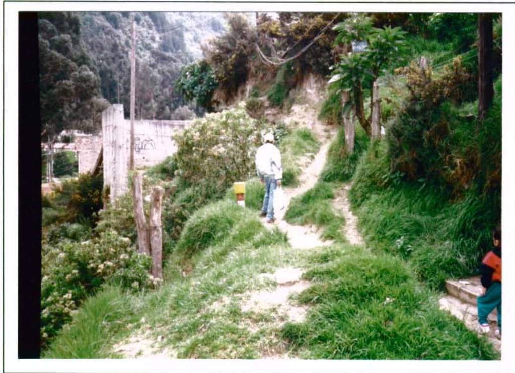
Foto No. 6 Barrio Montecarlo. Calle 8 Sur entre Carreras 15 y 15 A Este.- Observar el muro de contención y el escarpe en la parte superior de la vía
