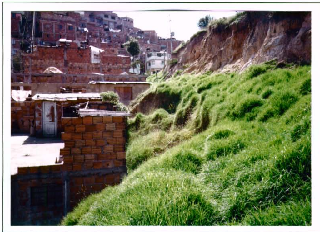
Foto No. 19: Barrio Barcelona Sur. Viviendas ubicadas en la parte inferior de un escarpe que ha presentando caídas y deslizamientos traslacionales de roca y suelo
