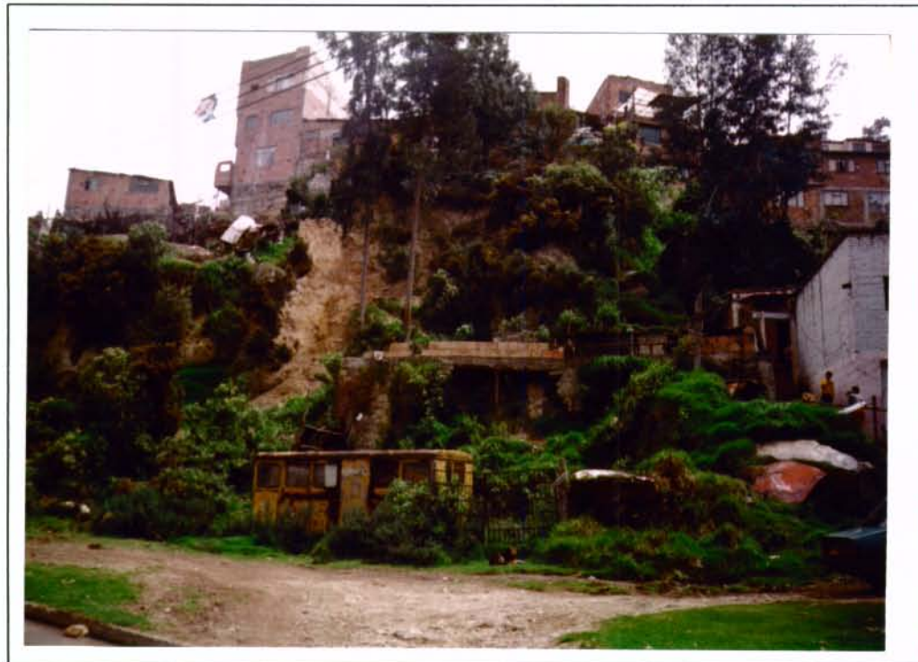
Foto No. 9: Barrio Montecarlo- Quebrada Pichosa. Viviendas agrietadas y abandonadas
