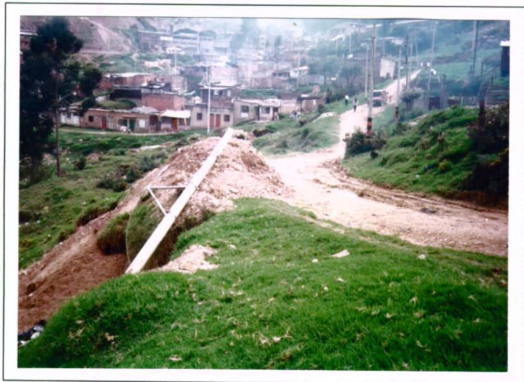
Foto No. 11: Barrio Ramajal. Deslizamiento que afecta una vía de acceso al barrio. Observar el poste de energía colapsado por el fenómeno
