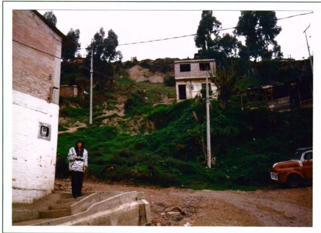
Foto No. 1: Barrio Corinto. Observar el talud inestable por debajo del escarpe principal. El poste de energía superior se encuentra cerca de la vía constantemente amenazada
