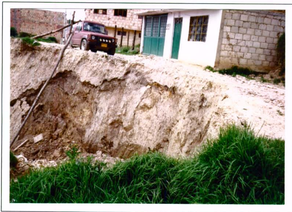
Foto No. 14: Barrio Nueva España. Escarpe principal del deslizamiento activo de la Calle 38 Sur con Carrera 12 G.
