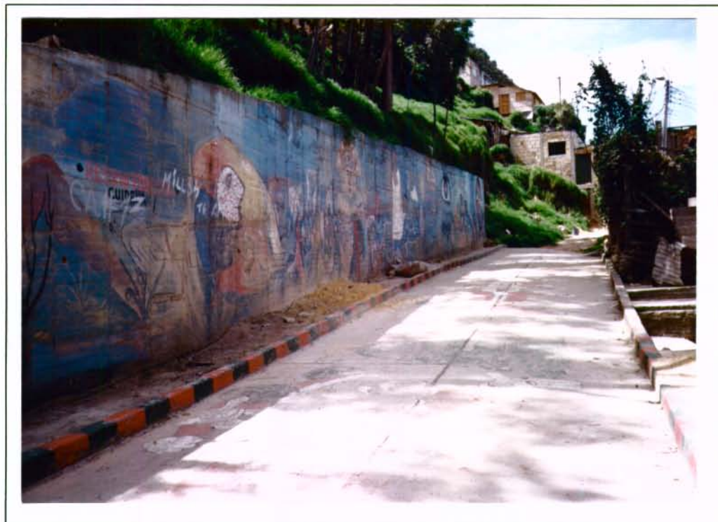
Foto No. 16. Barrio Ayacucho. Muro de contención sobre la Calle 39 A Sur entre las Carreras 5 y 6 Este.
