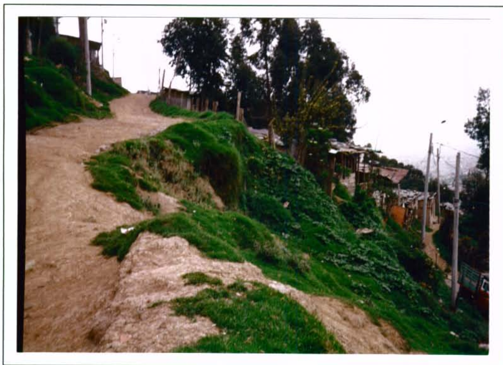
Foto No. 2. Barrio Corinto. Vía afectada por los flujos de tierra de la parte superior
