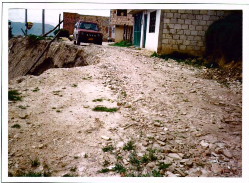
Foto No. 13: Barrio Nueva España. Calle 38 Sur con Cra 12 G. Vía afectada por el deslizamiento. El movimiento se desplaza hacia la vivienda de la parte superior.
